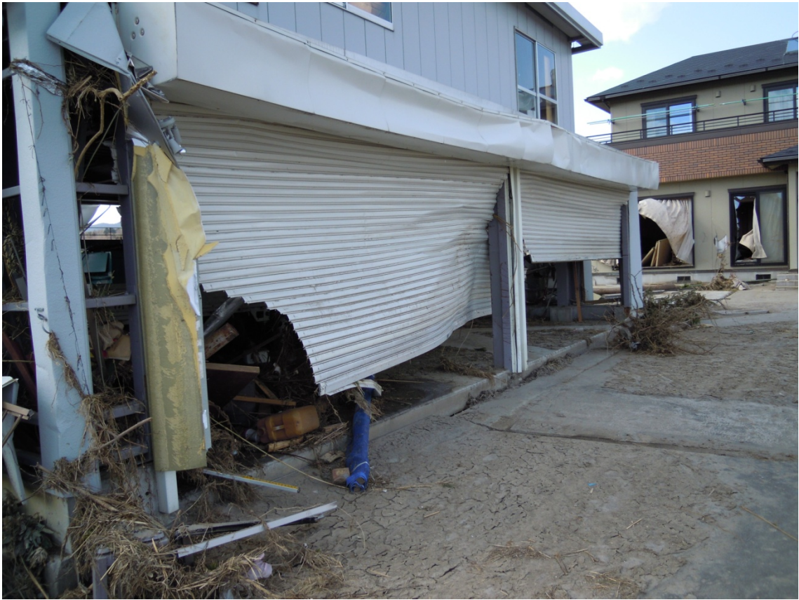
シャッターを破壊して津波が中まで入り込んでいる。
