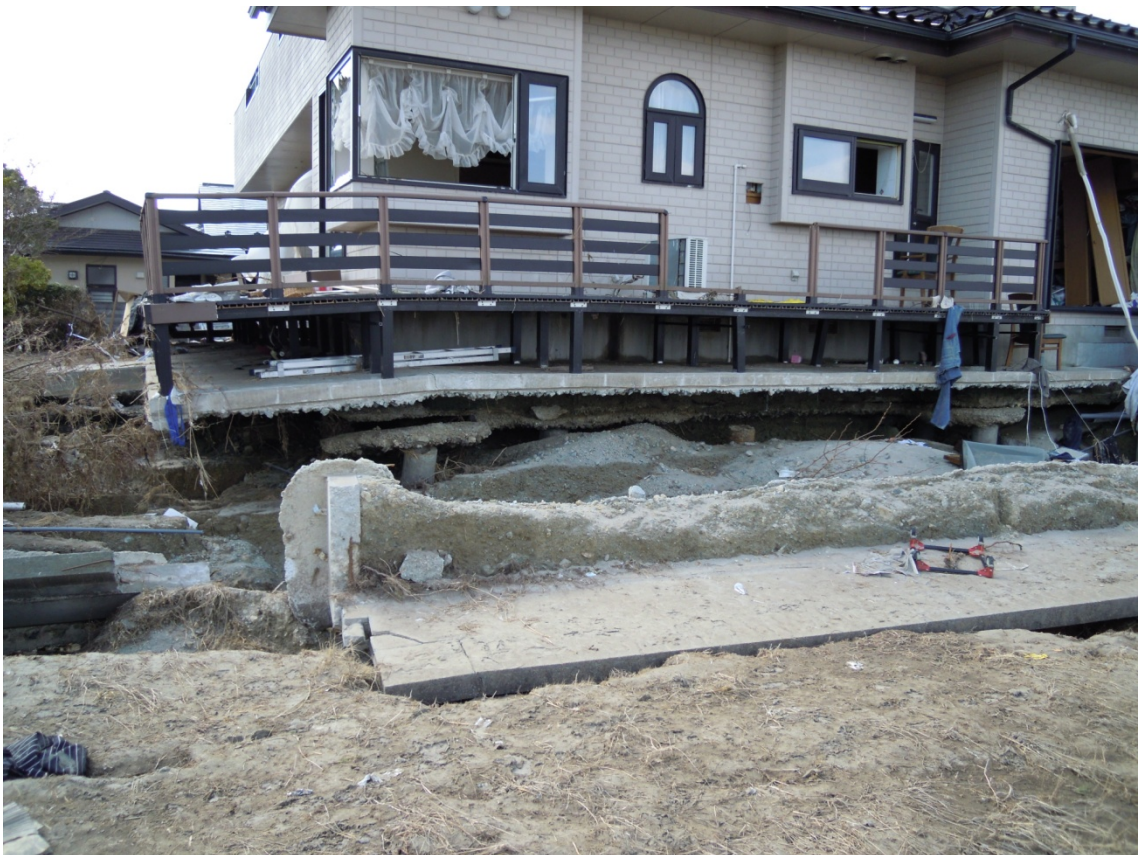
津波によって基礎がむき出しになっているのがわかる。
