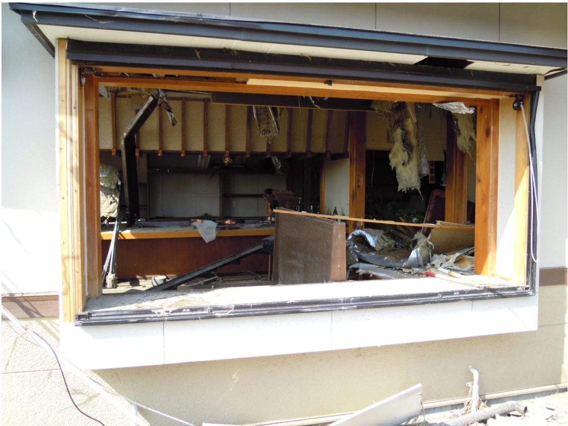
津波が入った1階の室内。家具は何もの残っていない。
