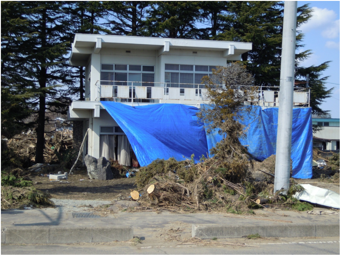
RC造の住宅。津波が1階まで来ているが建っている。
