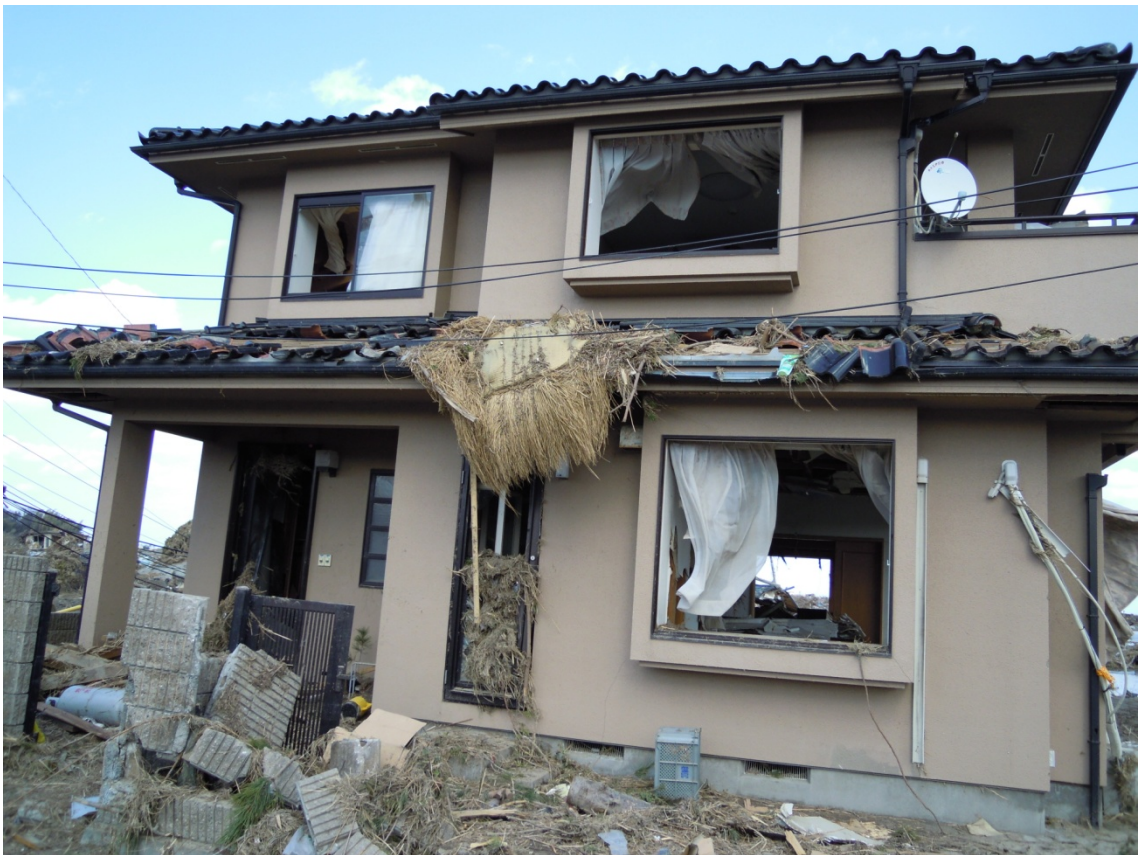
1階の屋根まで津波が来ている。ブロック塀も破壊されている。
