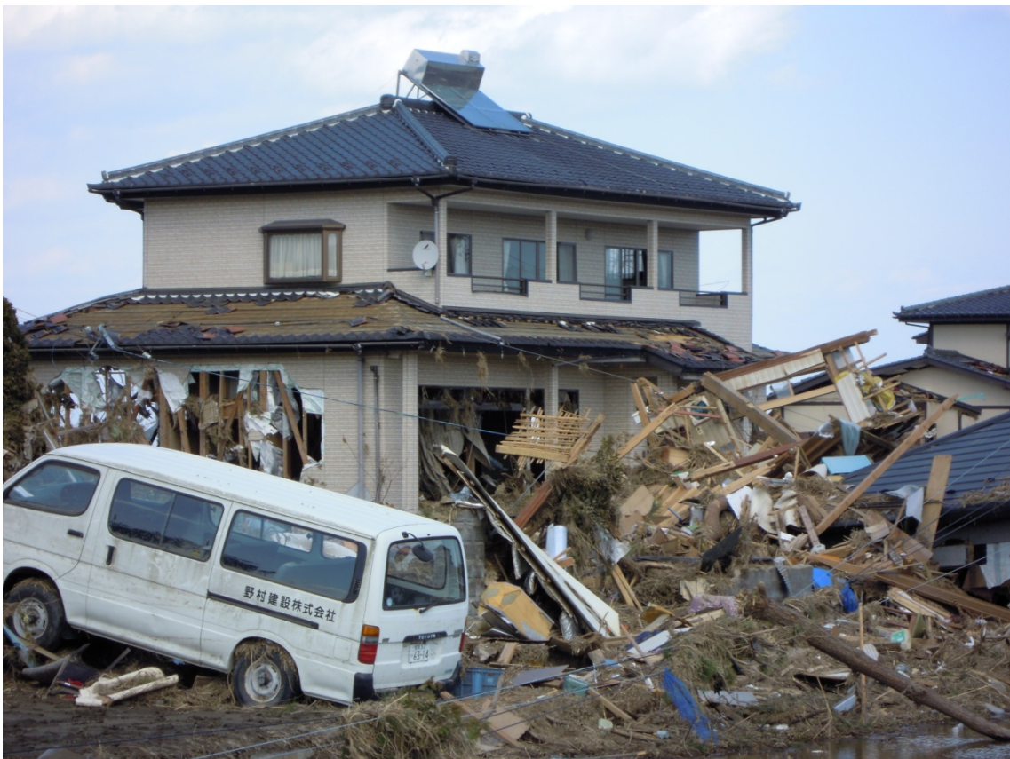
1階に津波が入り、室内は空の状態になっている。
