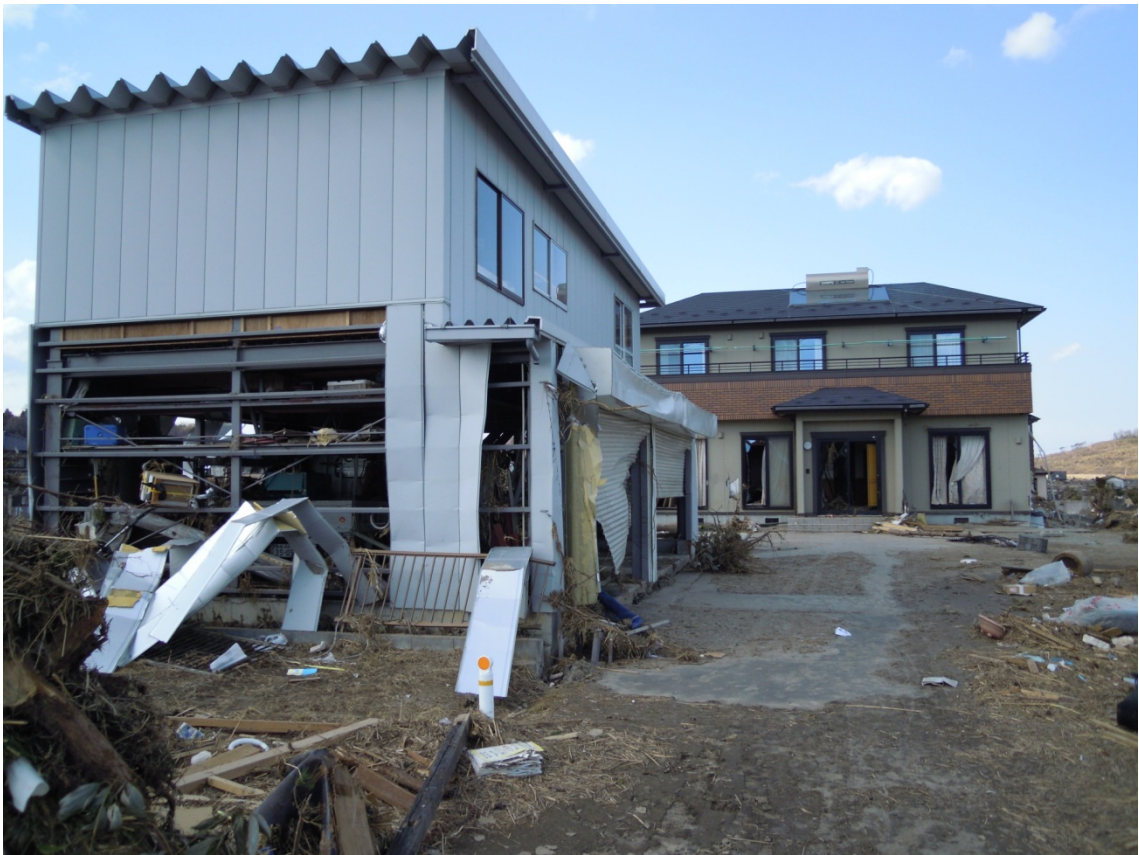
外壁が破れ、1階に津波が入っている。
