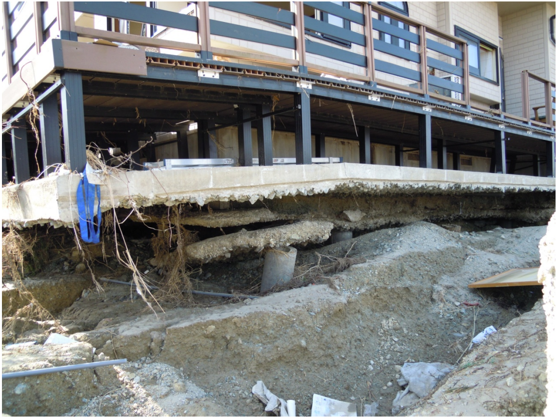
杭基礎を利用している。地盤が悪い。
