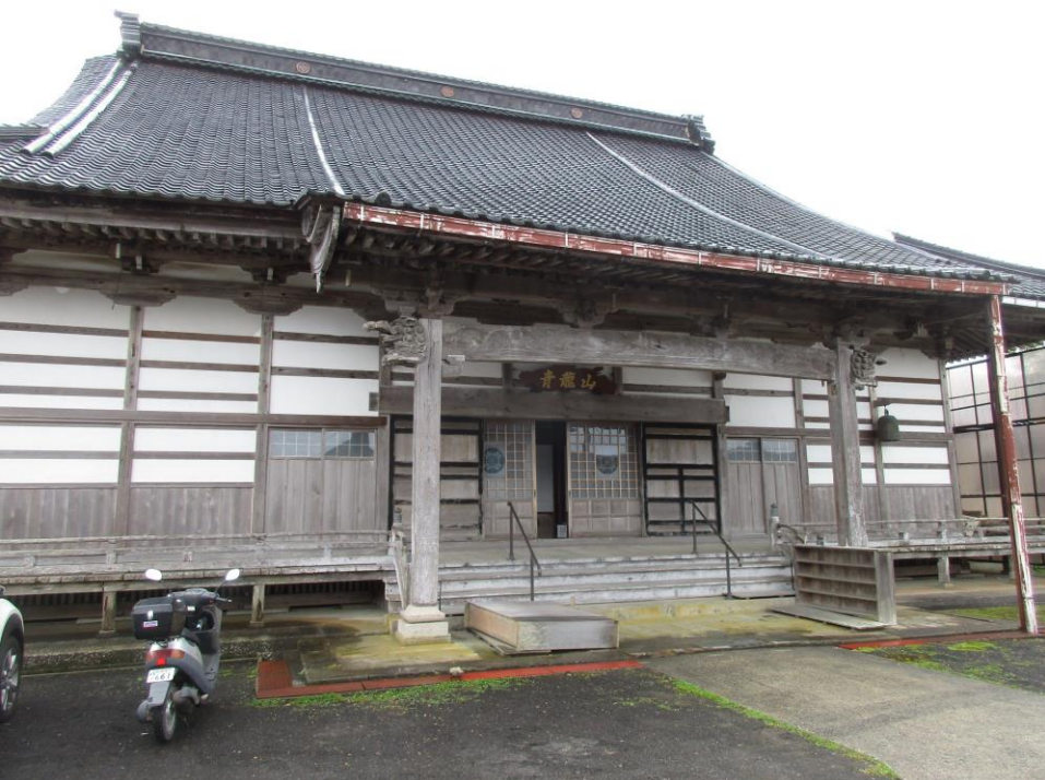
西光寺 珠洲市正院町 張り間（NS）方向に残留変形あり 壁、基礎にひび割れあり
