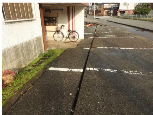
(e) 周辺地盤の変状
