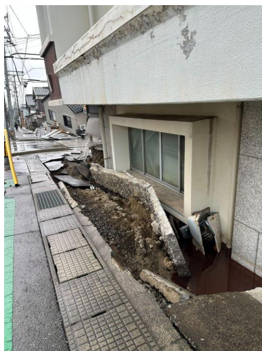
(b) 地盤の変状
