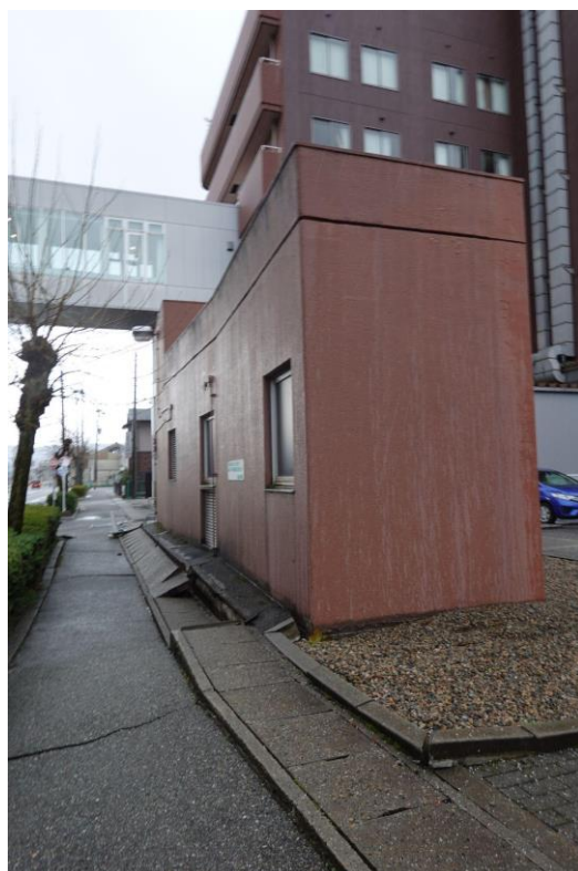
図 4.22 平屋の受電建物（？）の周辺地盤の被害
