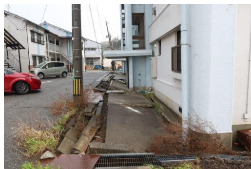
(b) 地盤の変状
