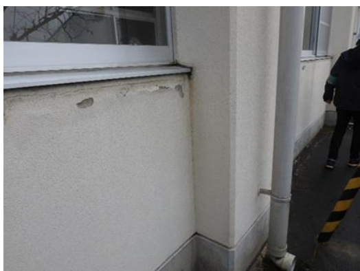
(g) 腰壁のひび割れ
