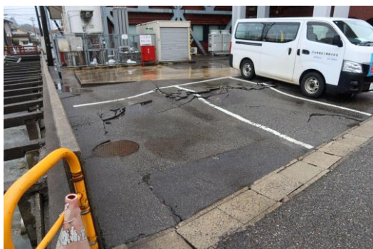
(a) 地盤の損傷
