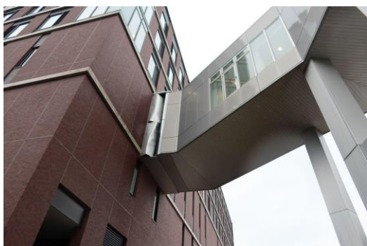
(f) エキスパンションジョイントの損傷
