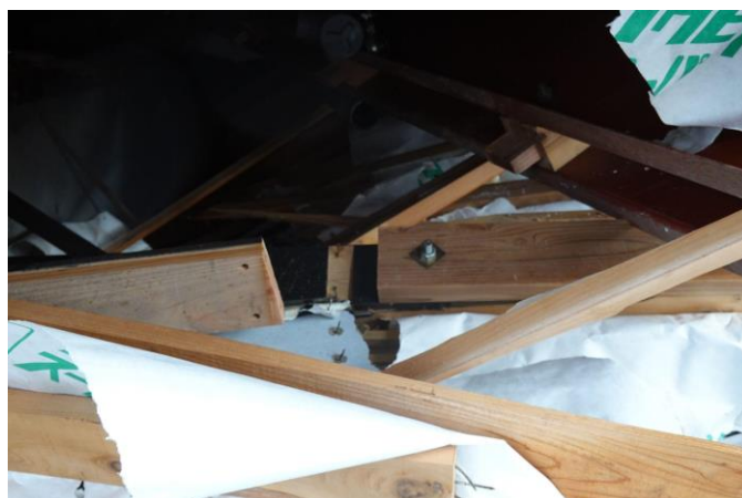
(c) 柱端部には鋼板を挿入している 図 4.9 隣接する倒壊した木造住宅
