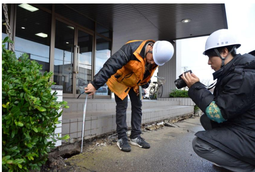
(e) 玄関部の周辺地盤の沈下 (13cm 程度)
