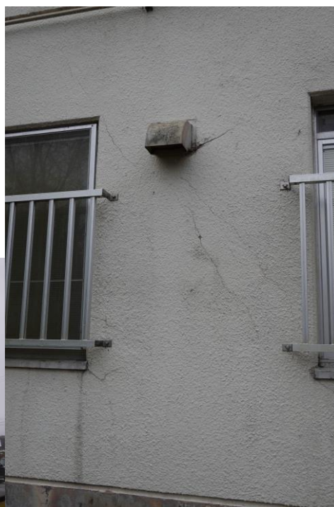
(b) 壁のせん断ひび割れ (古い)
