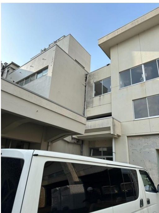
(c) エキスパンションジョイントの損傷
