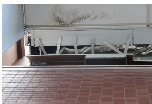
(l) エキスパンション下部の被害（見上げ）
