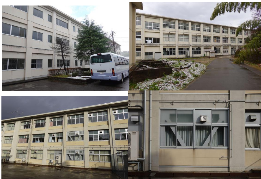
(f) 校舎棟 一部耐震補強されている
