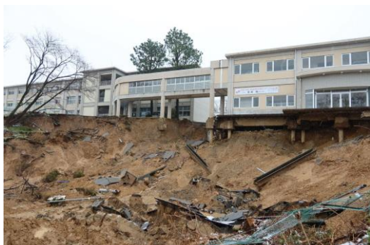
(a) 崩落した地盤
