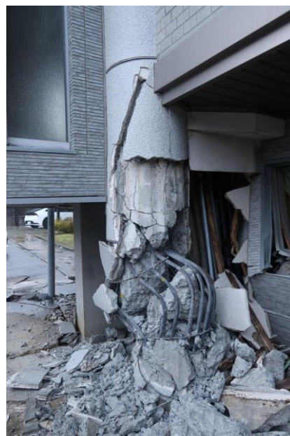
(b) せん断破壊した柱
