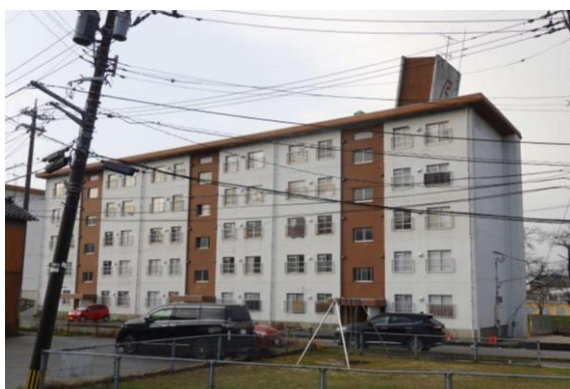
(d) 3号棟全景（高架水槽が傾いている）
