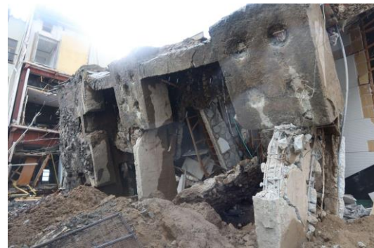
(b) 基礎の被害
