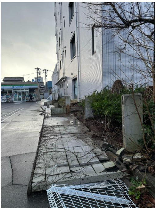
(c) 敷地境界にある倒壊したブロック塀
