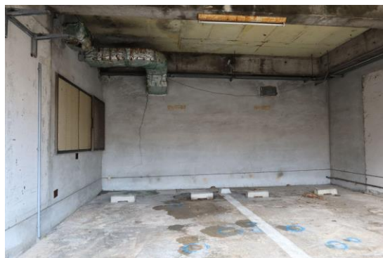
(b) 過去に生じたと思われる部材のひび割れ
