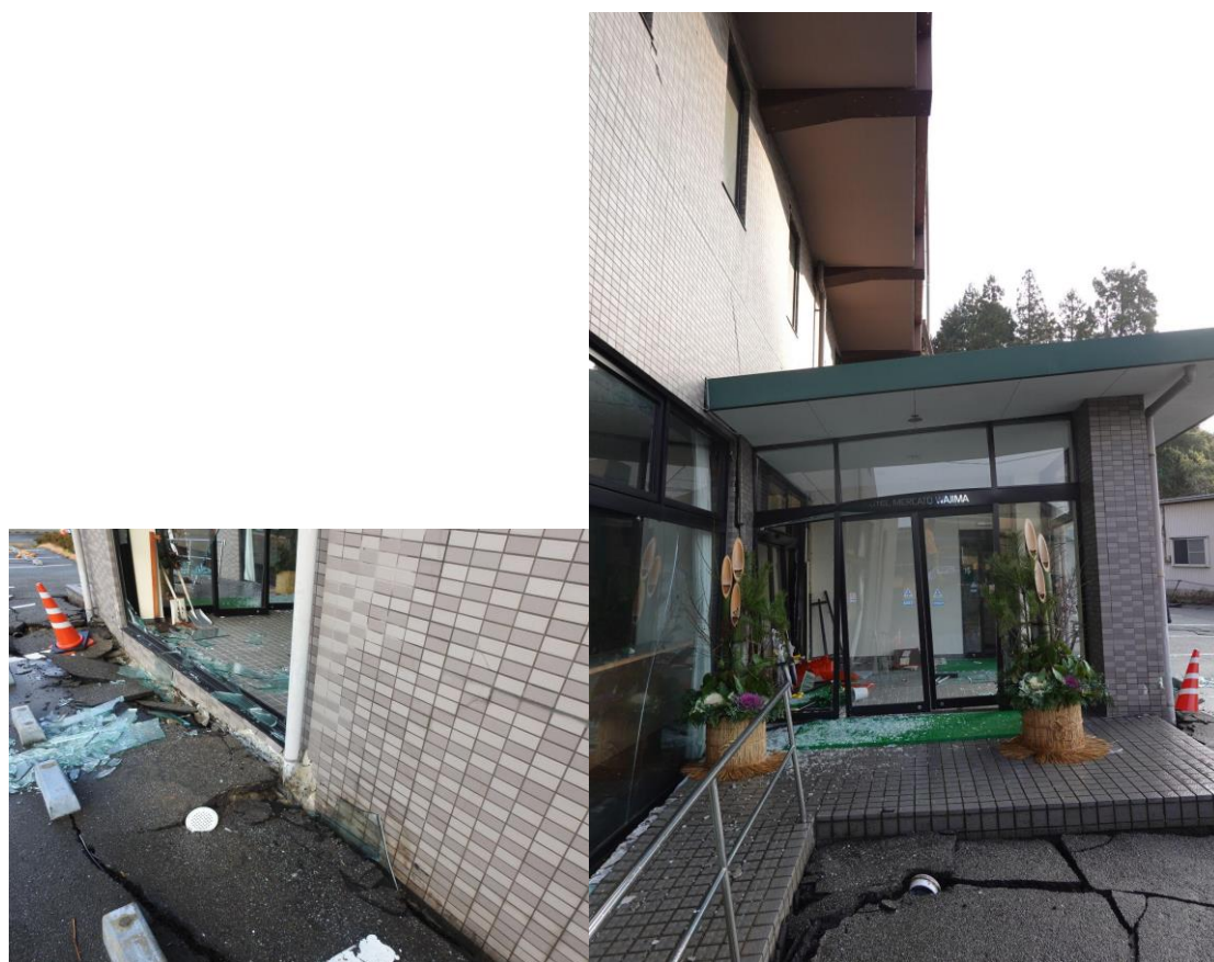
(c) 地盤の変状
