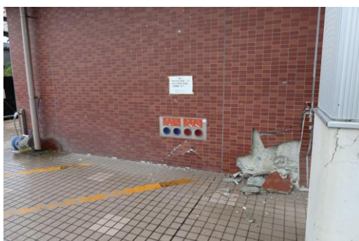
(k) 柱脚・壁脚の損傷
