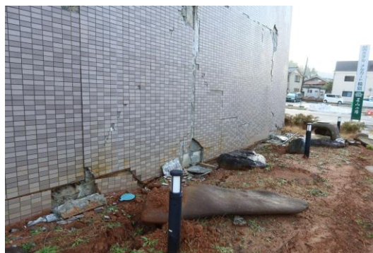
(b) 壁のせん断ひび割れ柱ジョイント部の被害
