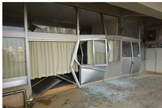
(b) 窓ガラス・サッシの損傷
