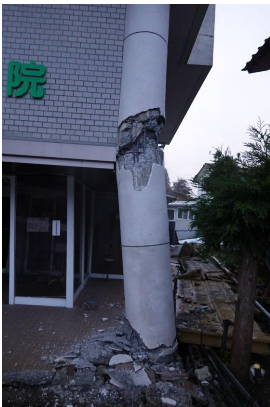
(c) 垂れ壁端部での柱の被害
