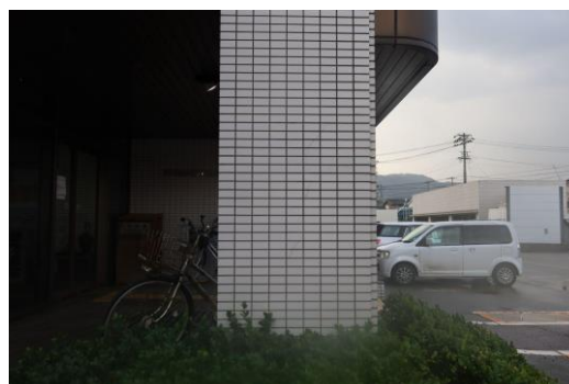
(b) 柱のひび割れ
