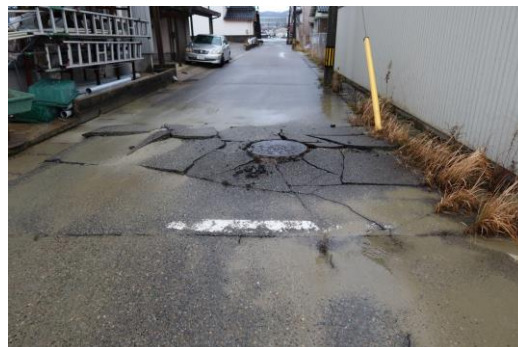
(b) 周辺地盤の損傷
