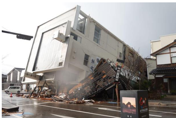
(e) 隣の木造建物側に倒壊
