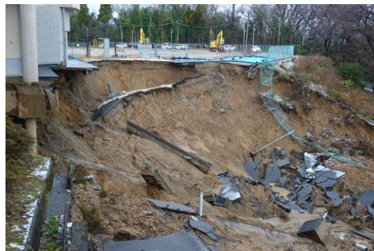
(d) 周辺地盤の崩落状況
