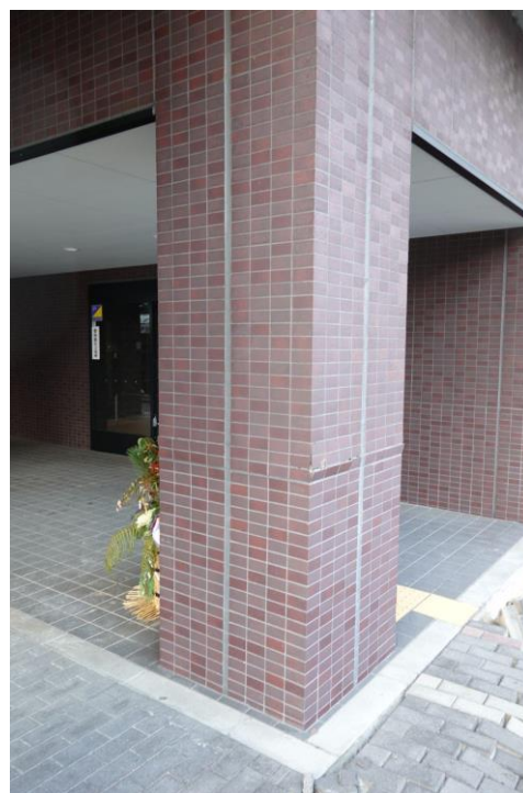
(n) 一階隅柱のタイルの浮き
