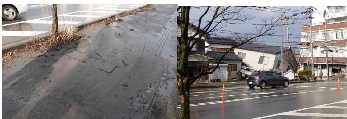
(a) 液状化による噴砂の後 (b) 周辺の転倒木造住宅 図 4.13 周辺の被害
