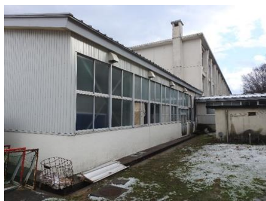
(h) 窓ガラスの損傷
