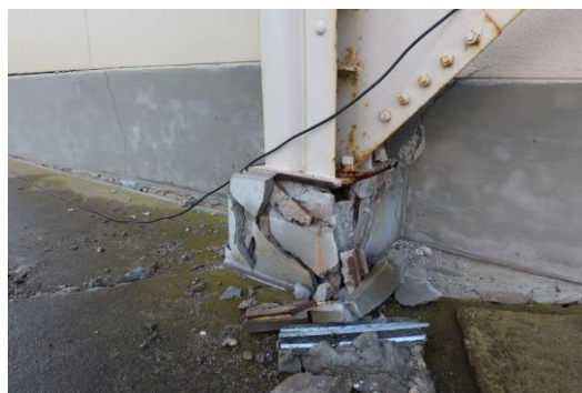
(d) 露出柱脚部における RC 柱の損傷
