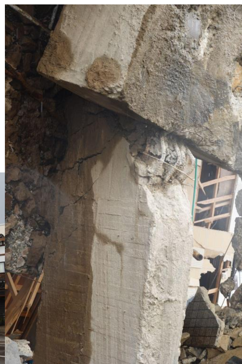
(f) 基礎ばりの被害
