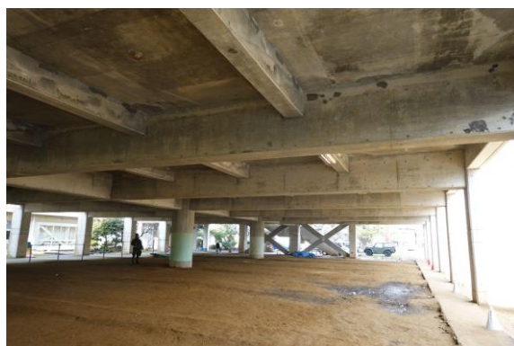
(f) 体育館の一階はほぼ超スパンのピロティ。ブレースは元から 図 4.12 W-8 の被害事例
