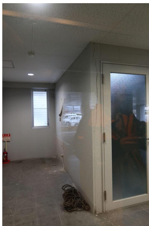
(b) 内装材の被害
