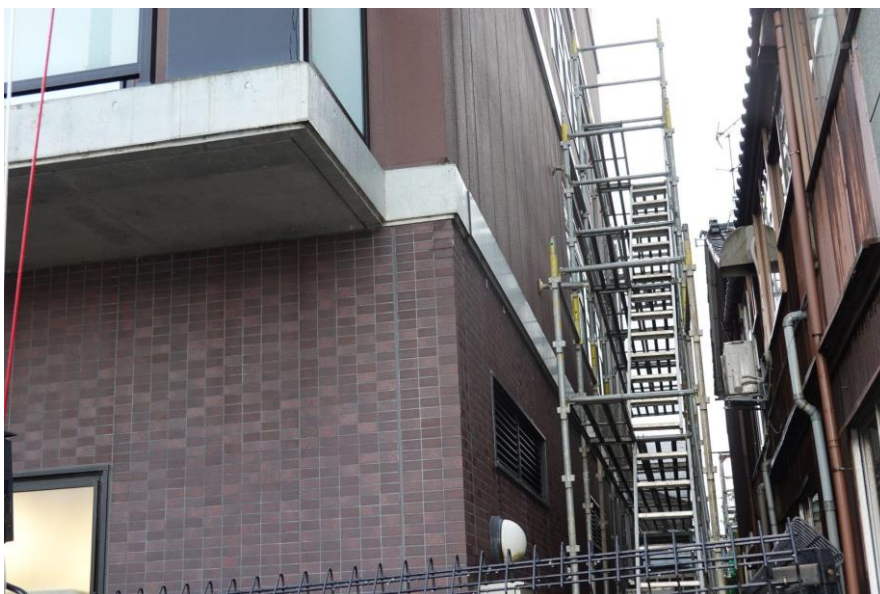
(o) 1階だけRC造なのか、2階スラブ下に全周ひび割れ
