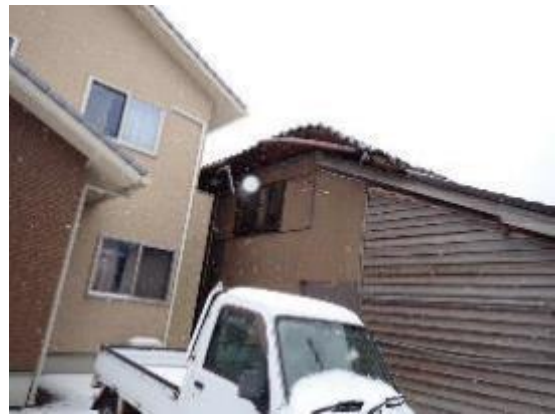
小屋組の破損（同左）
