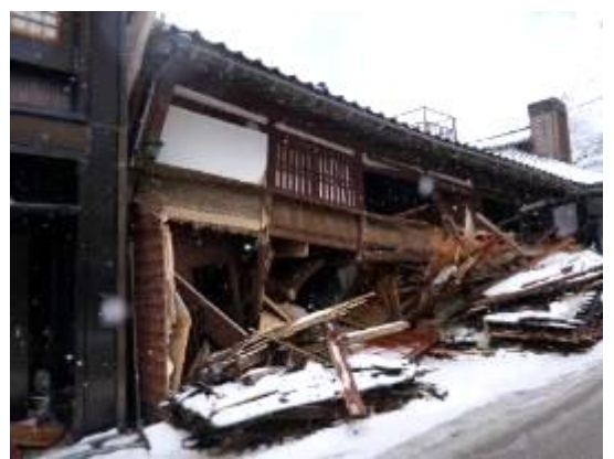
初層崩壊（鳳至町上町）
