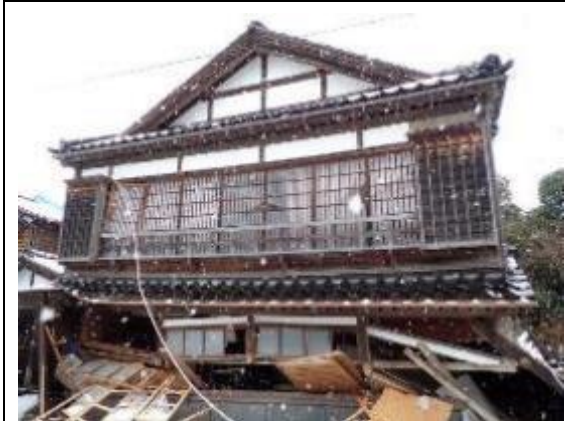
輪島崎・倒壊（初層破壊）
