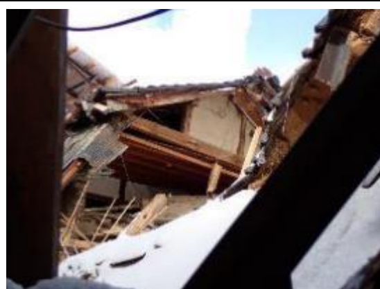
奥の土蔵倒壊（大崎邸）
