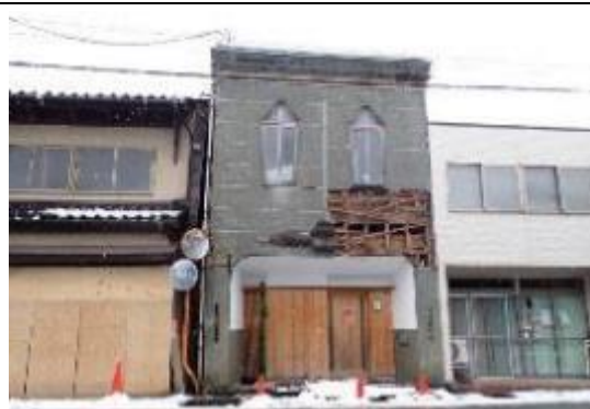
畠田家住宅（旧上野啓文堂）（七尾市街）2階壁剥落、腐朽
