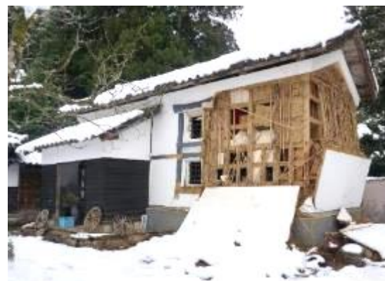
同左。壁崩落、傾斜、クラックなど
