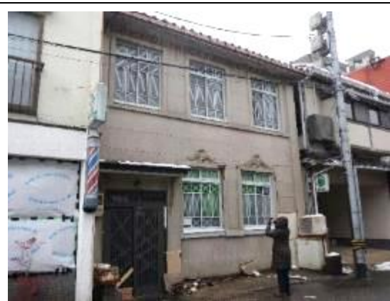
神野家住宅（七尾市街）一部壁剥落
