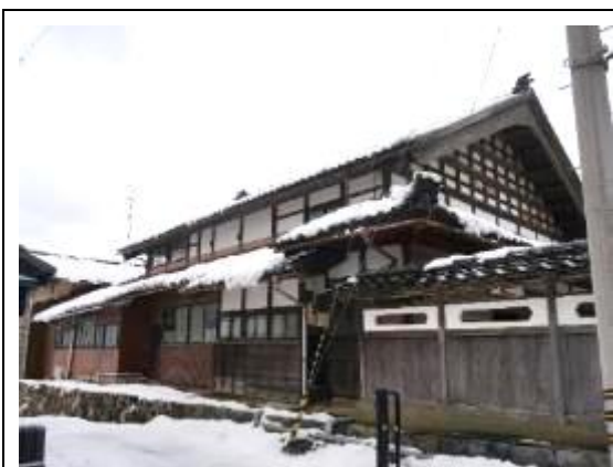
旧丹後家住宅（中能登町）壁仕上げ剥落
