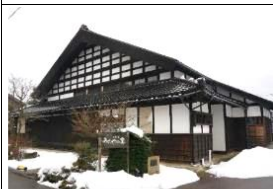
旧稲邑家住宅（中能登町）土壁の仕上剥落
