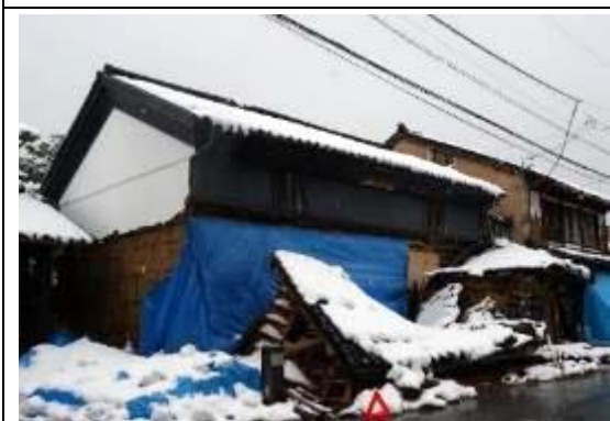
高澤ろうそく店（七尾市街）下屋倒壊。母屋は後方に傾斜。1階東側壁崩落
