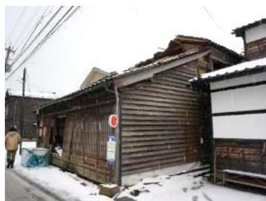
小屋組の破損（鳳至町上町）
