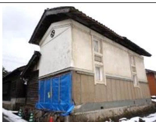
同左。壁崩落、内部ひびあり（聞取り）
