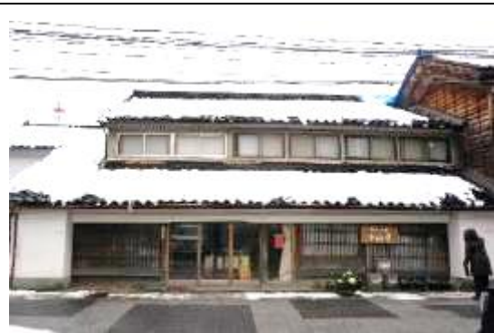
小山屋醤油店（七尾市街）傾斜（地盤変状か）
