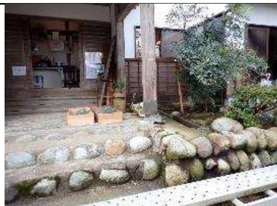
青林寺・客殿（御便殿）・入口柱ずれ
