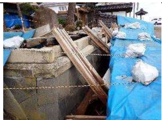
室木家住宅 塀・倒壊
