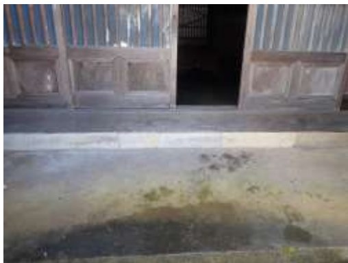
主屋 玄関 石亀裂
