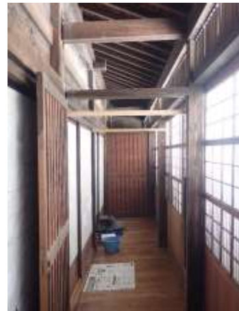
主屋 柱・縁の傾斜 (1/30 以上)
