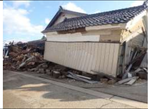
土蔵の倒壊 基礎布石積の崩壊
