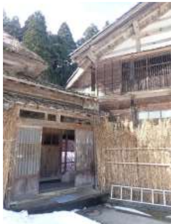
納屋 出隅 2F 部材の脱落
