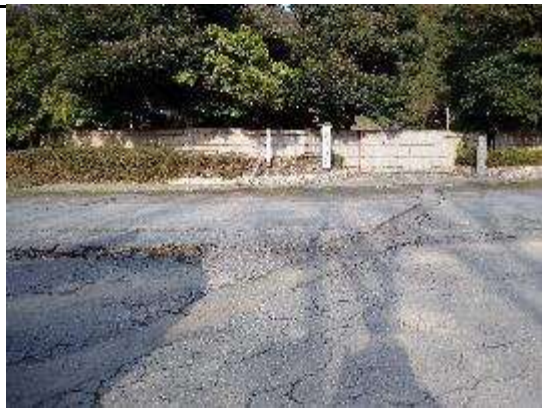
下時国家住宅 閉鎖中。周辺の地割れ
