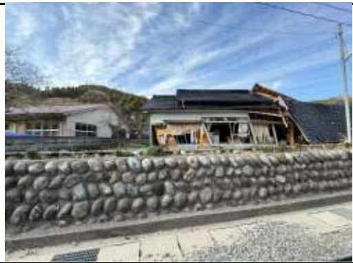
長橋町 海岸付近 木造住宅倒壊
