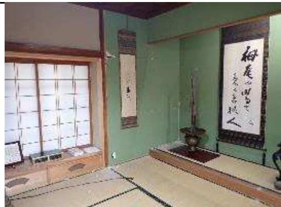
信行寺・庫裏 座敷の壁（木刷漆喰）剥落
