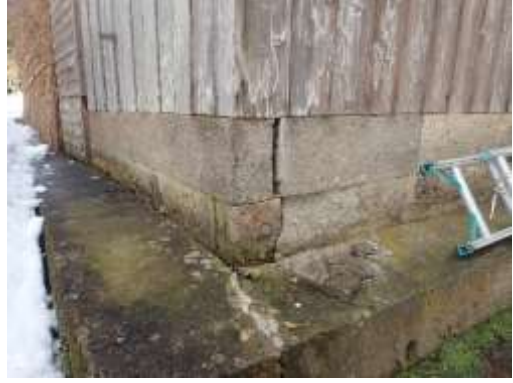
蔵（米蔵） 基礎積石の亀裂
