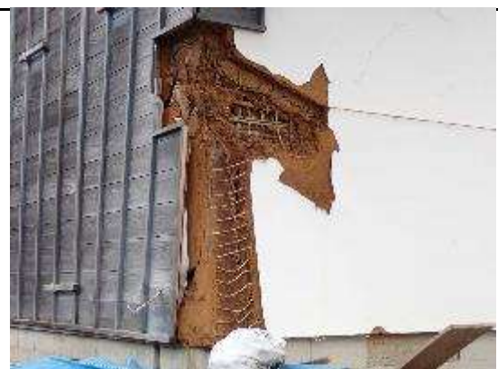
室木家住宅 土蔵・土壁剥落
