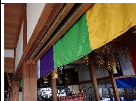
青林寺・本堂、鴨居の脱落
