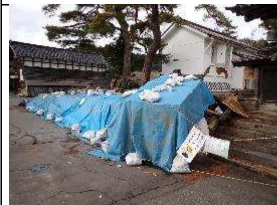
室木家住宅 塀・倒壊
