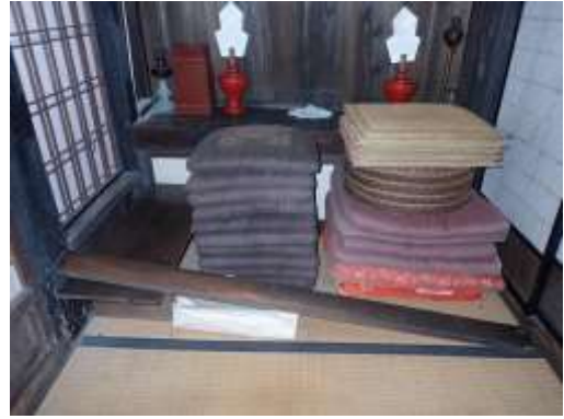
床の間 部材の脱落
