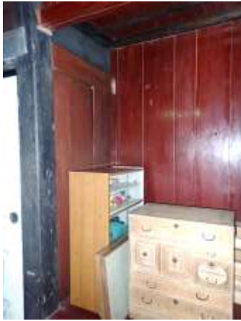
床の間 脇板壁の脱落
