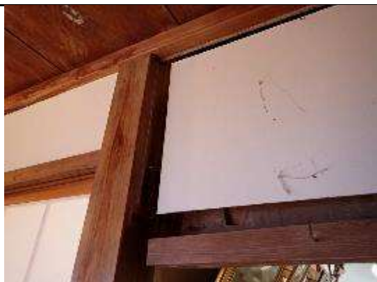
青林寺・客殿（御便殿）壁一か所割れ
