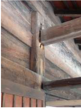
庇梁端部損傷
