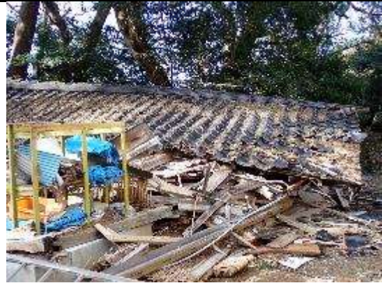
上時国家 倉庫 (?) 倒壊
