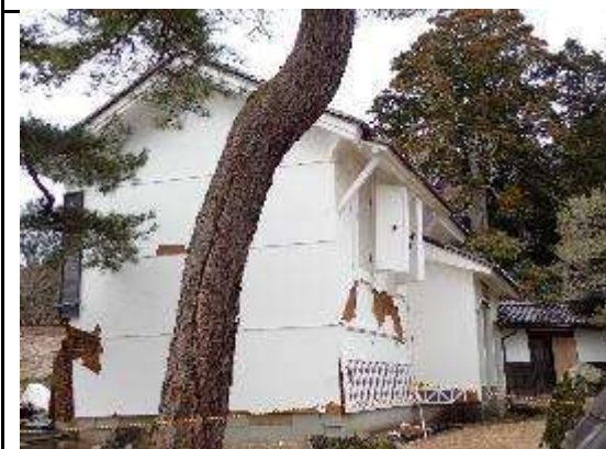
室木家住宅 土蔵・土壁剥落
