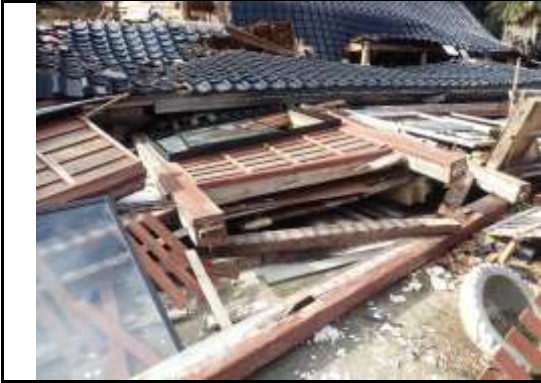
曹源寺 本堂 破損軸組
