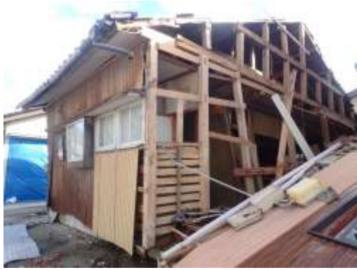
正院町 平屋住宅 外壁・接続棟倒壊
