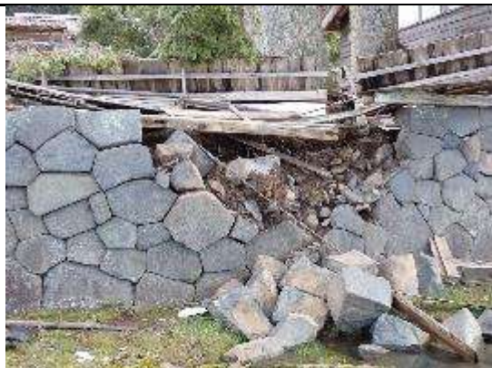
中谷家 石垣の崩落
