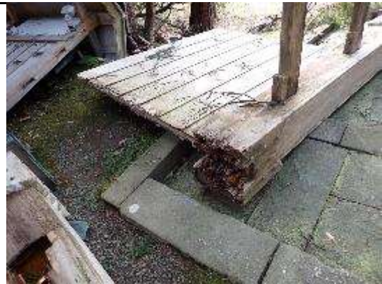
上時国家門柱脚の腐朽
