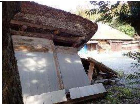
下時国家住宅 手間の建物（納屋）倒壊、奥に見えるのが主屋
