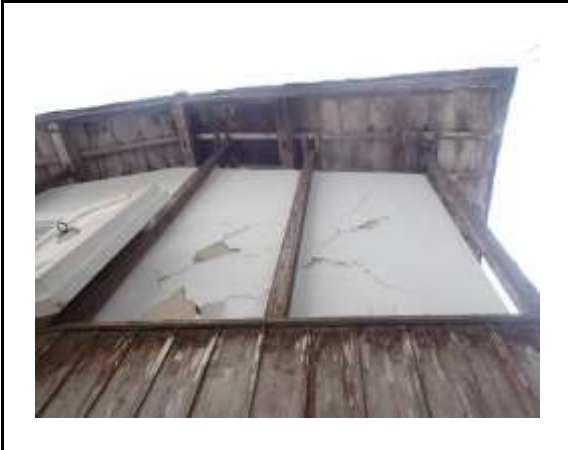
蔵（米蔵） 妻壁土壁せん断亀裂
