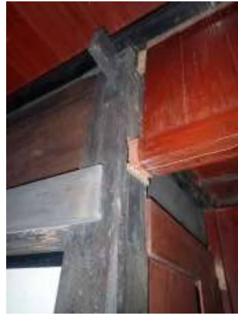
床の間 梁端部損傷
