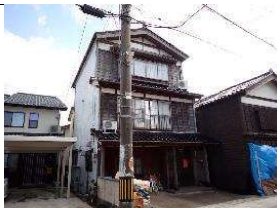
鳳至町・表は伝統構法・脇はサイディング (赤紙は隣接建物の倒壊のおそれ)
