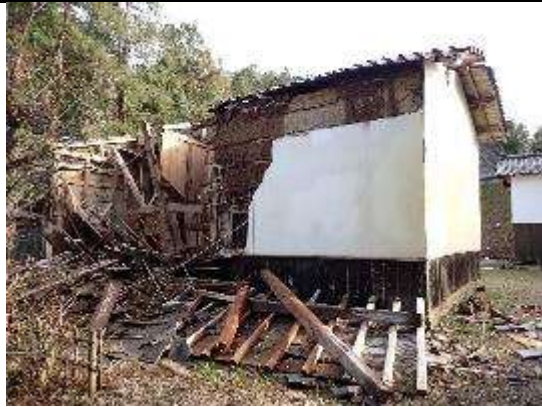
上時国家米蔵：一部崩壊
