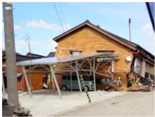
大谷町 住宅1層崩壊
