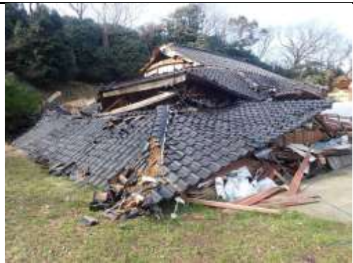
曹源寺 付属建物 倒壊
