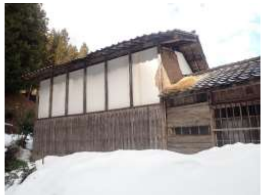
蔵（米蔵） 妻壁の土壁剥落
