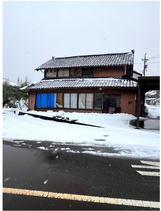
図 4.4.2 木造住宅の被害
