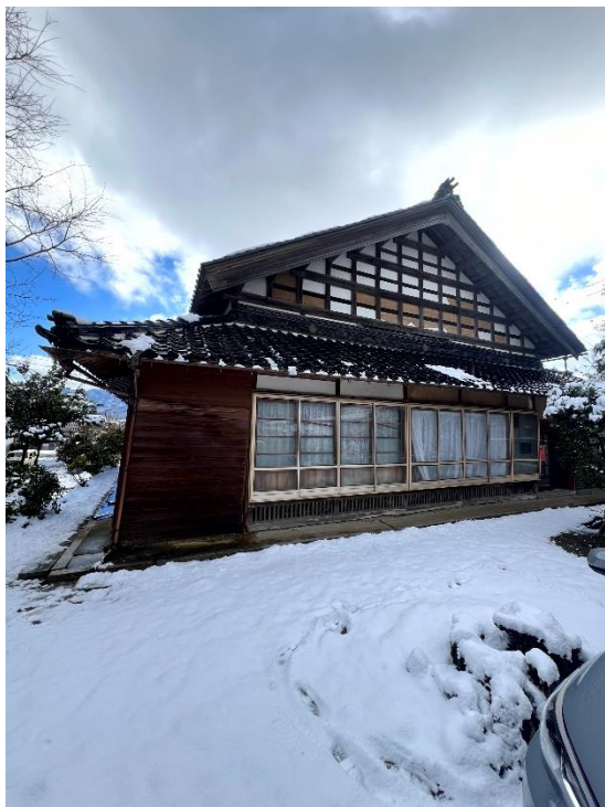
図 4.1.27 木造住宅の被害
