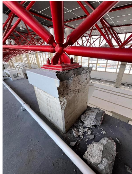
図 4.2.6 立体トラス支承部の被害
