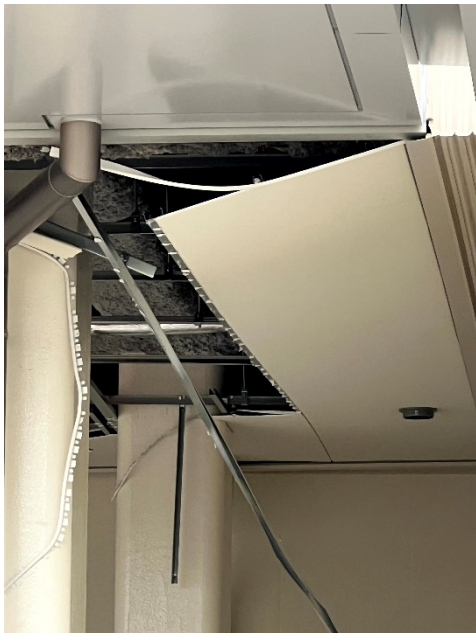
図5. 西側建物とのエキスパンション・ジョイント（Exp. J）と天井パネル
