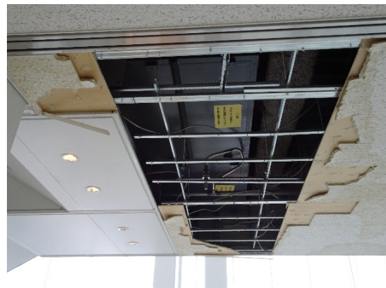
図2 スプリンクラーの水漏れによる天井落下
