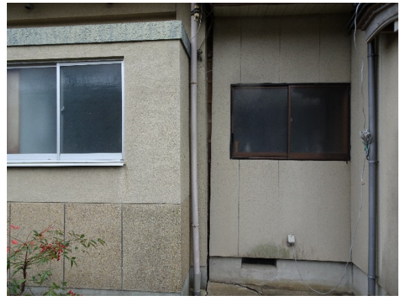
図 20. 不同沈下による住宅の傾斜（北潟）
