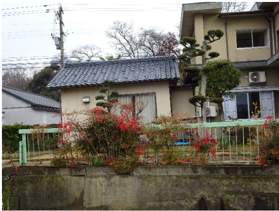
図 19. 液状化による住宅の不同沈下（北潟）
