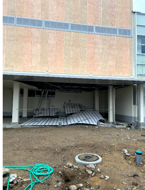
図4. 北西の天井落下
