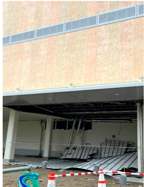
図6. 北東側の天井パネル落下
