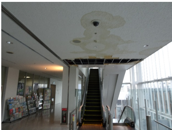
図1. 5階エスカレータ付近の天井落下
