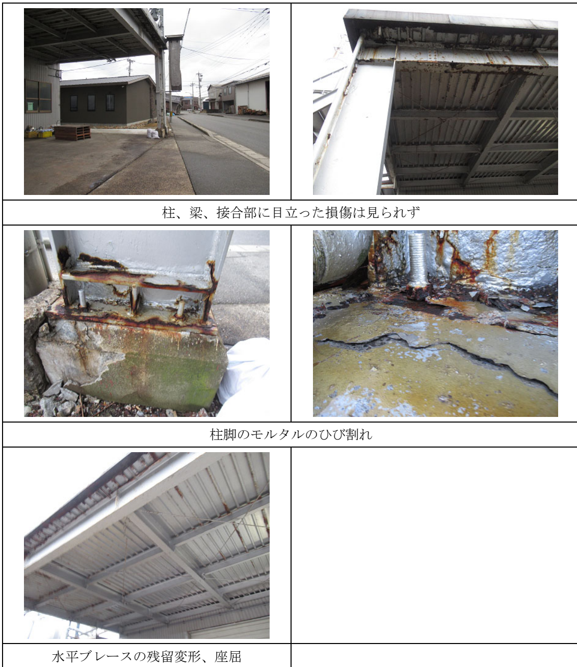
図 4-6-3 輪島市内の工場（鉄骨造）の様子
