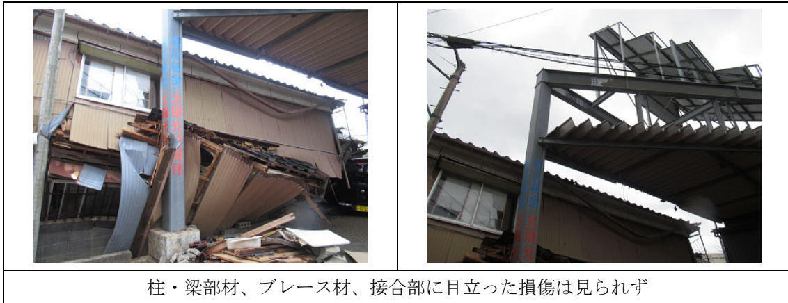
図 4-6-5 輪島市内のオフィス・倉庫（鉄骨造）の様子
