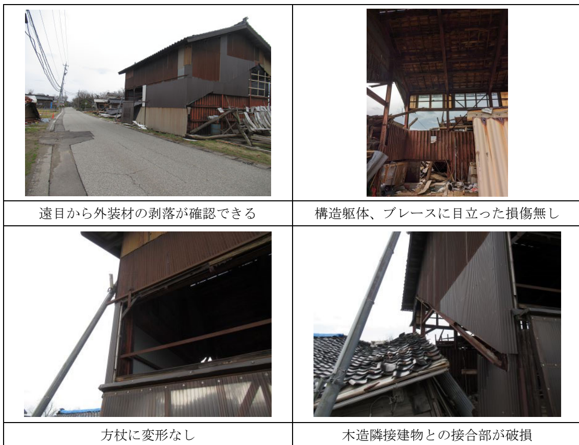
図 4-3-6 珠洲市内の工場・倉庫（鉄骨造）の様子
