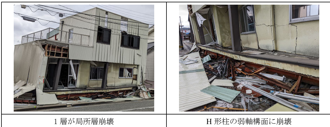
図 4-6-6 輪島市内の店舗（鉄骨造）の様子
