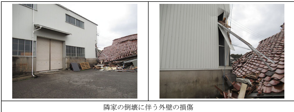
図 4-6-1 輪島市内の工場（鉄骨造）の様子
