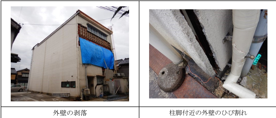
図 4-6-10 輪島市内の店舗・オフィスビル（鉄骨造）の様子
