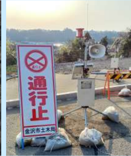
伸縮計に異常があれば近隣に警報が発せられる
