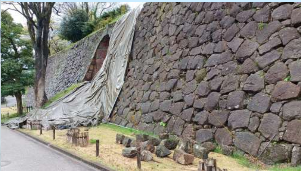
旧陸軍のレンガ造りのトンネル脇の石垣崩壊現場
