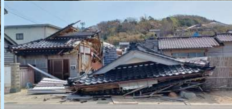
黒島の集落には地震で倒壊した住家が至る所に見られる
