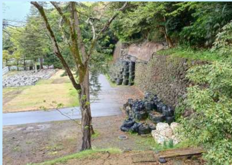
鼠多門近くの石垣崩壊
