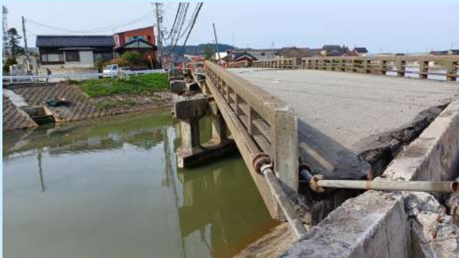
宝立町鶴飼橋の破壊によって県道は通行止めに
