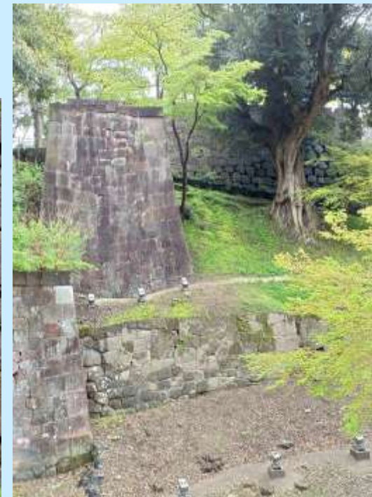
色紙短冊積石垣（前倒れ被害あり）
