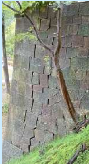
裏手から見た色紙短冊積石垣の被害
