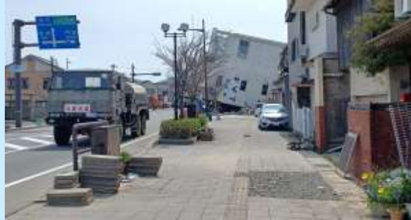
焼失を逃れた輪島市街の木造住宅には多くの全壊家屋が散見される
