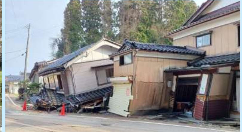
珠洲市役所周辺の木造住家の被害
