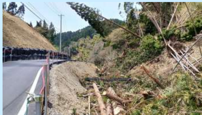
至る所に見られる迂回路途上の斜面崩壊
