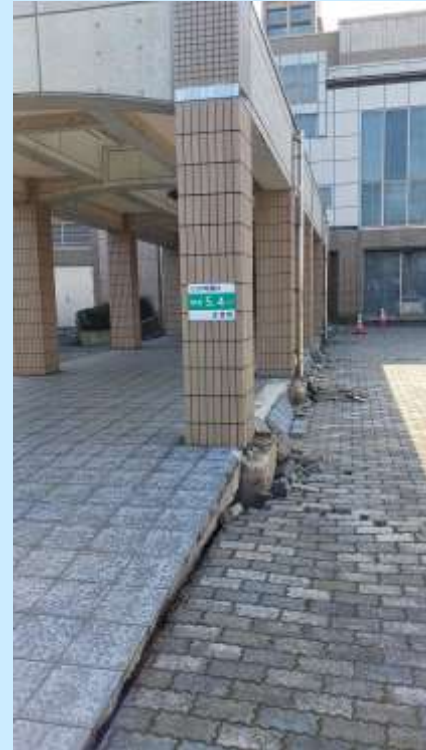
町役場の被災状況
