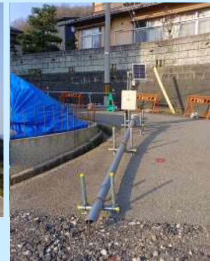
簡易伸縮計を用いた造成地の監視がおこなわれている
