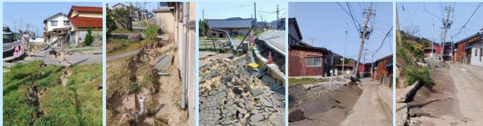
带状に分布する内灘町の集落は一樣に緩い砂地盤の液状化と側方流動によって砂丘と反対方向に押し流されている
