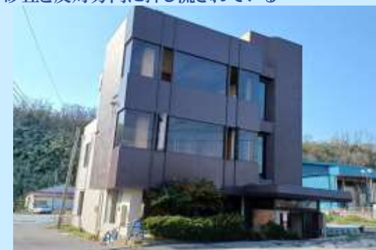
不同沈下を生じた立正佼成会ビル
