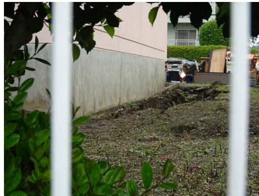
Fig.2 特徴的な建物周辺地盤の亀裂
