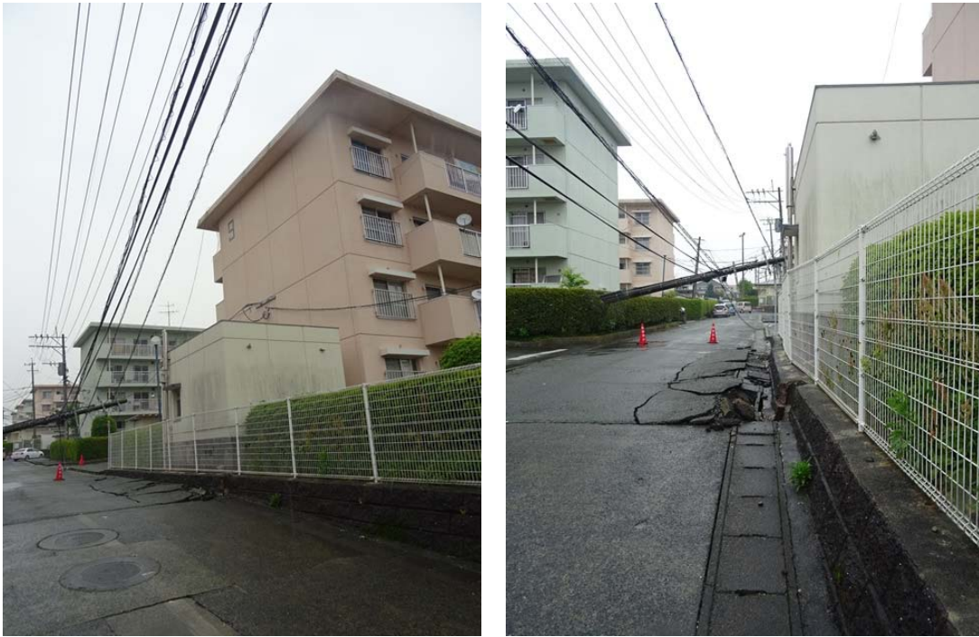
Fig.4 建物9棟の西側路盤の被害状況
