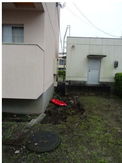
Fig.3 建物 9 棟の西側の被害状況
