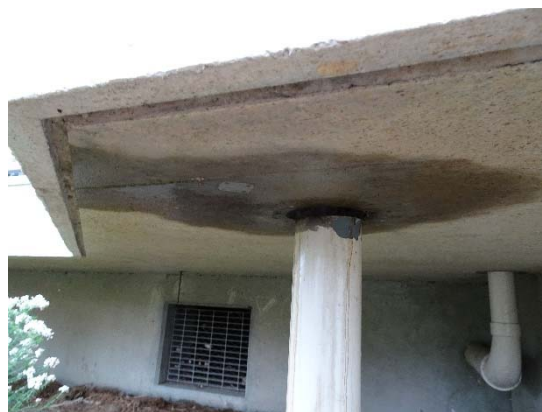
Fig.12 配管のずれ (2棟のバルコニー下部)
