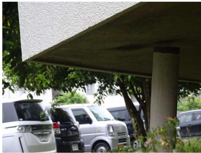
Fig.5 団地B（宇土市）の建物における雨水配管の損傷
