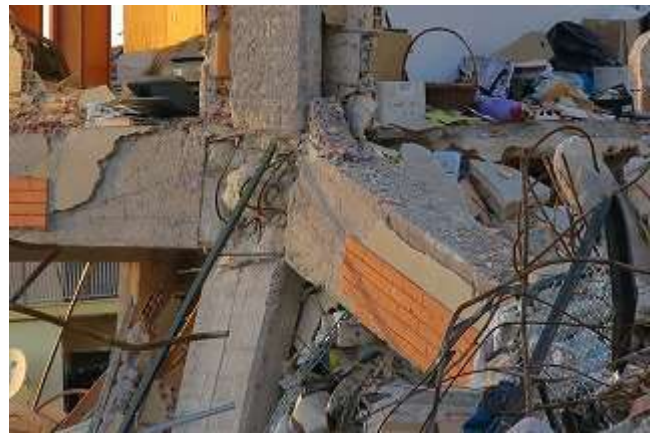
写真 5-30 RC 造建物の被害
