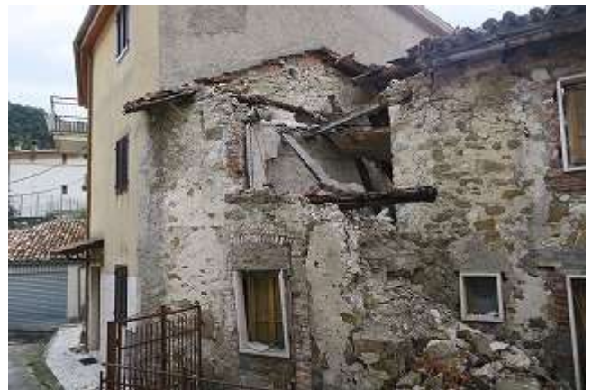
写真 7-14 組積造の被害
