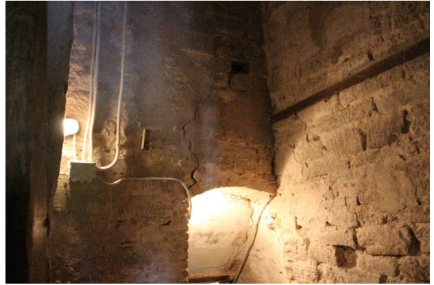
写真 8-16 壁のひび割れ
