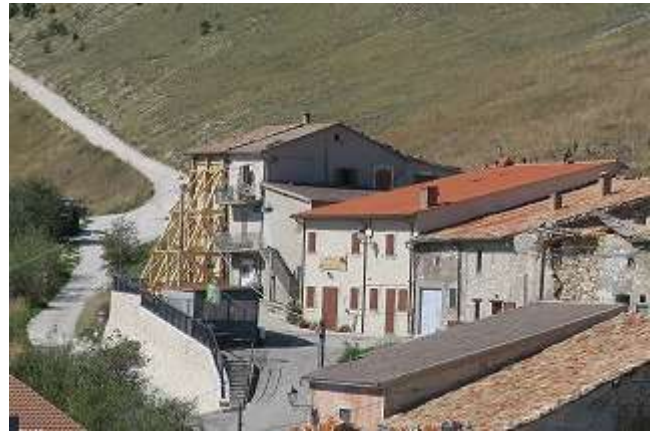
写真 5-6 カステッルッチョの建物被害と応急処置
