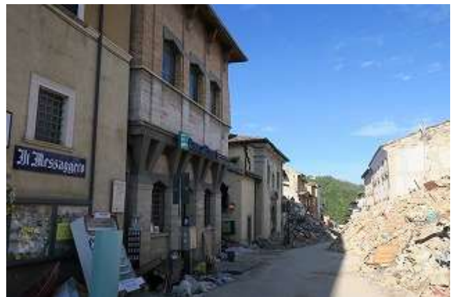
写真 6-12 組積造建物の被害
