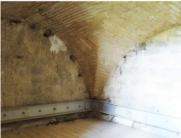
写真 8-17 壁のひび割れ
