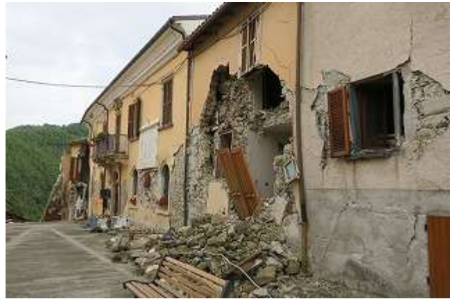
写真 7-8 組積造の被害 (面外方向)
