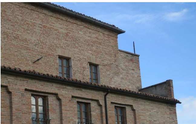
写真 7-43 教会外部の壁のひび割れ
