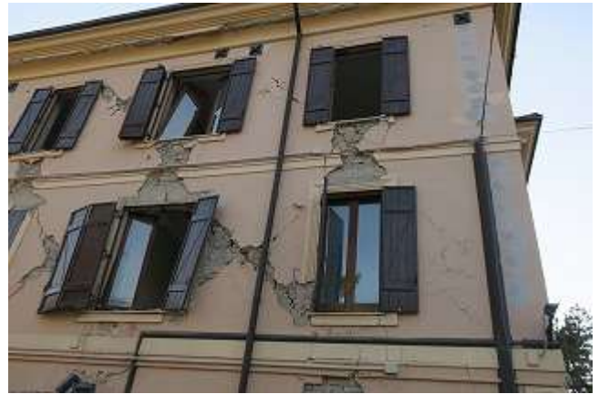
写真 5-20 RC 造建物の被害
