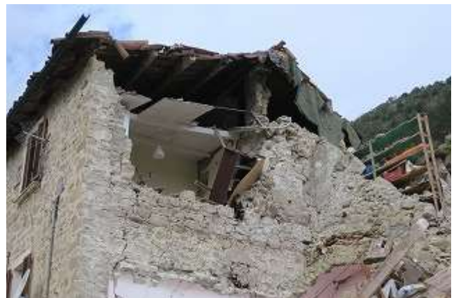
写真 7-24 組積造の被害
