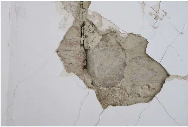
写真 7-51 博物館の壁の損傷
