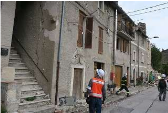
写真 7-35 組積造の被害
