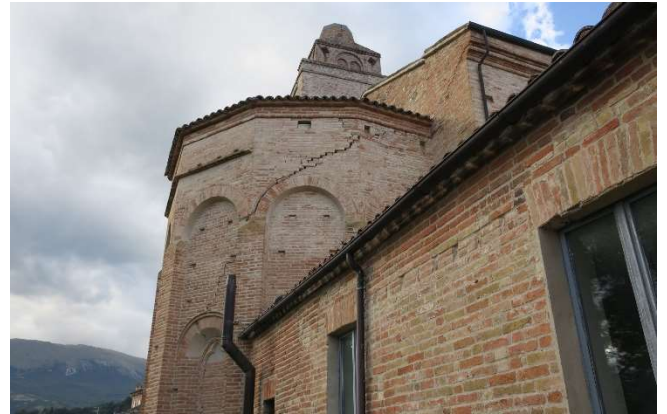
写真 7-48 教会外部のひび割れ
