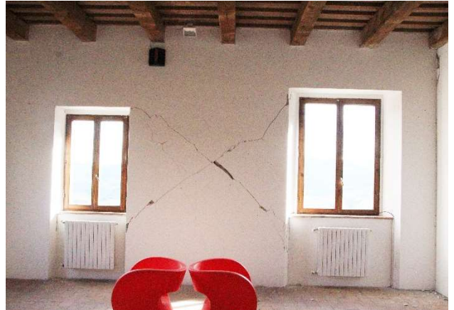
写真 7-52 博物館の間壁のひび割れ
