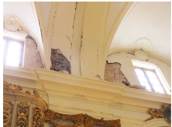
写真 7-40 教会内部の壁の損傷
