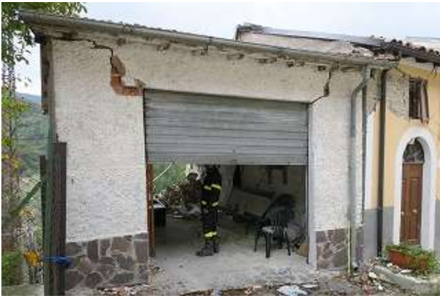
写真 7-25 組積造の被害 (RC 梁)
