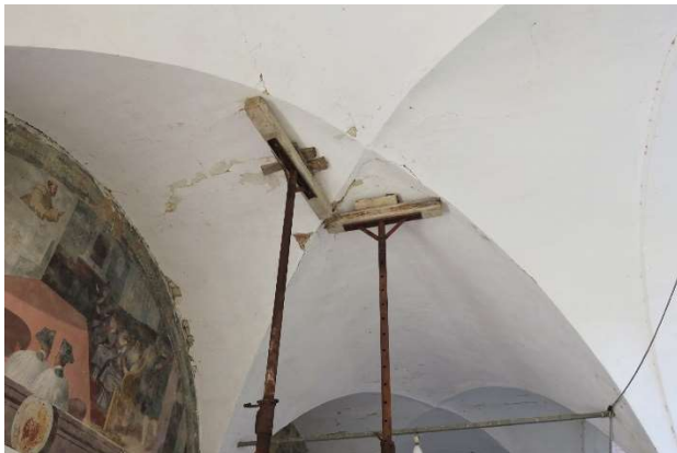
写真 7-49 回廊の天井のひび割れ
