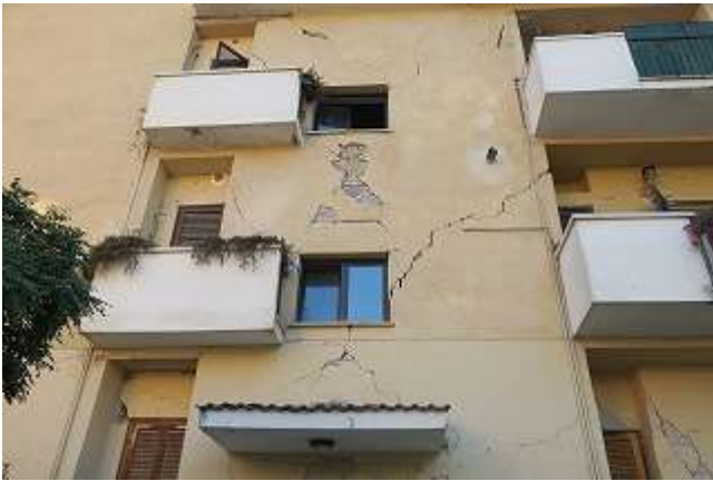
写真 5-19 RC 造建物の被害
