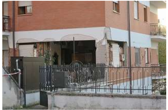
写真 5-28 RC 造建物の被害
