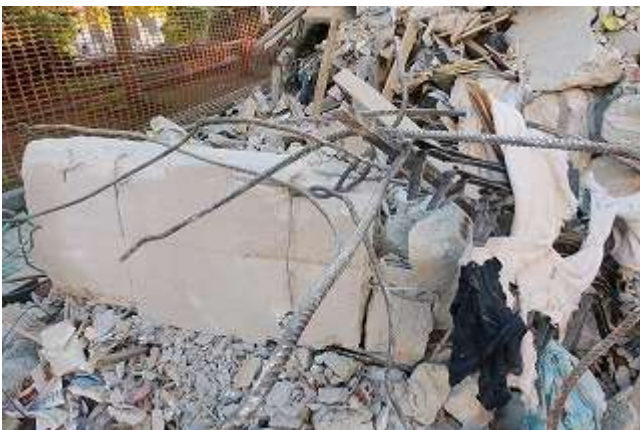
写真 5-23 RC 造建物の被害
