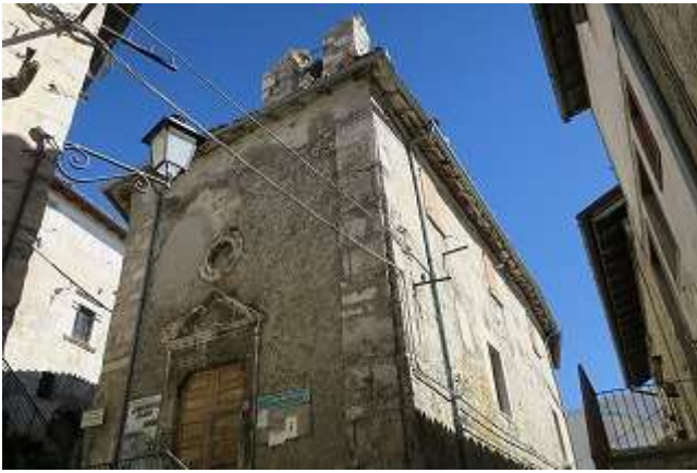
写真 5-3 小礼拝堂の被害
