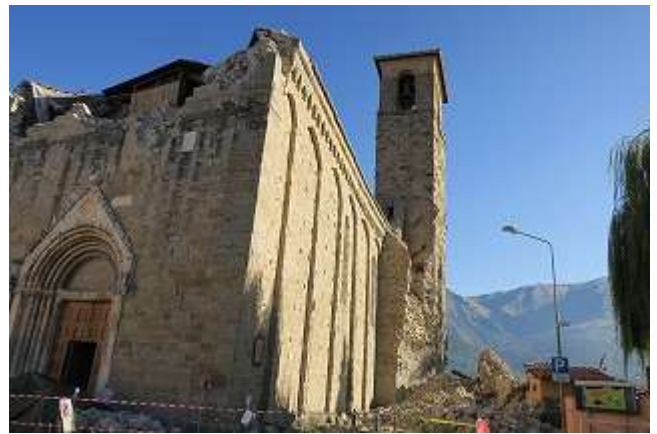
写真 6-16 Sant'Agostino 教会堂の被害
