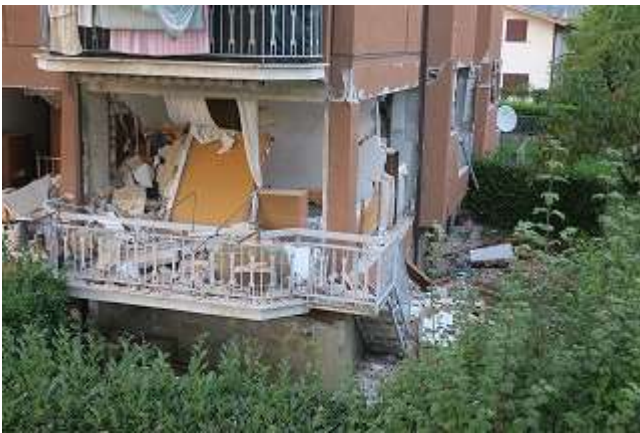
写真 5-37 RC 造建物の被害
