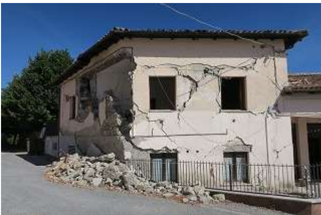
写真 6-23 組積造建物の被害
