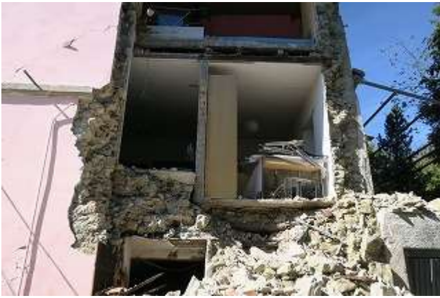
写真 6-25 組積造建物の被害
