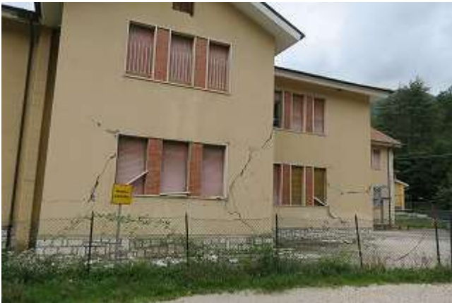
写真 7-19 中学校の被害（せん断）
