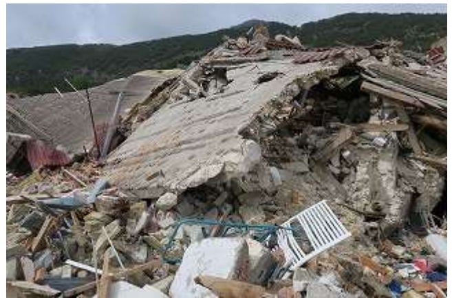
写真 7-30 組積造の被害
