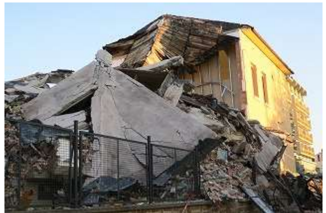
写真 5-16 RC 造建物の被害
