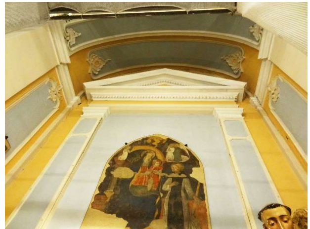
写真 8-2 壁際のひび割れ
