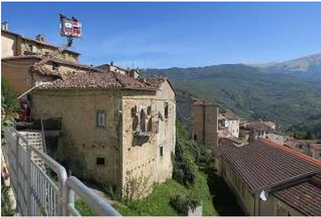
写真 6-27 組積造建物の被害
