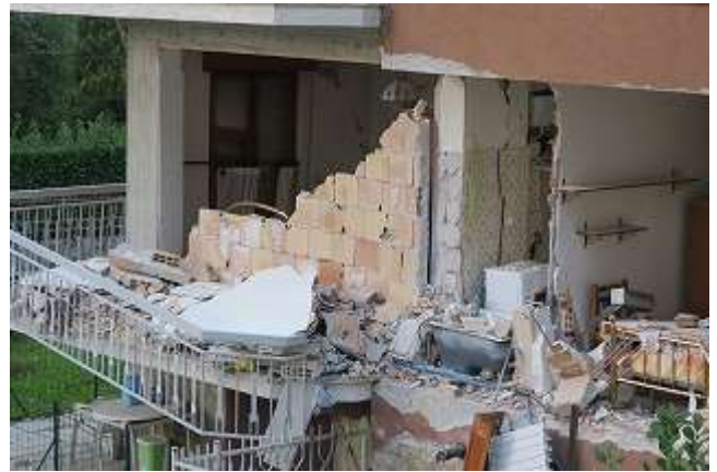
写真 5-36 RC 造建物の被害
