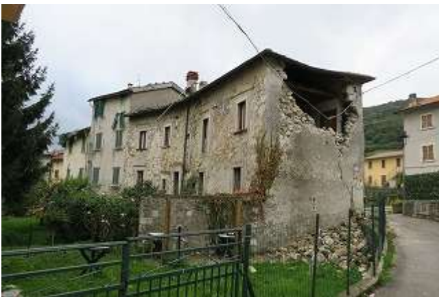
写真 7-13 組積造の被害(面外方向)
