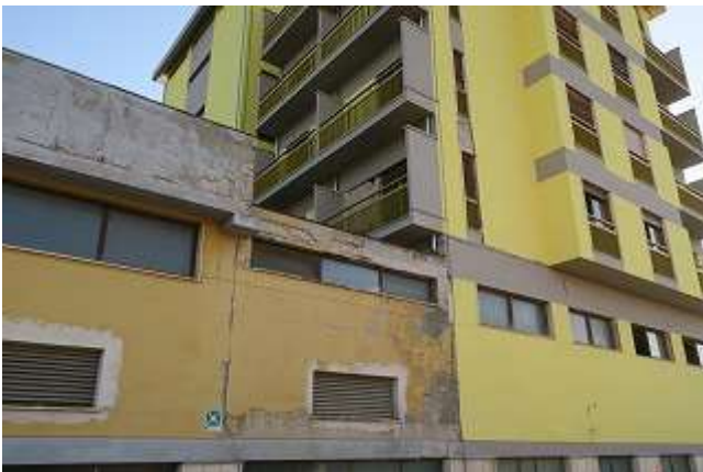
写真 5-15 RC 造建物の被害
