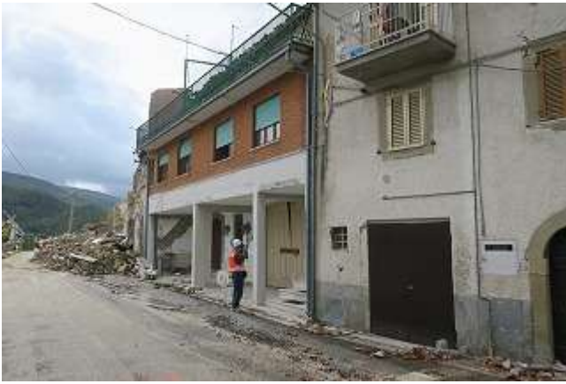
写真 7-33 RC 造の被害
