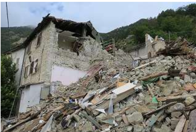
写真 7-23 組積造の被害
