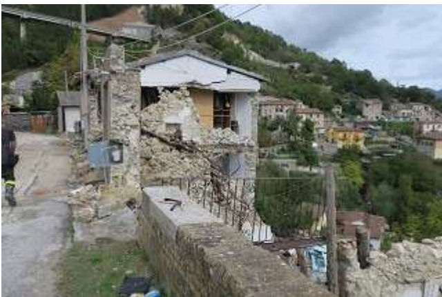
写真 7-31 組積造の被害
