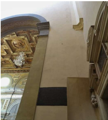
写真 8-7 壁のひび割れ
