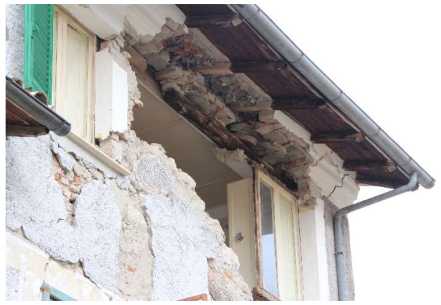
写真 7-16 組積造の被害
