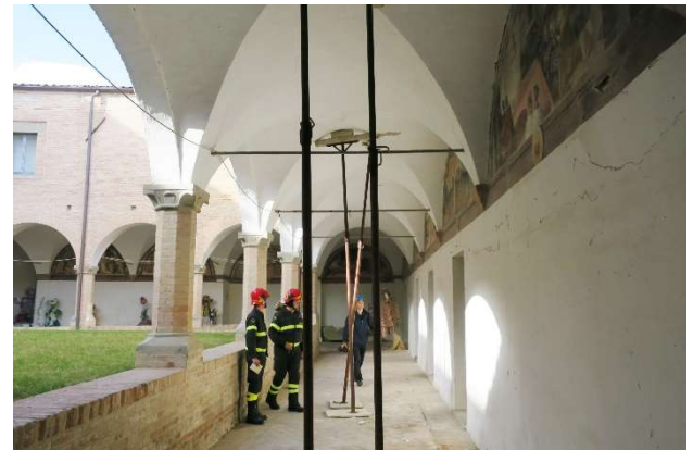
写真 7-50 回廊の壁のひび割れ
