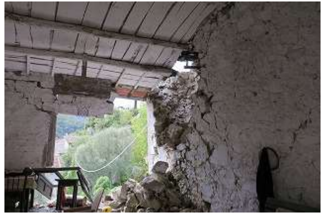
写真 7-26 組積造の被害
