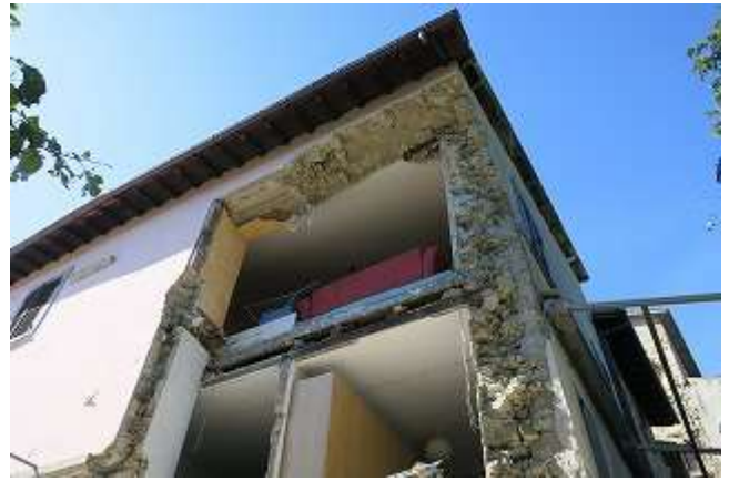
写真 6-26 組積造建物の被害
