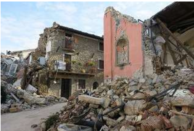
写真 6-9 組積造建物の被害
