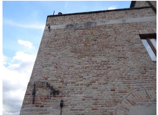
写真 7-42 教会外部の壁のひび割れ
