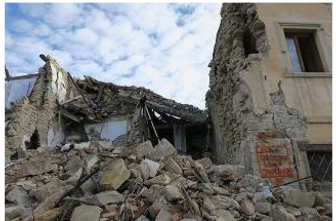
写真 6-2 組積造建物の被害
