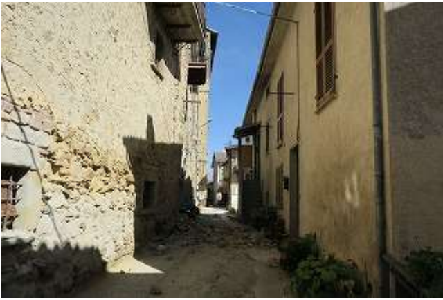
写真 6-17 組積造建物の被害
