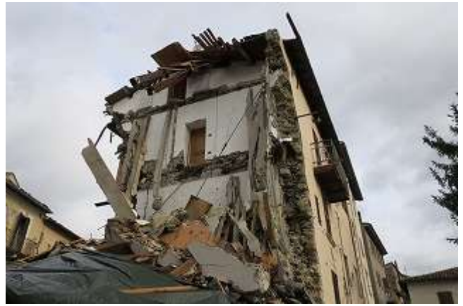
写真 7-6 組積造の被害
