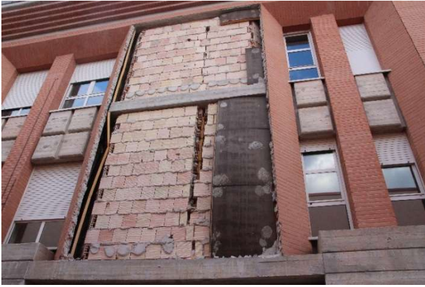
写真 7-57 落下した外壁部分
