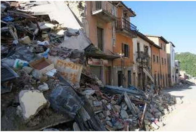
写真 6-13 組積造建物の被害
