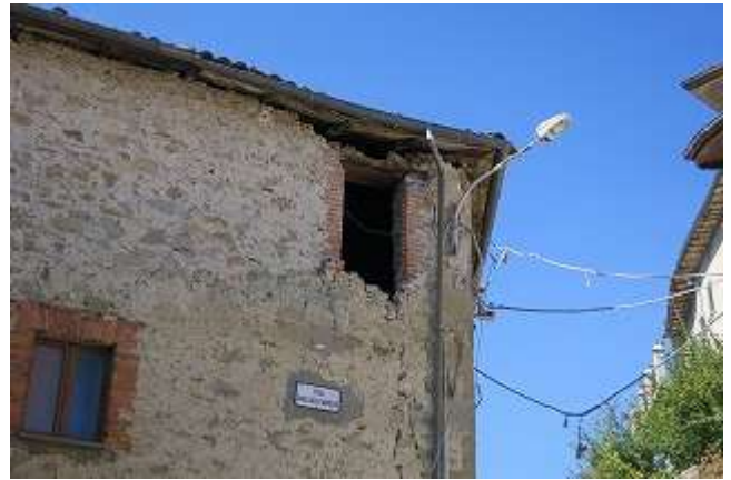
写真 6-28 組積造建物の被害
