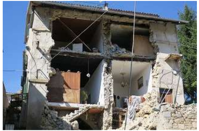
写真 6-18 組積造建物の被害
