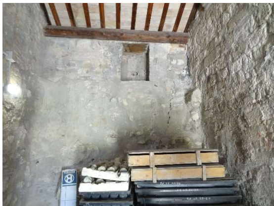
写真 8-13 壁のひび割れ
