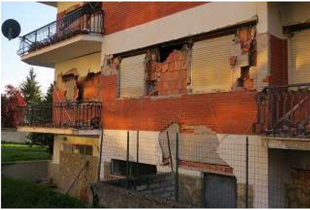
写真 5-25 RC 造建物の被害
