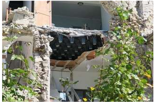
写真 6-20 組積造建物の被害
