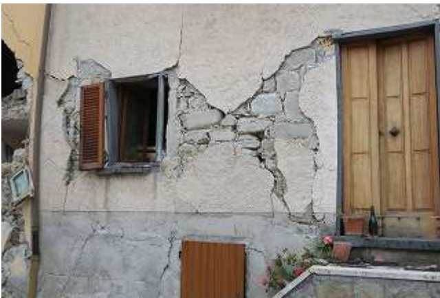
写真 7-9 組積造の被害 (せん断)
