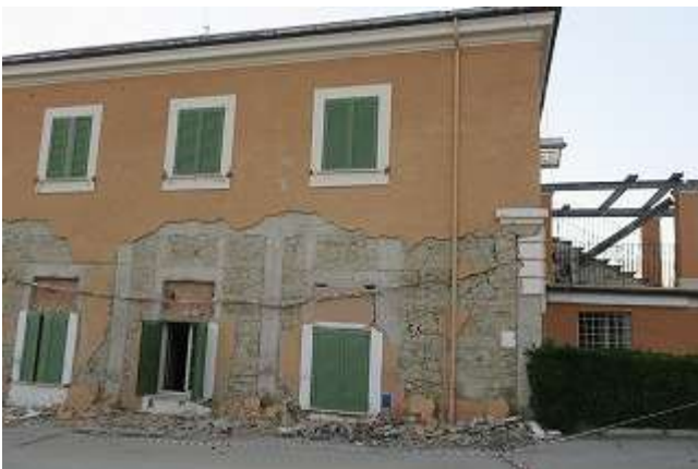
写真 5-39 RC 造建物の被害
