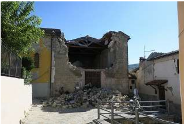
写真 6-21 組積造建物の被害
