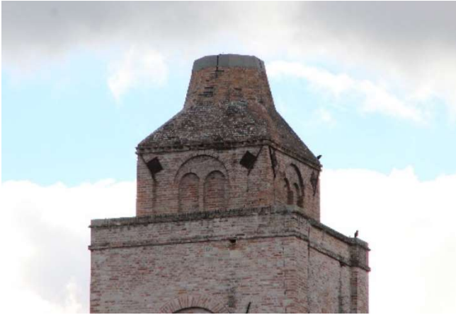
写真 7-45 教会の鐘樓頂部の破損
