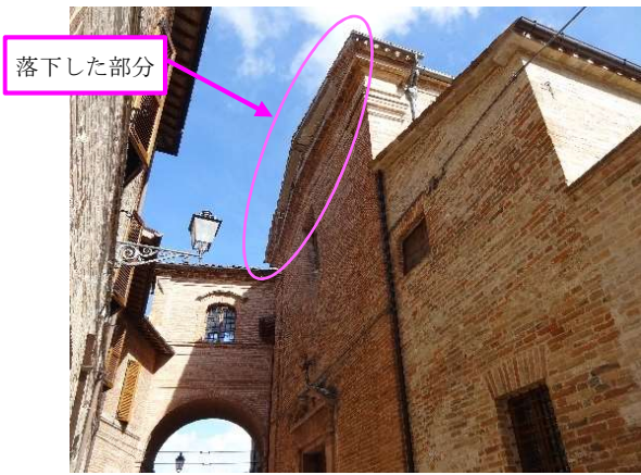
写真 7-37 頂部レンガの崩落
