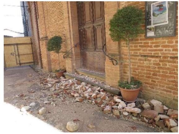
写真 7-38 アーチ部から落下したレンガ
