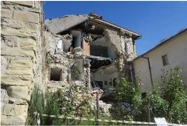
写真 6-19 組積造建物の被害
