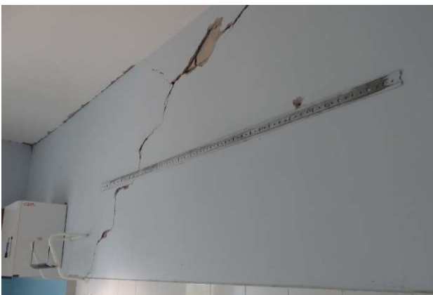
写真 7-55 病院の壁のひび割れ
