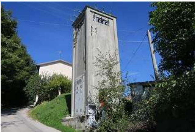
写真 6-29 RC造壁式変電施設の被害
