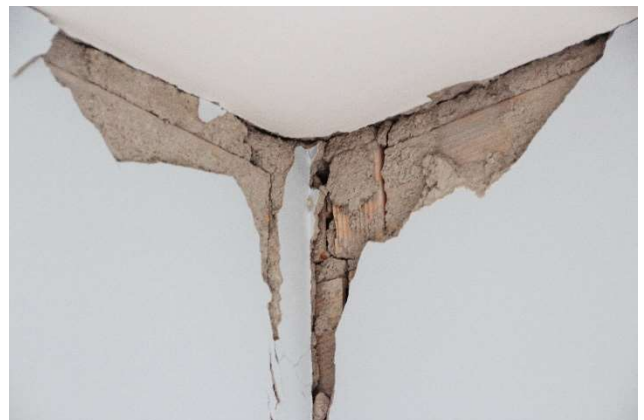
写真 7-56 病院の壁の損傷
