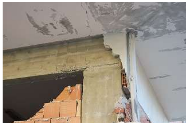
写真 5-24 RC 造建物の被害
