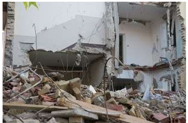
写真 5-32 RC 造建物の被害
