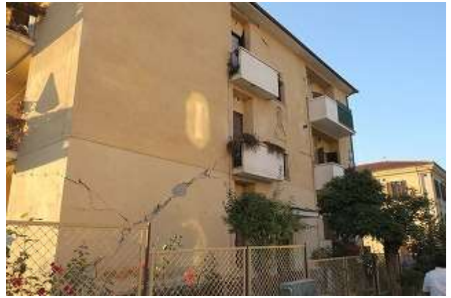
写真 5-18 RC 造建物の被害
