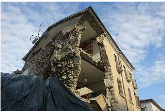
写真 6-11 組積造建物の被害
