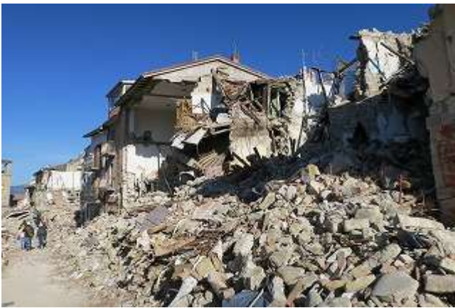
写真 6-15 組積造建物の被害
