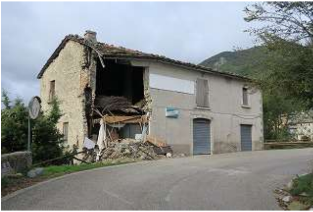
写真 7-5 組積造の被害 (面外方向)
