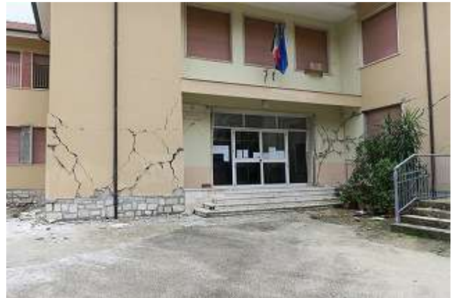
写真 7-20 中学校の被害（せん断）
