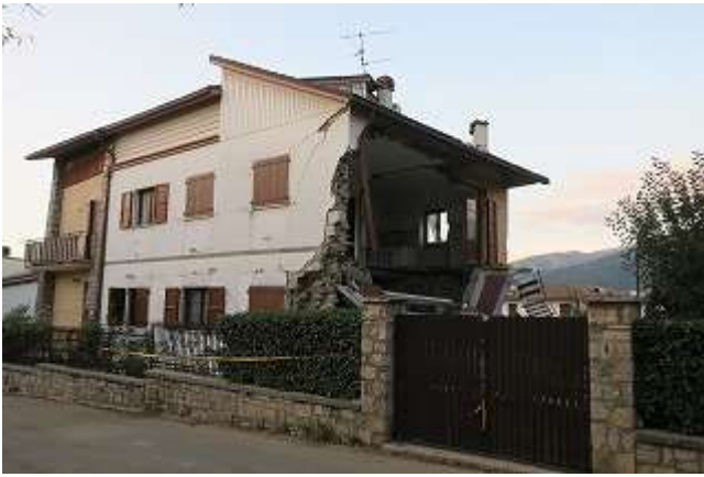
写真 5-33 RC 造建物の被害
