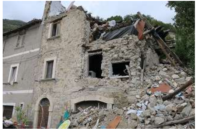
写真 7-36 組積造の被害（彫刻家の家）
