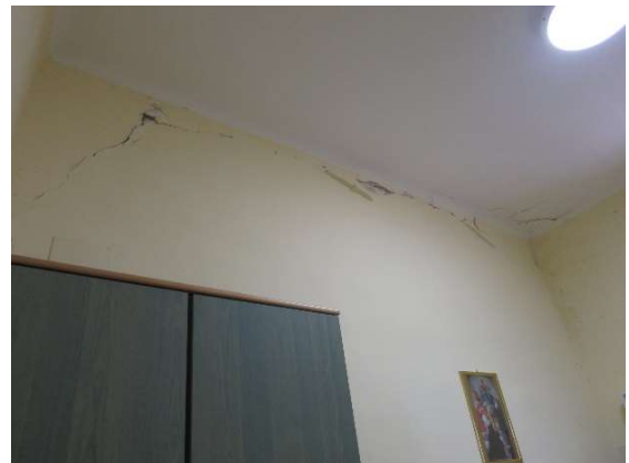
写真 8-8 回廊上階修道院の壁のひび割れ (内部)
