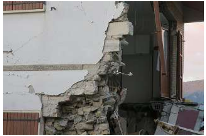
写真 5-34 RC 造建物の被害
