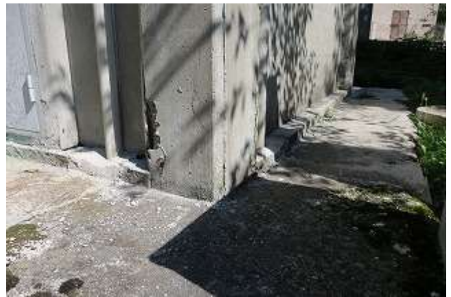
写真 6-30 RC造壁式変電施設の被害
