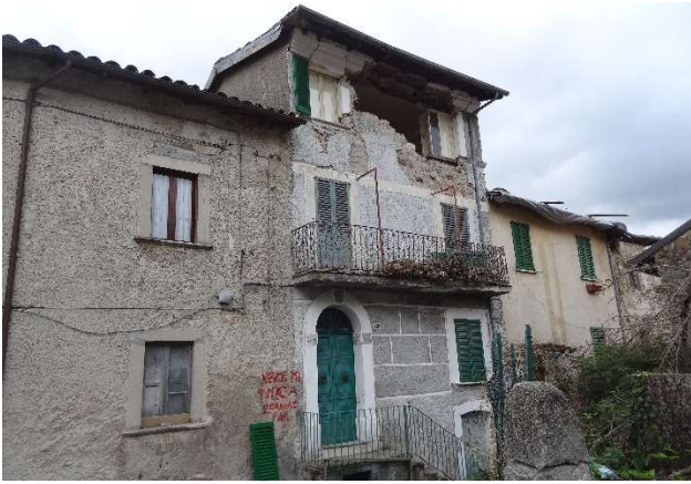
写真 7-15 組積造の被害
