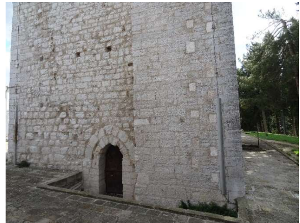
写真 8-12 壁のひび割れ
