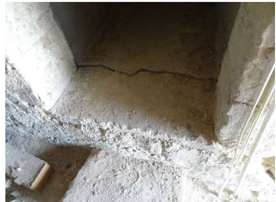
写真 8-14 床のひび割れ
