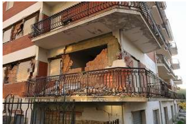
写真 5-22 RC 造建物の被害
