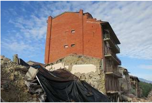
写真 6-5 RC 造建物の被害
