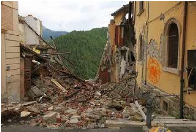
写真 7-7 組積造の被害 (面外方向)
