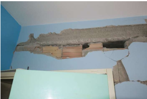
写真 7-53 病院の壁の損傷
