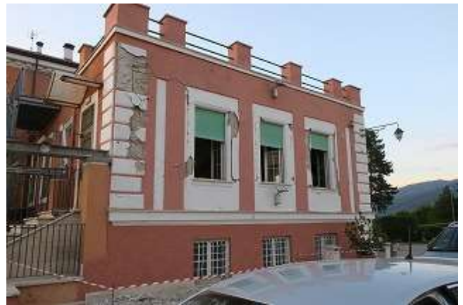
写真 5-38 RC 造建物の被害
