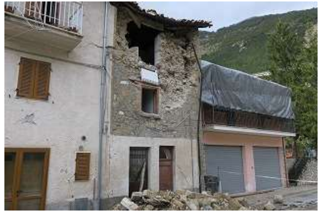
写真 7-34 組積造の被害
