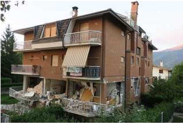
写真 5-35 RC 造建物の被害
