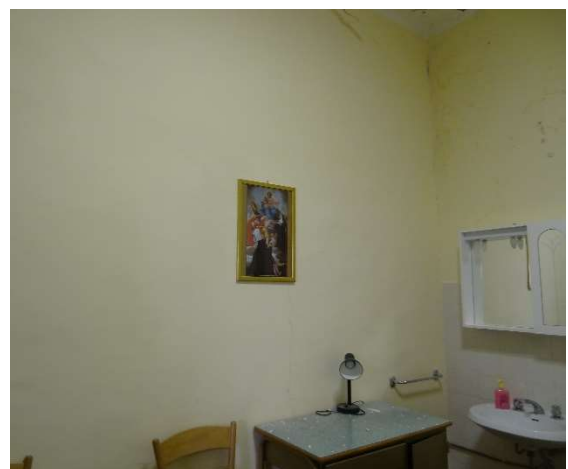
写真 8-10 回廊上階修道院の壁のひび割れ (内部)
