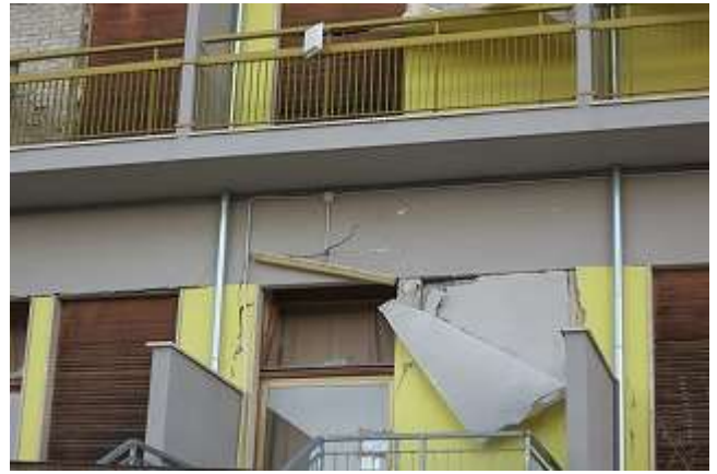
写真 5-26 RC 造建物の被害
