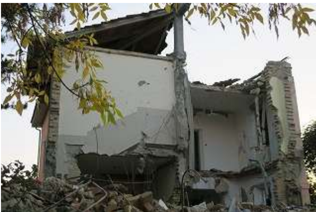
写真 5-31 RC 造建物の被害
