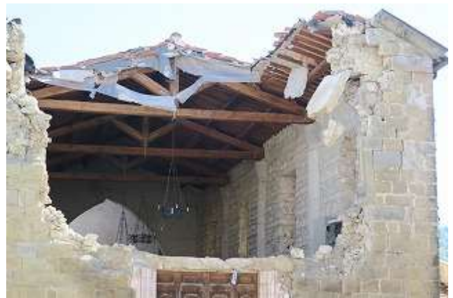
写真 6-22 組積造建物の被害
