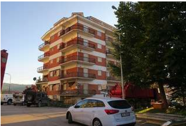
写真 5-21 RC 造建物の被害
