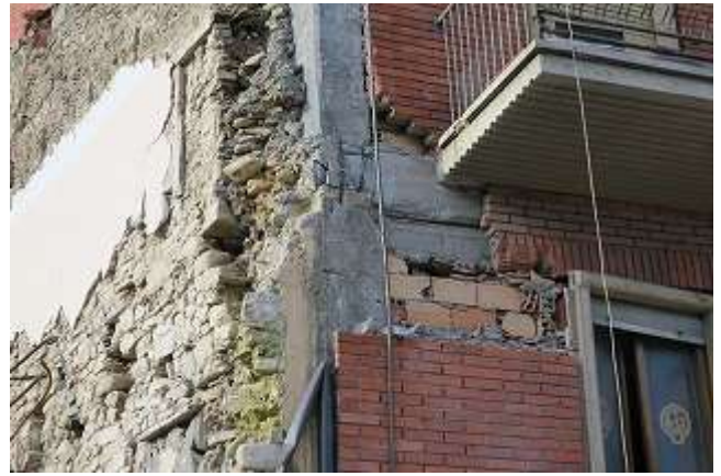
写真 6-6 RC 造建物の被害
