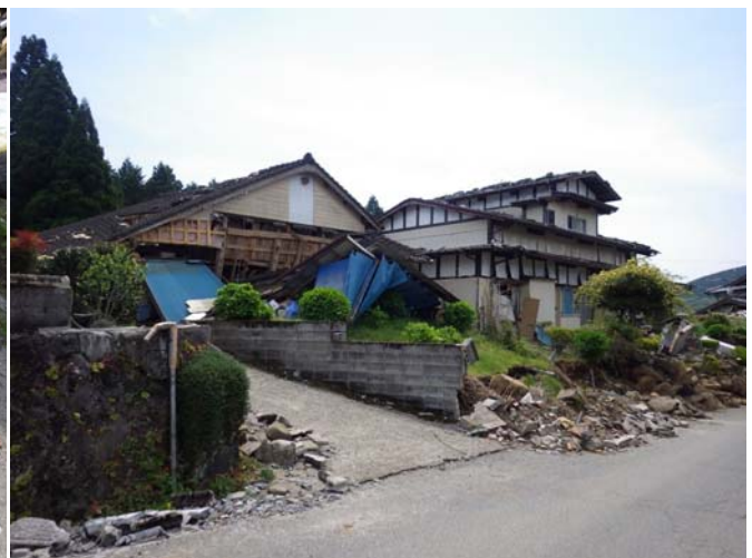
ブロック塀の被害
