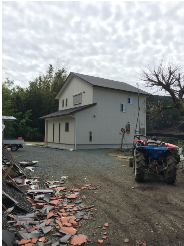
揺れによる被害がない建物。右方向が崖で、応急危険度判定は「危険」。
