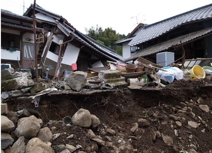
全面擁壁の崩落と上部建物の大変形
