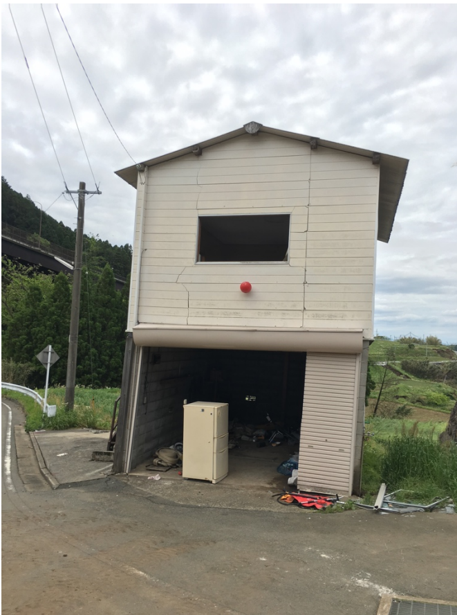
消防団車庫・詰所。一階コンクリートブロック造，2階木造。1階の残留変形。
