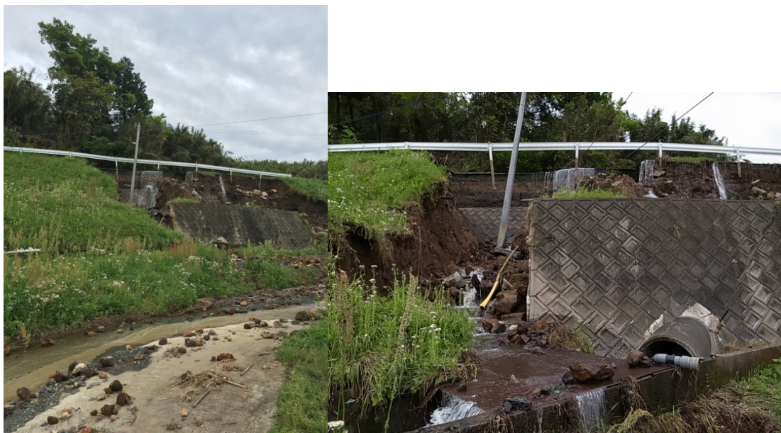
ため池からの漏水により通行止めになっている集落への種アクセス路。
