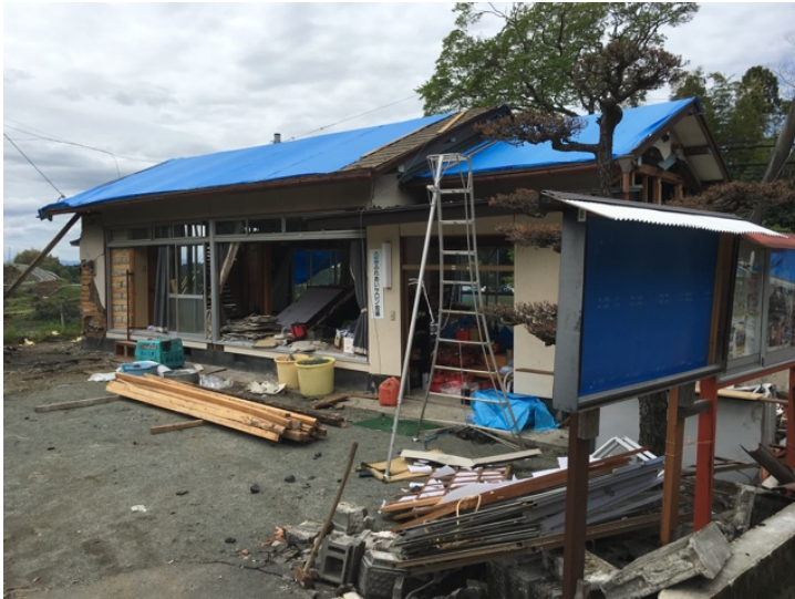
地区の公民館。残留変形の様子。
