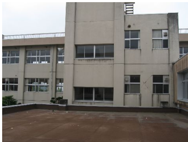
写真 3-12. 特別教室北側の雑壁のせん断亀裂
