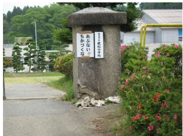
写真 6-5 破損した門柱
