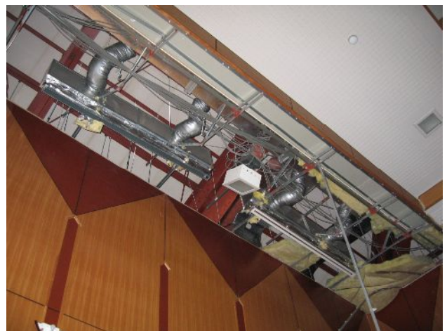
写真 17-6 天井下地材とともに落下
