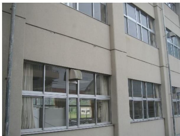
写真 3-14. 特別教室北面 2階床位置に水平亀裂
