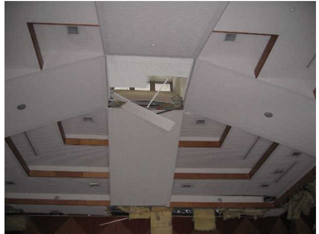
写真 17-4 中央部ルーバーの落下
