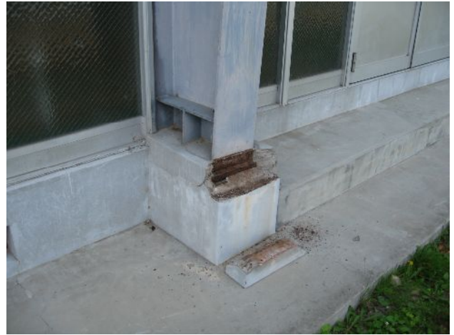
写真 13-10 柱脚モルタルの破損
