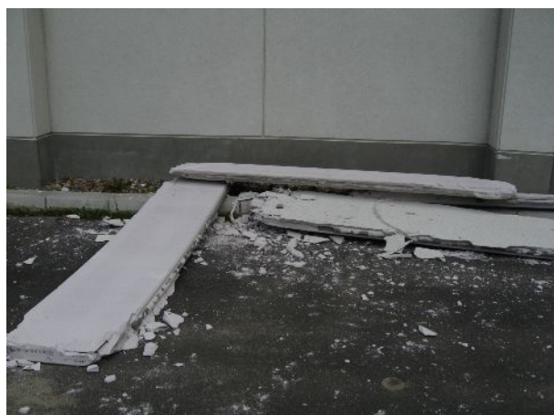
写真 7-3 落下した ALC パネル
