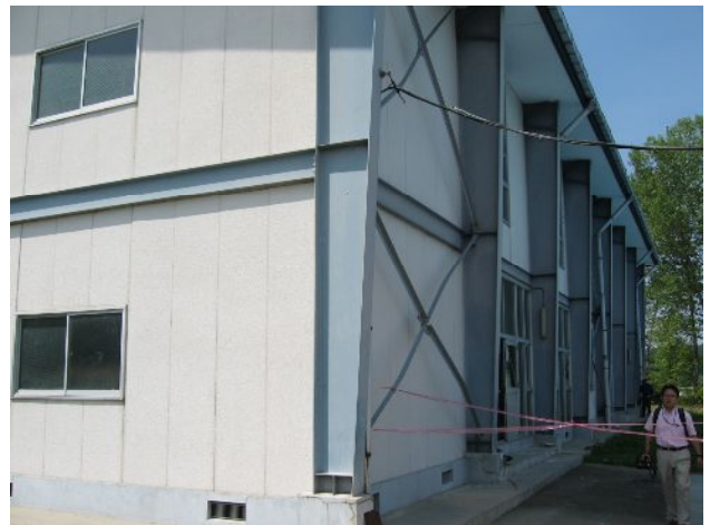
写真 13-5 ブレースの座屈した北面
