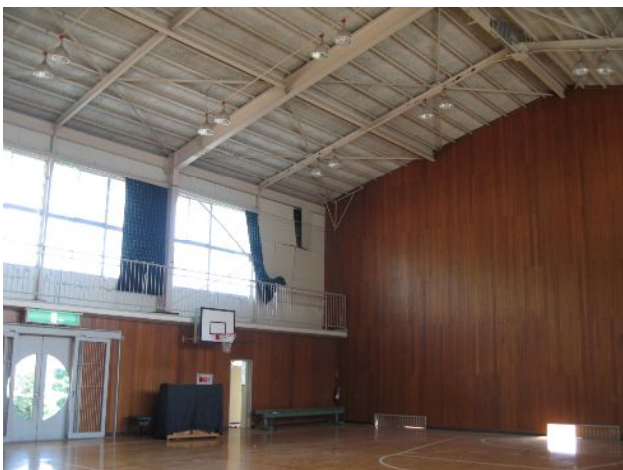
写真 15-13. 内壁ボードの剥がれ
