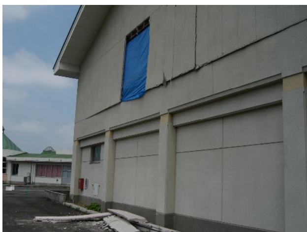
写真 7-2 ALC パネルがはらみ出た外壁
