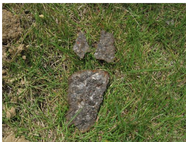
写真 14-16 折損した杭頭のコンクリート片
