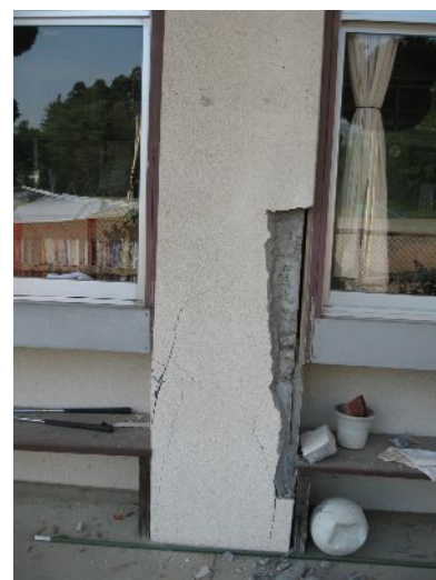
写真 15-8. 柱脚部の破損
