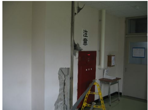
写真 4-4. エキスパンションジョイントの損傷
