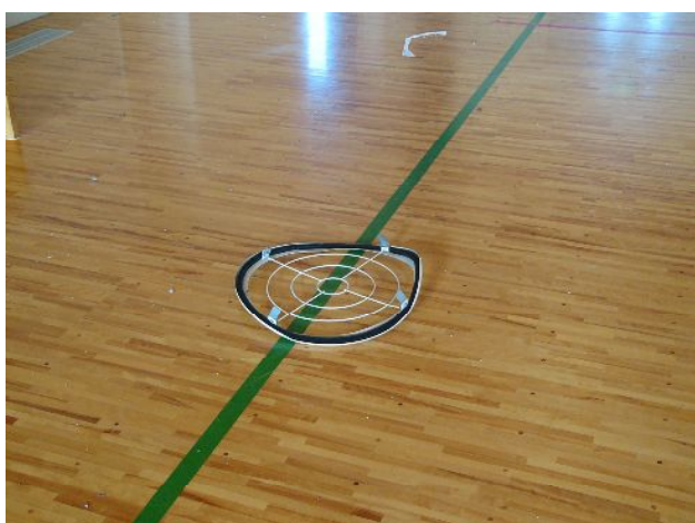
写真 12-9 落下した照明器具カバー
