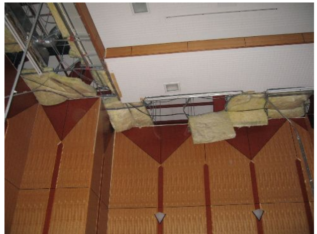
写真 17-5 壁際の天井破損状況
