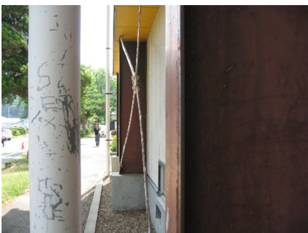
写真 10-3 鉄骨ブレースの座屈
