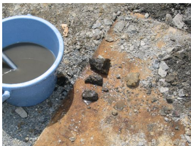
写真 14-10 杭頭部の破損コンクリート片
