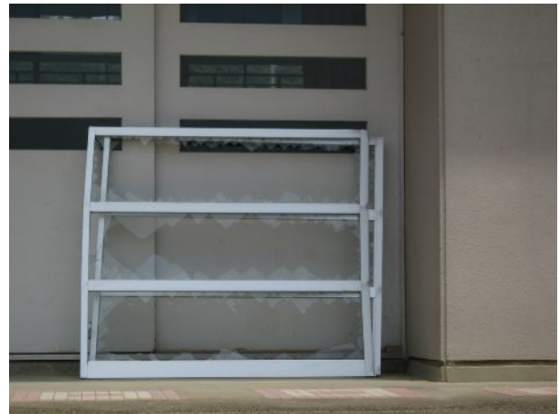
写真 6-4 落下した窓サッシとガラス片
