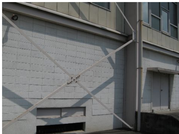
写真 8-3 鉄骨ブレースの面外座屈
