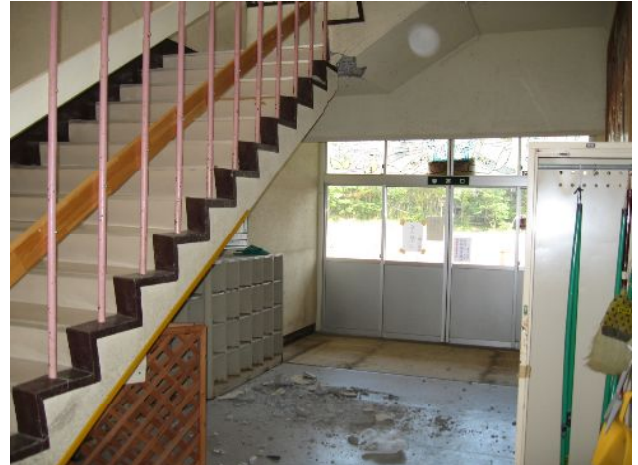
写真 15-4 .階段踊り場のコンクリート片の落下
