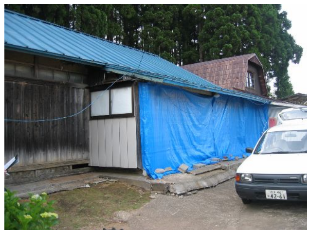
写真15:下屋部分が損壊した家屋(奥州市胆沢)
