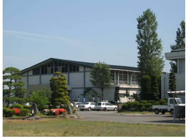
写真 13-4 体育館の全景・屋根がゆがんでいる
