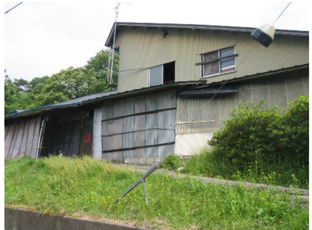
写真14 一部土台ごと移動した家屋(奥州市胆沢)
