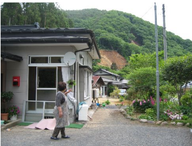
写真6 サッシの外れと壁に亀裂(滝の原)
