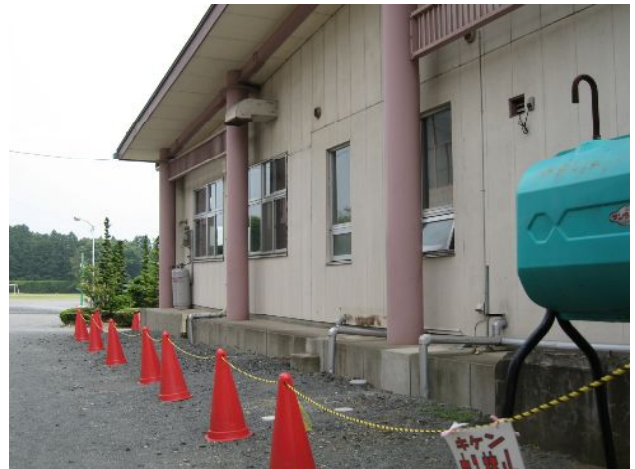
写真 14-3 不同沈下した基礎部分
