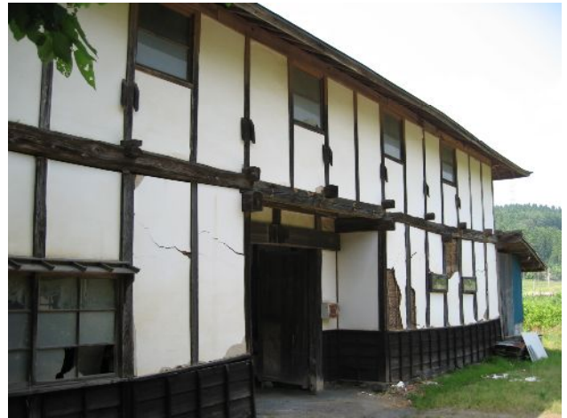
写真7 土壁の亀裂(一迫)
