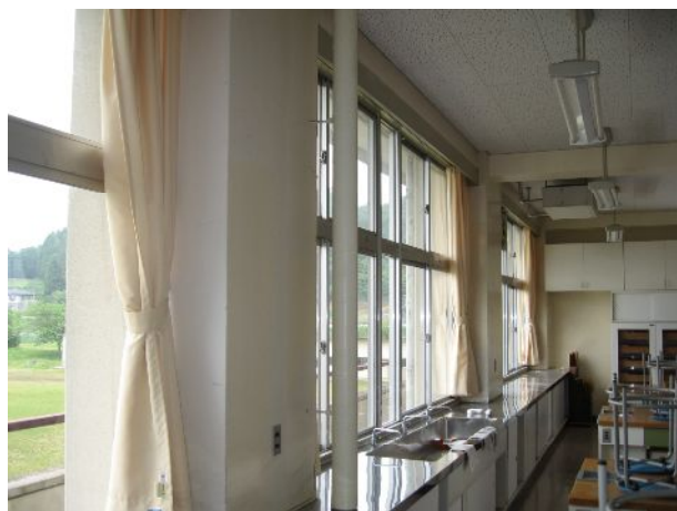
写真 3-13. 特別教室柱のせん断亀裂
