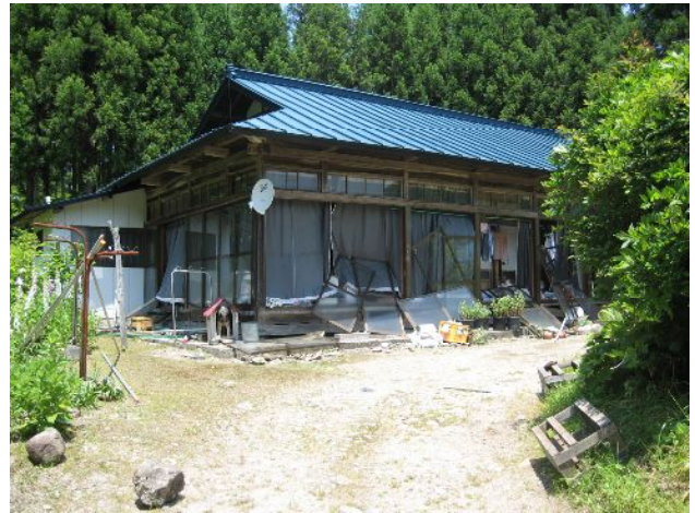
写真13 サッシが外れ散乱(花山)
