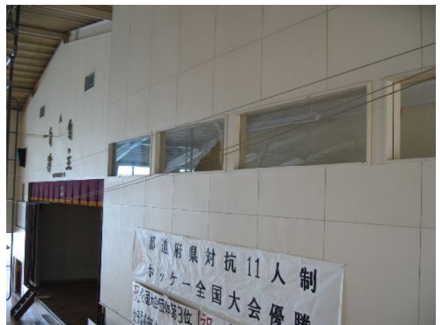
写真 13-12 調整室のガラス破損落下
