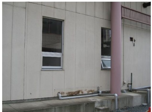
写真 14-4 浮き上がって見える配管
