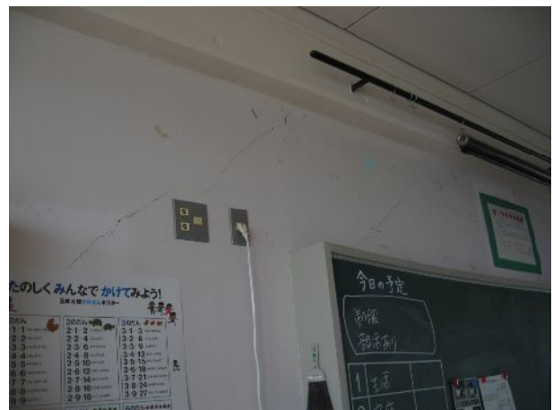
写真 4-5. 教室内の梁間方向耐震壁のせん断亀裂
