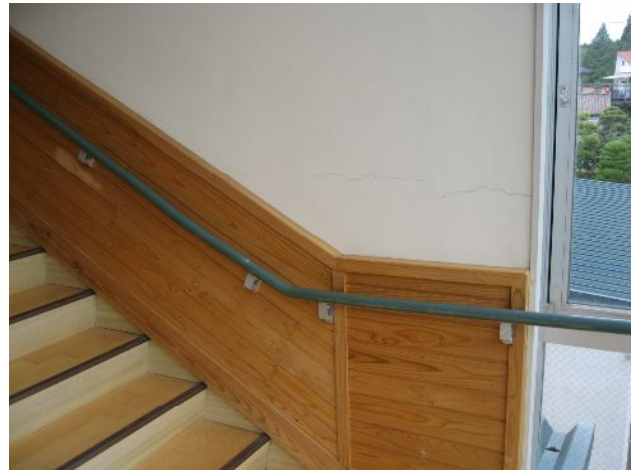
写真 2-3 階段室壁に微細亀裂
