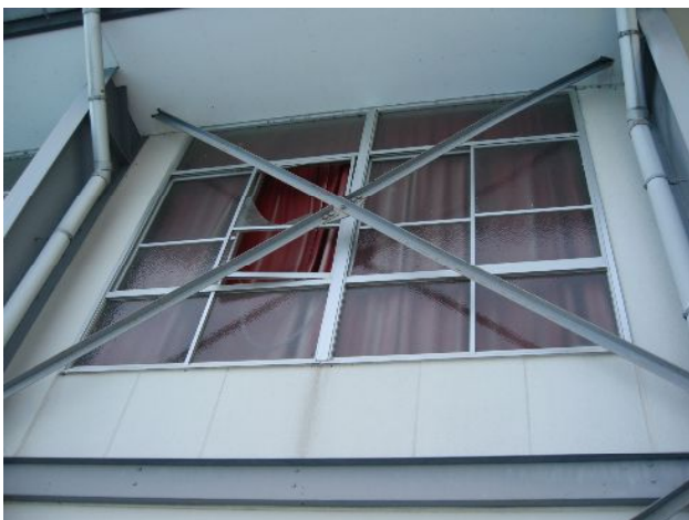
写真 13-9 北面鉄骨ブレースの座屈とサッシ破損
