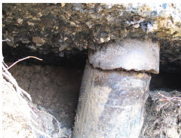
写真 14-15 RC 杭の頭部折損
