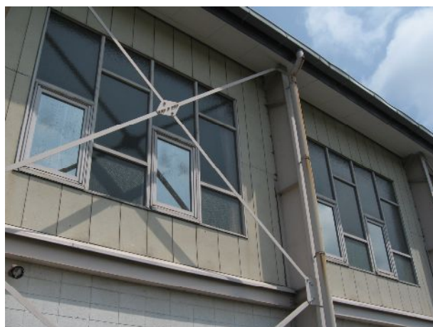
写真 8-5 外壁サイディング縁の擦傷
