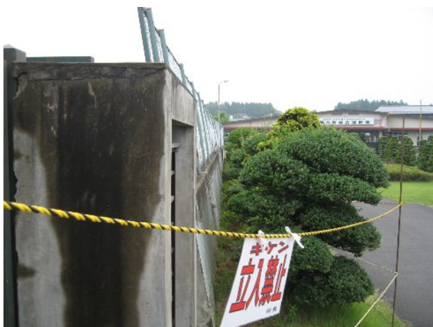
写真 14-13 プールサイド擁壁の転倒
