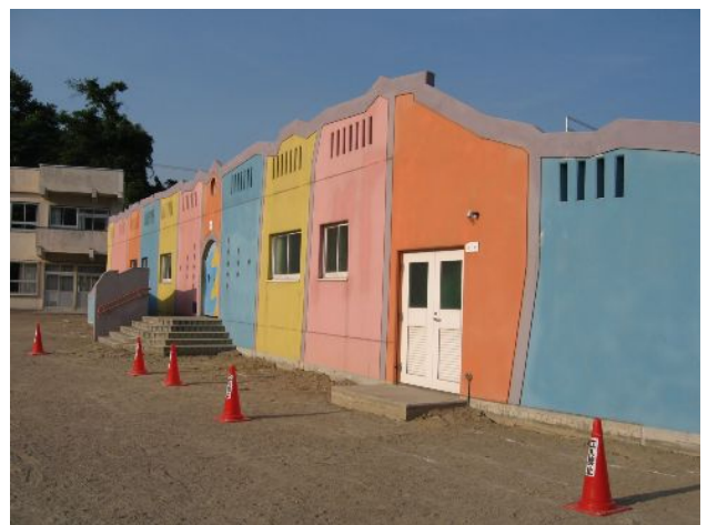
写真 16-5 プール施設の被害
