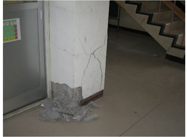
写真 15-3 .廊下側 1 階柱の亀裂
