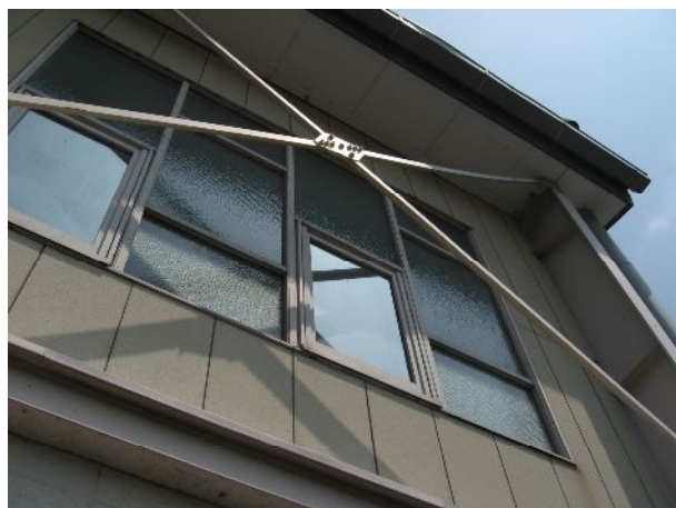
写真 8-4 2層目鉄骨ブレースの面外座屈
