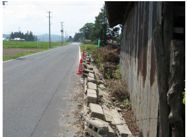
写真8 倒壊したブロック塀(一迫)
