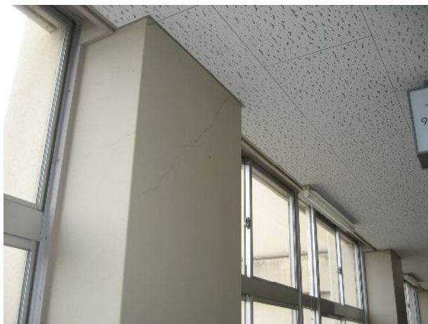
写真 3-6. 柱頭のせん断亀裂
