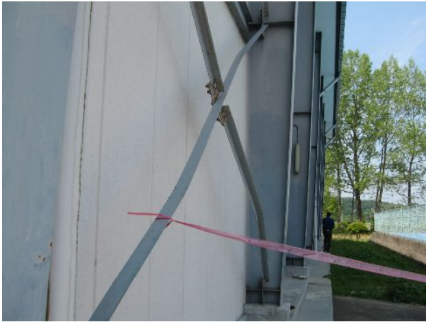
写真 13-7 北面鉄骨ブレースの座屈
