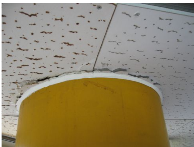
写真 14-7 沈下した柱と天井との隙間
