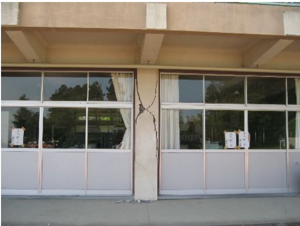
写真 15-2 一階柱のせん断亀裂
