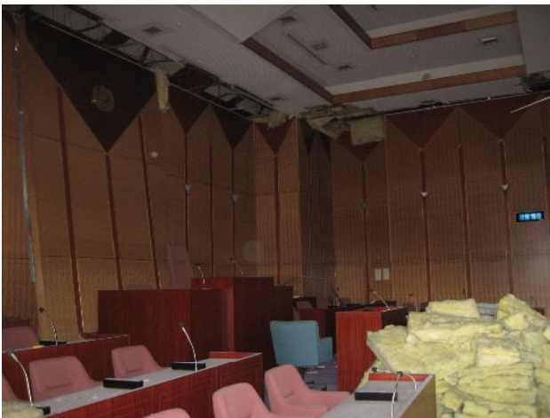
写真 17-2 議会場内部・天井の落下
