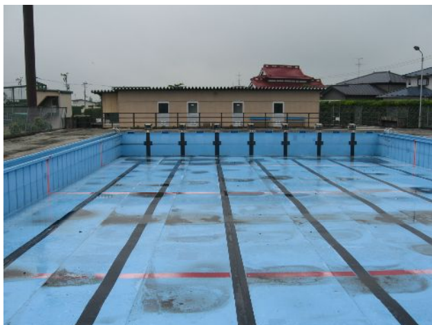
写真 14-11 プール施設の被害
