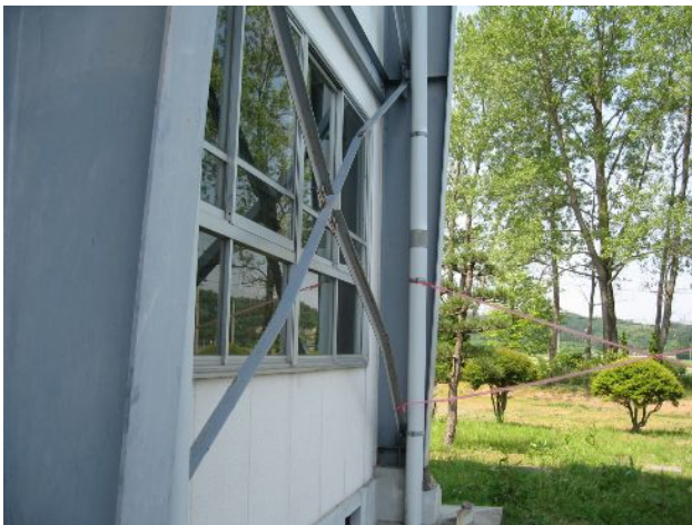
写真 13-8 北面鉄骨ブレースの座屈
