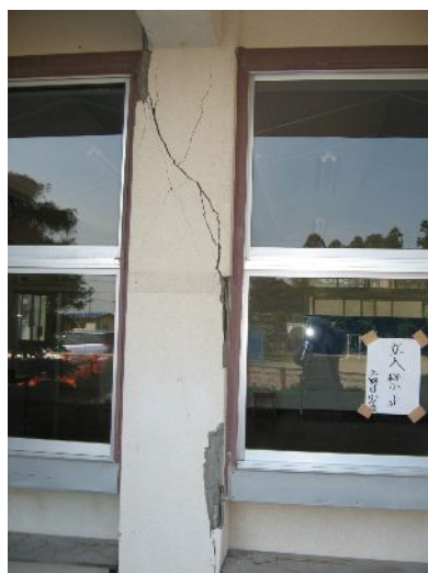
写真 15-7 1 階柱のせん断亀裂
