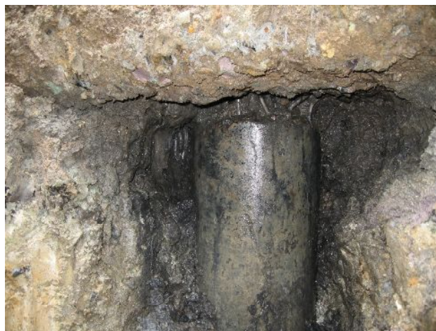
写真 14-8 杭頭の様子・露出した鉄筋
