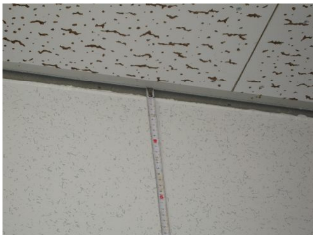
写真 14-6 天井と壁の隙間
