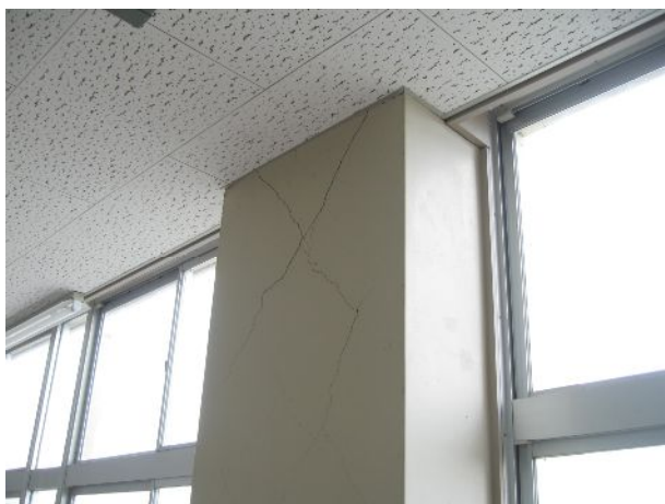
写真 3-8. 柱頭のせん断亀裂
