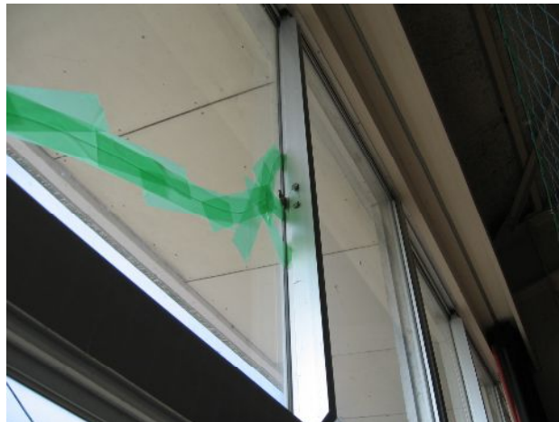
写真 15-15. サッシの外れ・クレセント破損
