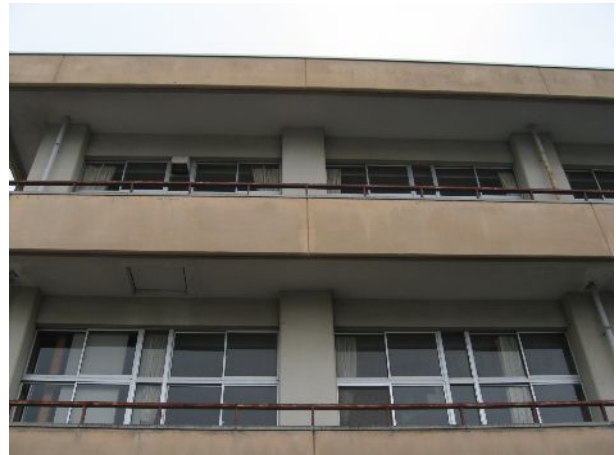
写真 3-4. 2 階~3 階柱のせん断亀裂
