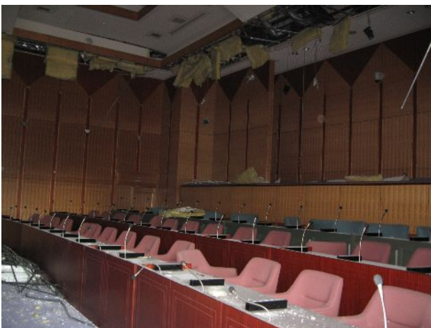
写真 17-3 壁際天井の破損落下
