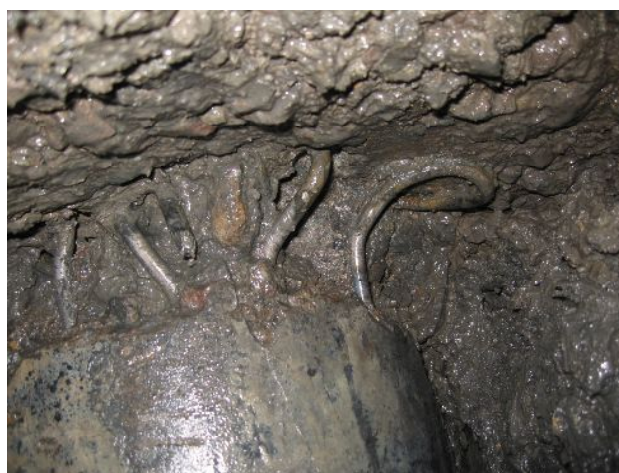
写真 14-9 杭頭部の破損状況
