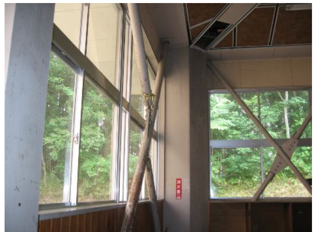
写真 5-3. 鋼管ブレース接合部座屈
