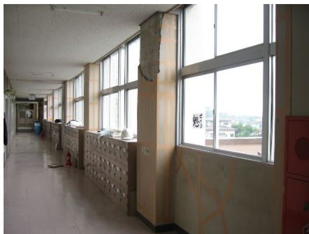
写真 3-11. 2階廊下側柱のモルタル剥落防止
