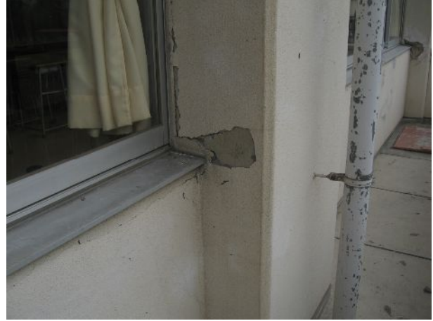
写真 3-3. 腰壁と柱の亀裂
