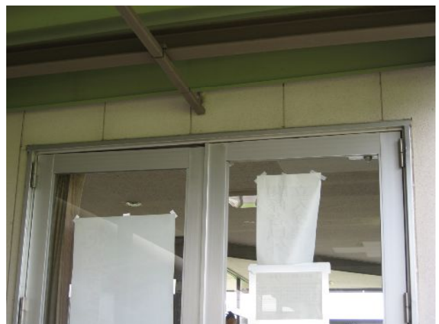
写真 14-5 歪んだサッシ枠
