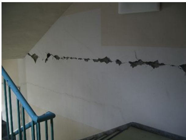
写真 4-6. 階段室コンクリート打ち継ぎ箇所亀裂
