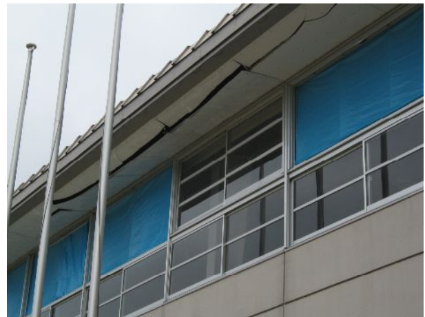
写真 6-3 ガラスの破損とサッシの落下
