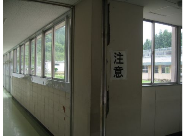
写真 4-3. エキスパンションジョイントの損傷
