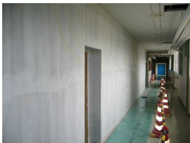
写真 4-10. B棟の増設耐震壁
