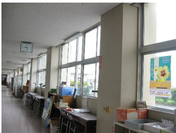
写真 3-7. 北側廊下の柱頭にせん断亀裂
