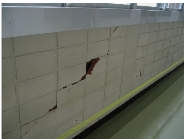
写真 4-7. 腰壁ブロックの破損
