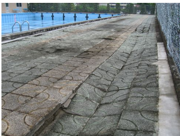
写真 14-12 プールサイドの被害
