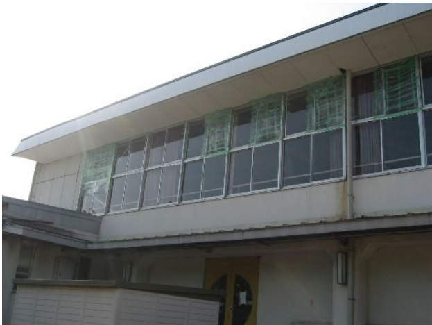
写真 15-12. 体育館サッシ窓破損
