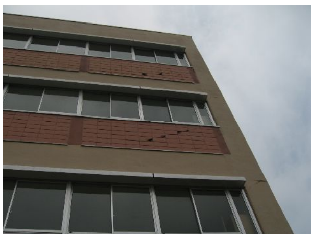
写真 4-8. 腰壁ブロックの破損
