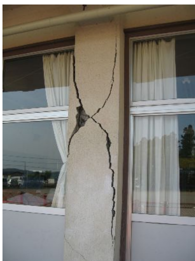
写真 15-6 主筋が露出した 1 階柱
