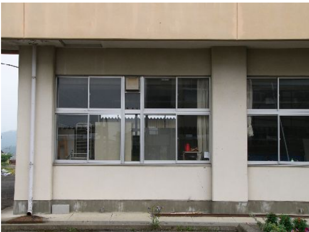
写真 3-2. 腰壁付き柱のせん断亀裂
