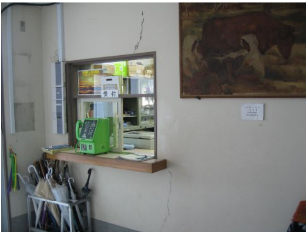
写真 13-2 壁に生じた亀裂
