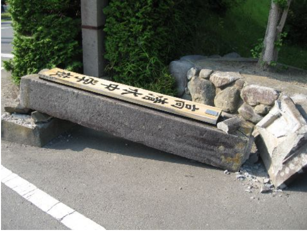
写真 12-1 転倒した門柱
