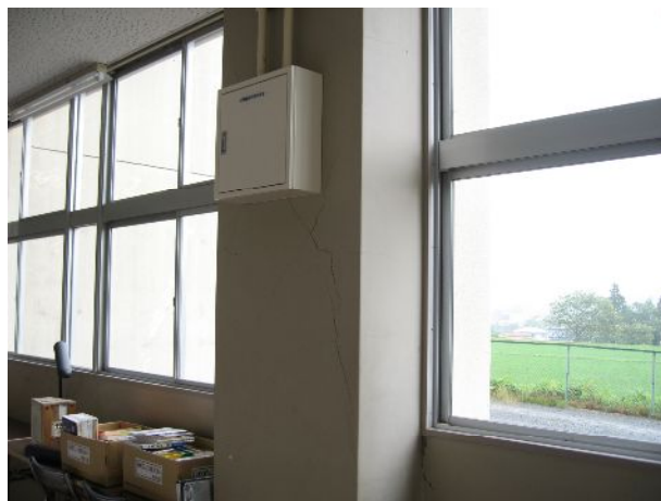
写真 3-9. 柱頭のせん断亀裂
