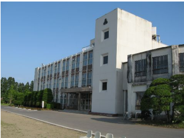
写真 12-2 微細亀裂のみの校舎
