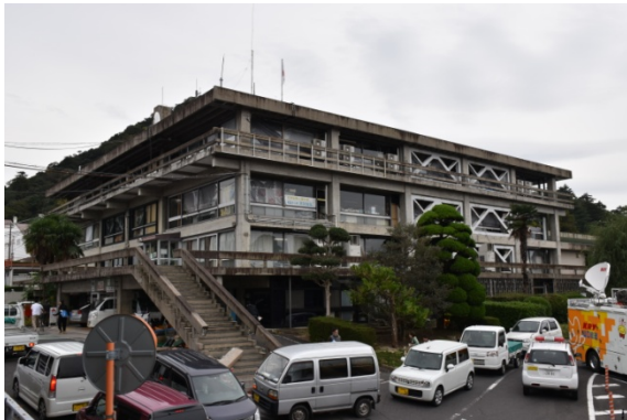
窓ガラス破損
