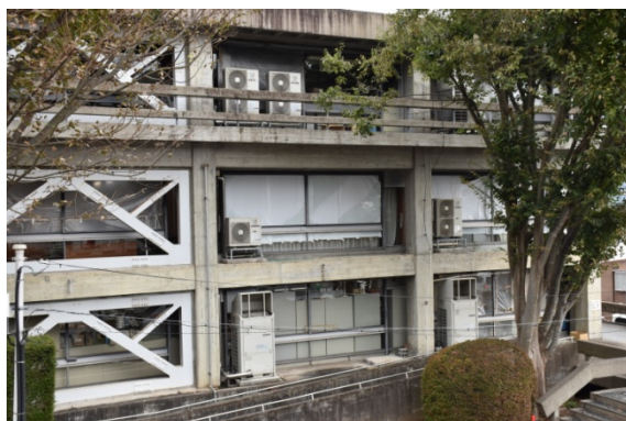
梁の曲げひび割れ
