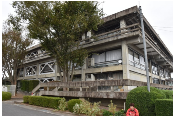
窓ガラス破損
