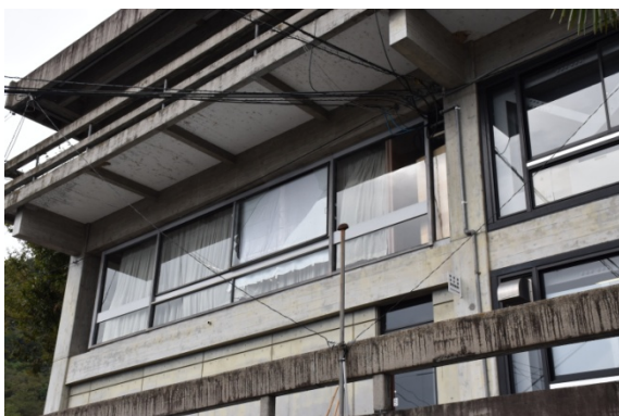
柱の軽微な曲げひび割れ
