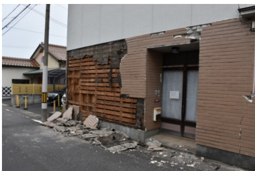
外壁モルタルの破損 倉吉市東町
