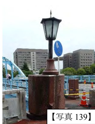
橋の街灯のずれ
