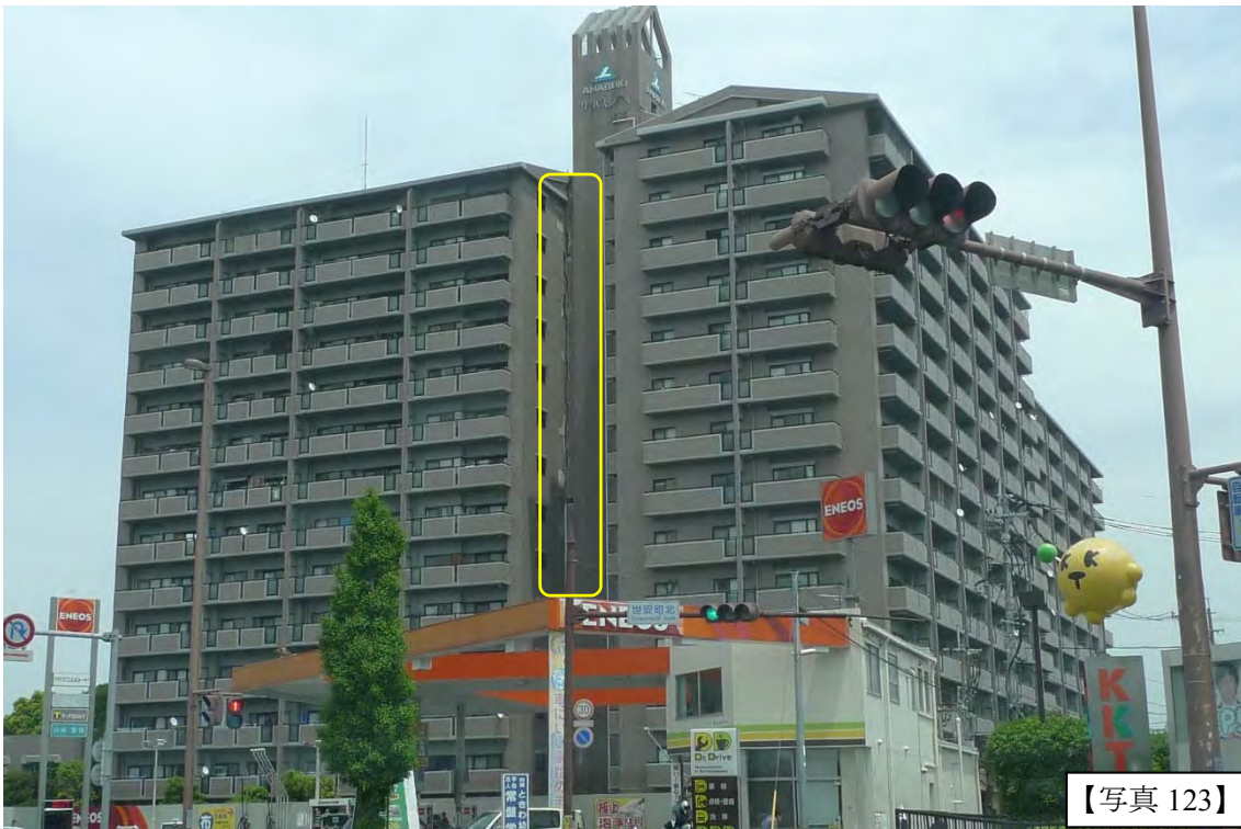
RC造集合住宅 エレベータシャフトと住戸棟の境界部の損傷
