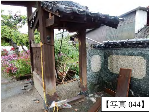
貫と帳壁が落ちた木造の門。
