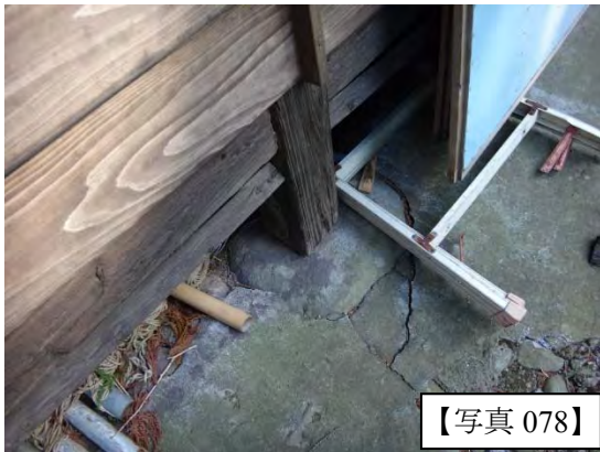
石場建て基礎、滑動の跡有り
