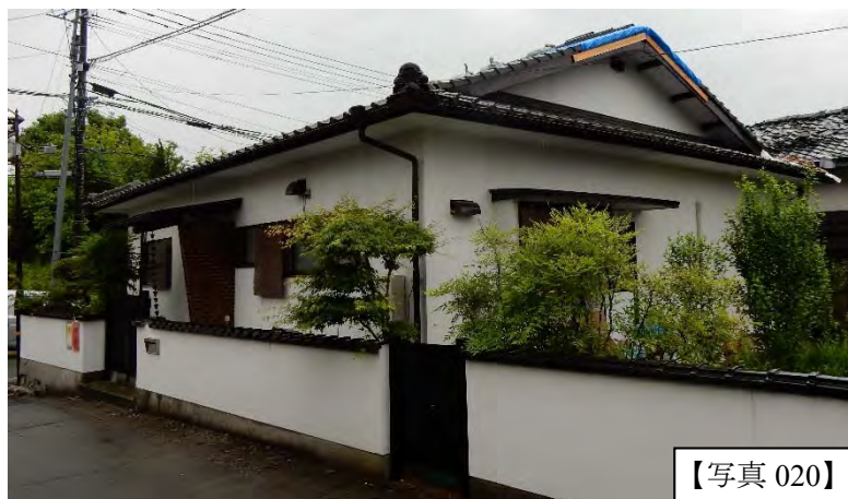
顕著な損傷は確認できないが応急危険度判定は赤。
