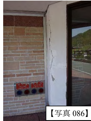
RC柱の損傷
