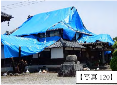
境内の家屋の瓦被害
