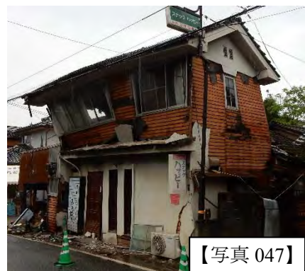
2層に損傷集中が生じた木造住宅
