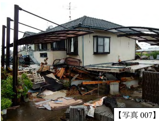
木造2階建住宅の層崩壊
