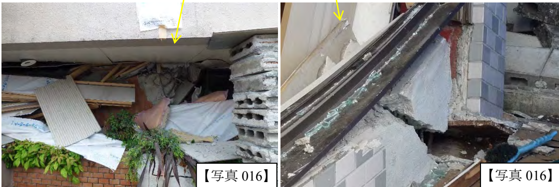
左から順に鉄筋コンクリート造（1 層の層崩壊）、鉄骨造（1 層に残留変形）、木造住宅（損傷は軽微）が並ぶ。いずれも右側の建物に寄りかかった状態である。鉄骨造の 1 層柱脚部はベースプレートが浮き上がっておりアンカーボルトは見当たらない。（写真右下）
