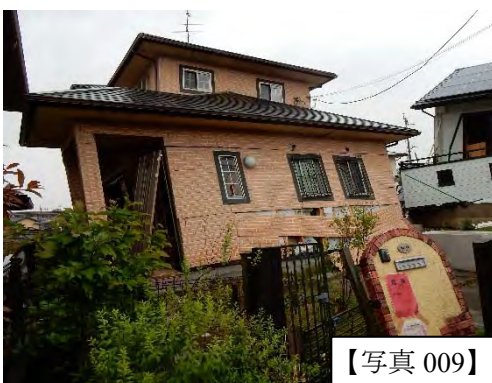
1層部分に大きな残留変形が見られる木造2階建住宅
