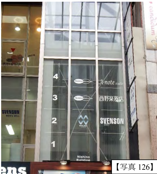
鉄骨ブレースの伸び
