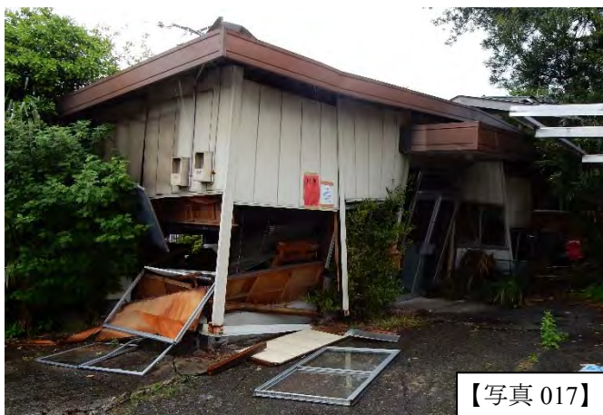
軽量鉄骨造の柱脚が基礎から離れている。
