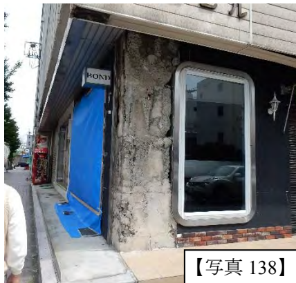
外装タイルの剥落
