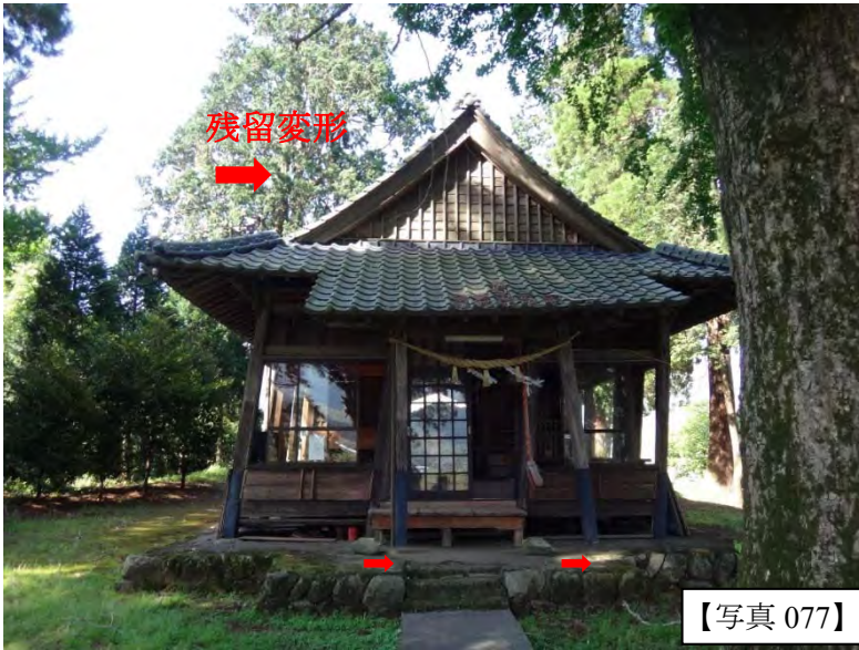
梁間方向に大きな残留変形
