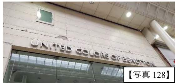
外装材の剥落
