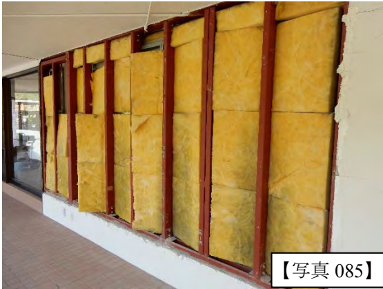
石膏ボード外装材の剥落
