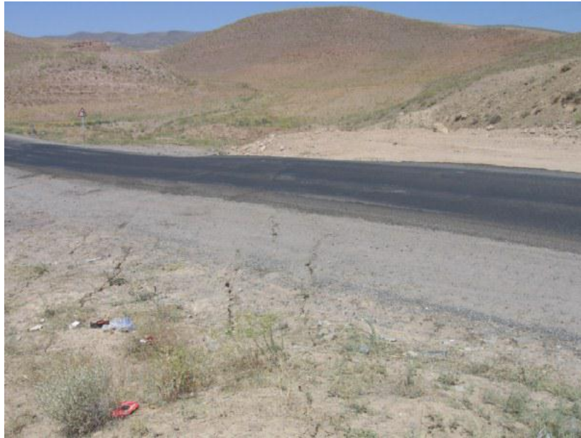
図 14 水路橋の道路面の沈下による地割れ。Khvajeh-Varzeghan 間の補修された道路にて。
