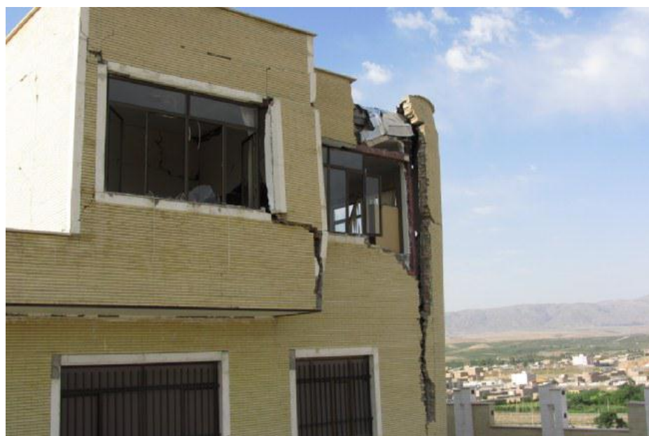
図 9 アハル文化・高等イスラム事務所における構造上の甚大な被害 (写真右上の隅部では柱と梁が分離している)
