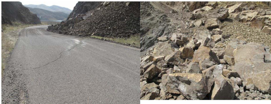
図 11 道路で見られた落石の例
