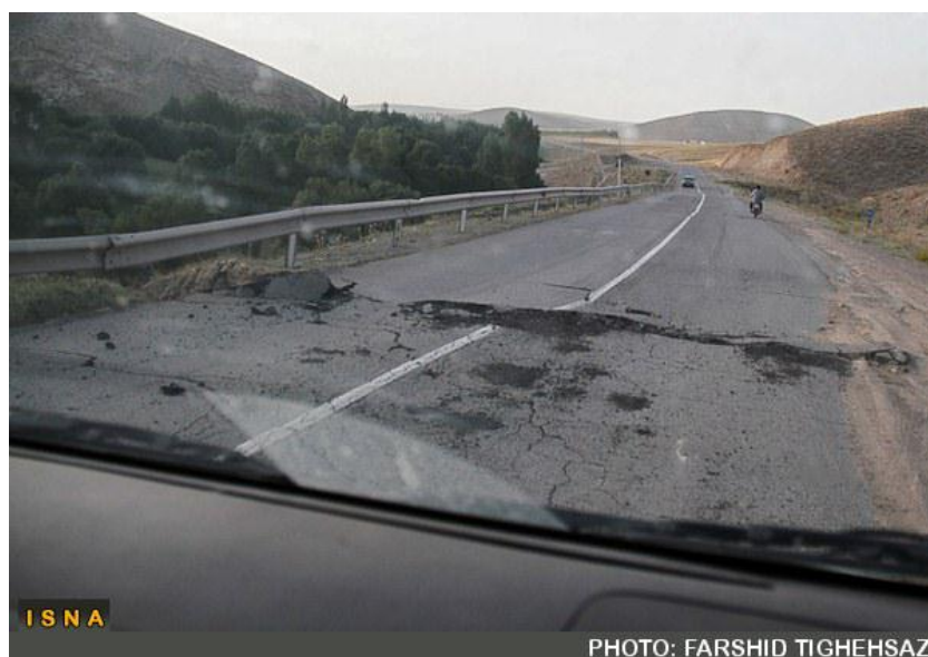
図 13 水路橋の道路面の沈下（ISNA による）
