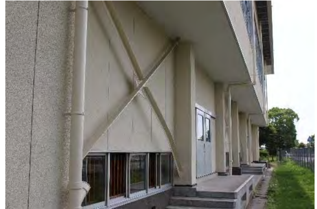
ブレースの座屈
