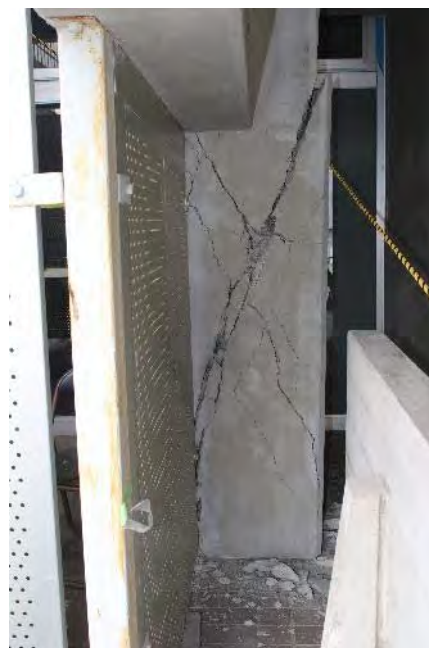
建物北側 2F 入り口の両側の柱のせん断破壊。
