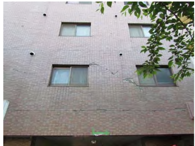
北側妻面の入り口付近の方立壁のせん断ひび割れ。
