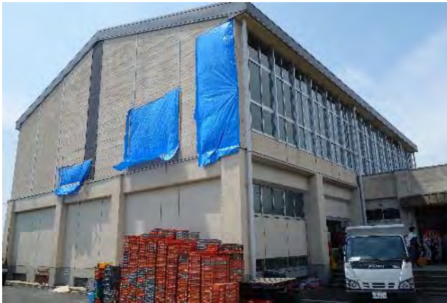
建物全景 妻壁の外側の ALC パネル落下
