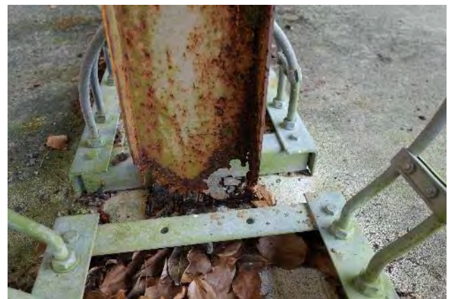
腐食による断面欠損
