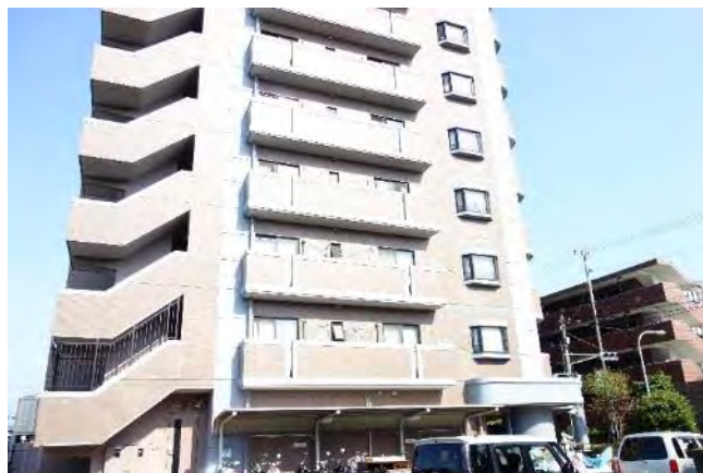
2F～4F まで西側妻面の方立壁にせん断破壊
