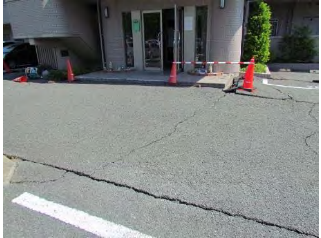
エントランス前の地盤沈下
