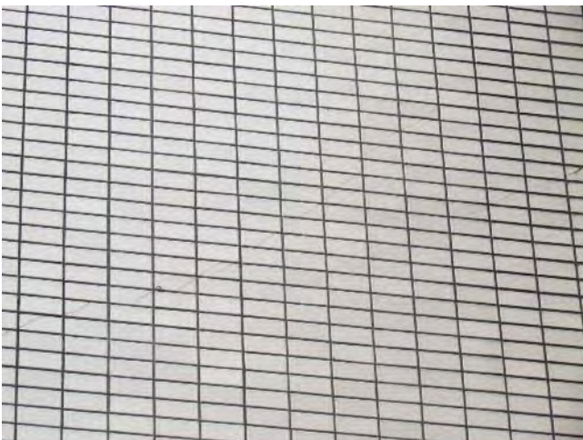
壁の斜めひび割れ (損傷度 I or II)
