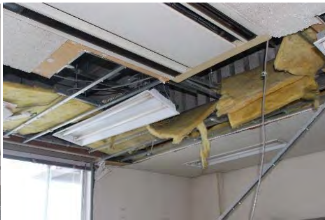
増築した S 造部における天井材の落下
