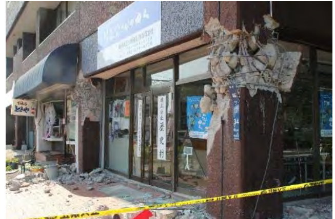
南東側柱の柱頭がせん断破壊。
