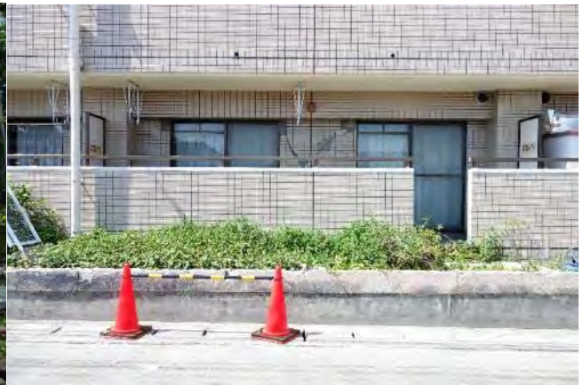
建物南側面，1階および2階の桁行方向における，方立壁のせん断ひび割れや袖壁端圧壊
