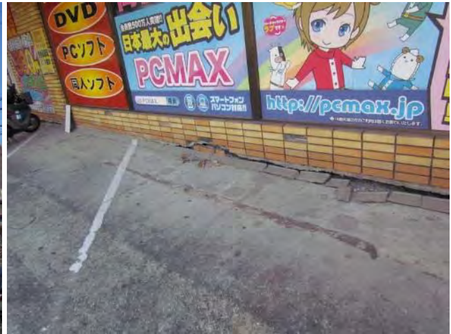
周辺地盤 10cm～15cm 地盤沈下
