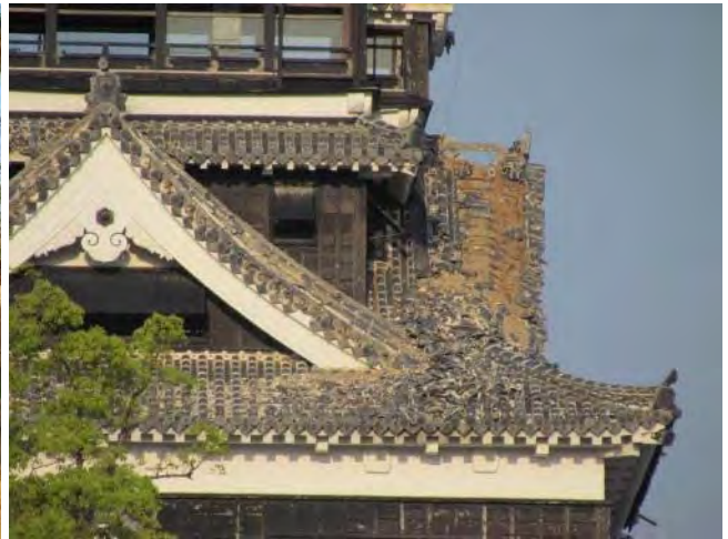
屋根瓦の落下
