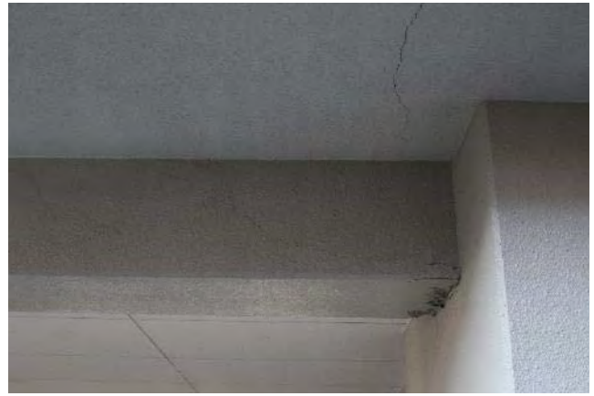
2F 梁のせん断ひび割れ (損傷度 I または II)。
