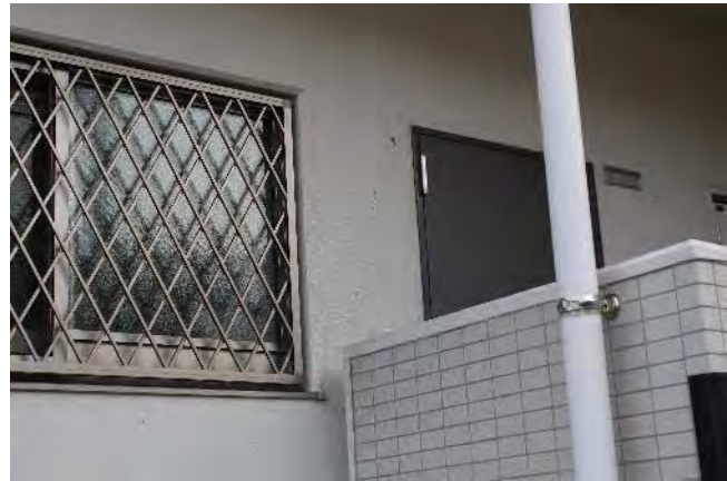
1F 桁行方向の非構造壁のせん断ひび割れ
