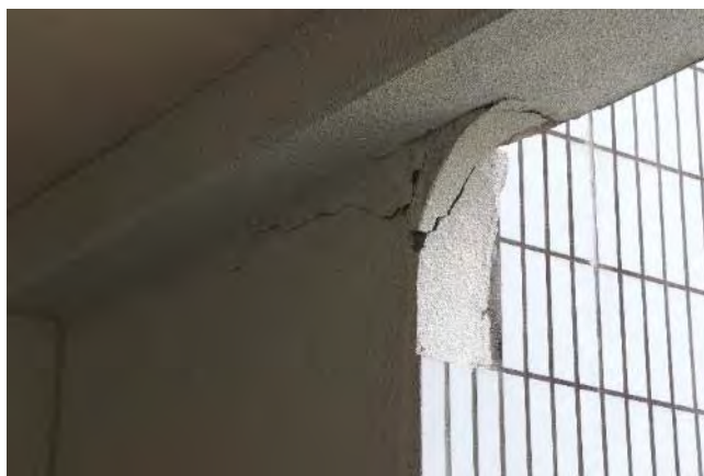
エントランスホールの2F 梁と雑壁とのコーナー部にひび割れ。
