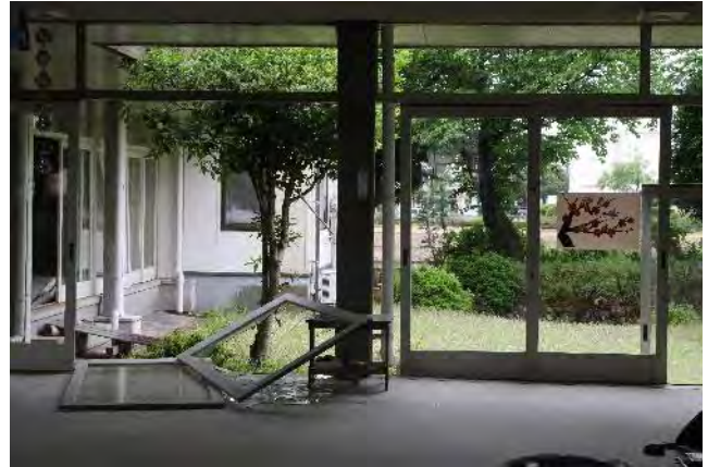
開口部の窓枠の座屈
