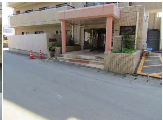
建物東側の地盤沈下 10cm 程度。
