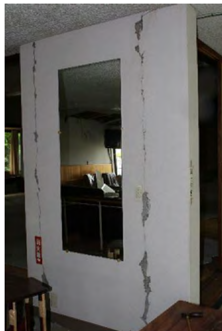
二次壁の損傷
