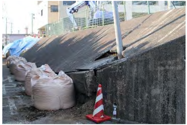
建物南側の地盤変状が著しく、崩壊の恐れあり。
