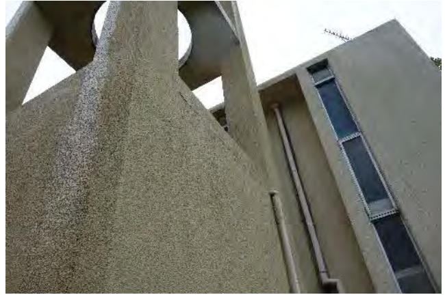
隣の塔状の建物 (鐘があった) もほぼ損傷なし。
