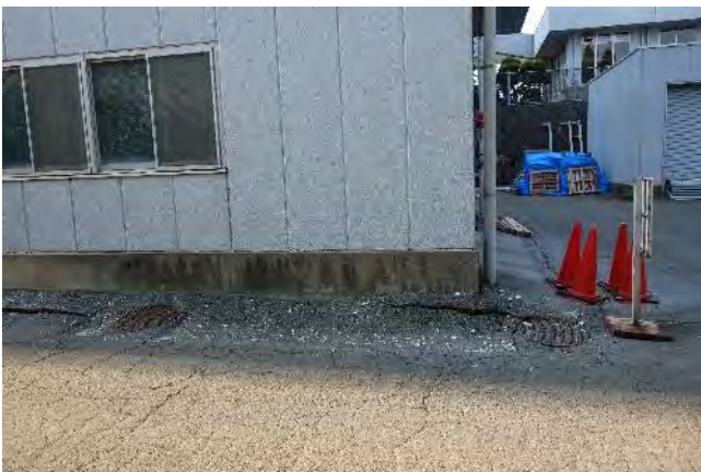
煙突周辺の地盤変状
