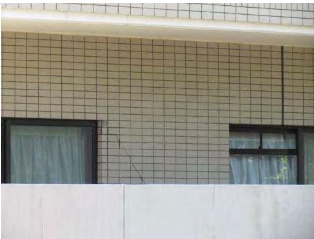
2F 張間方向の方立壁せん断ひび割れ。
