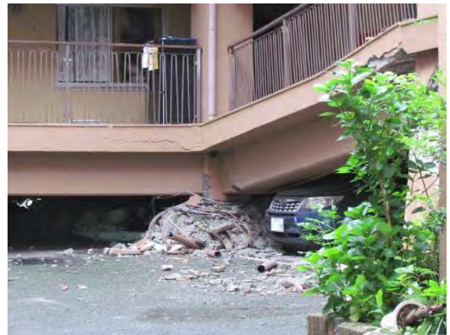
L 字平面入隅部の柱の崩壊。
