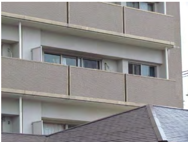
2階と3階の桁行き方向(東西方向)の方立壁のせん断ひび割れ。
