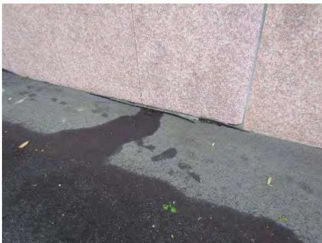
隣接する熊本総合病院 (RC 1 3F) の付近に1 ～2cm程度地盤変状あり。
