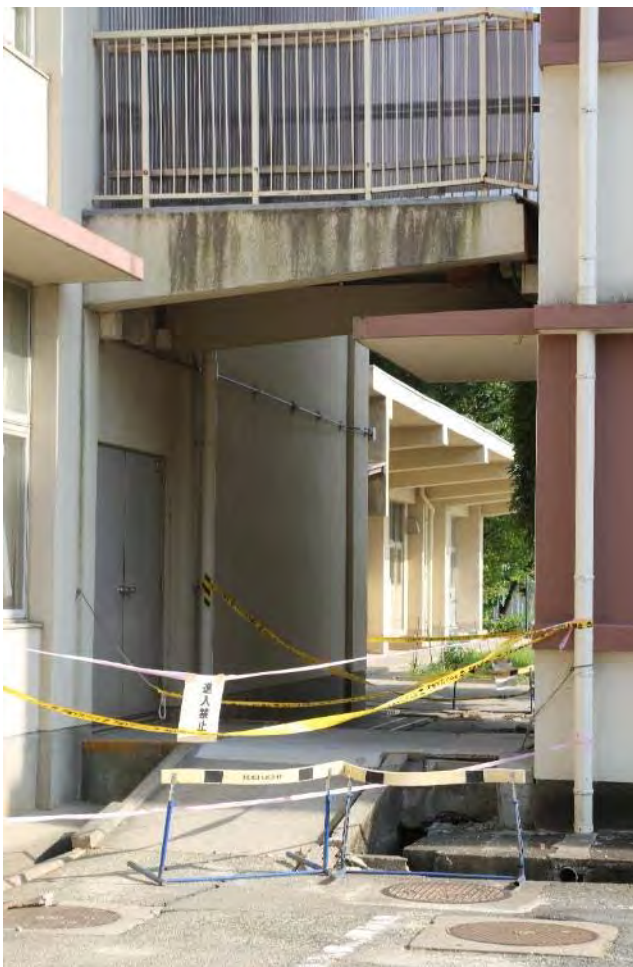
渡り廊下部分の EXP.J が地盤沈下でずれている。
