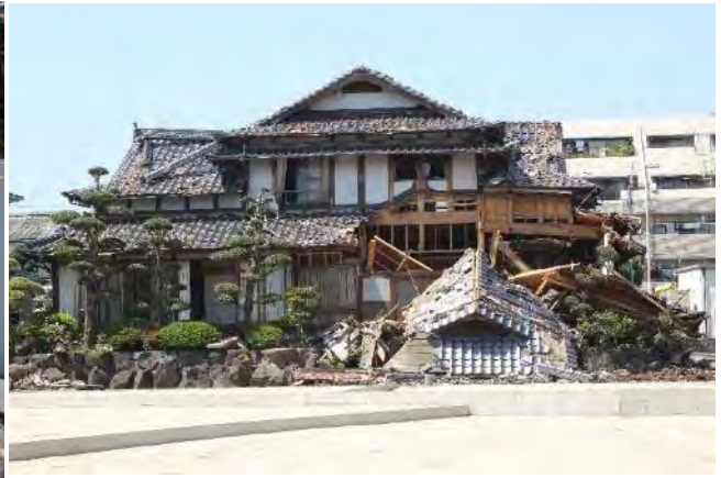
周辺の木造住宅で部分的な倒壊あり。
