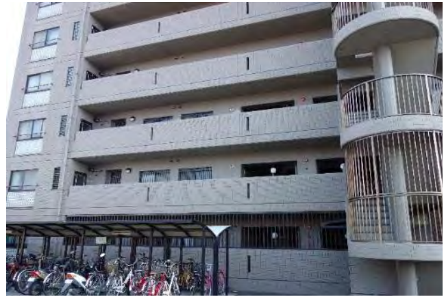
桁行方向の方立壁にせん断ひび割れ。部分的にビニールカバー設置。
