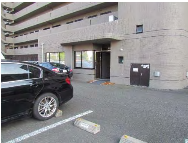
入り口付近の地盤沈下
