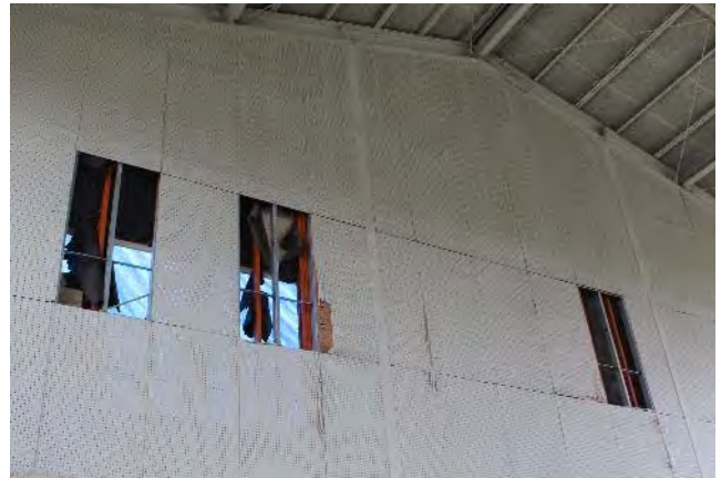
建物内側のパネルも落下
