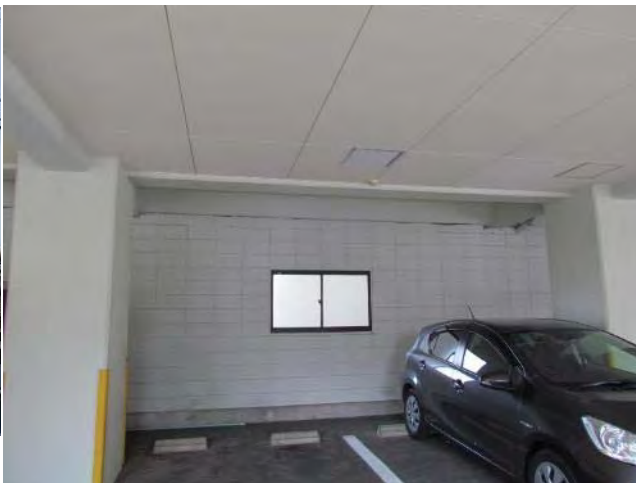
ブロック塀と躯体の境界の乖離
