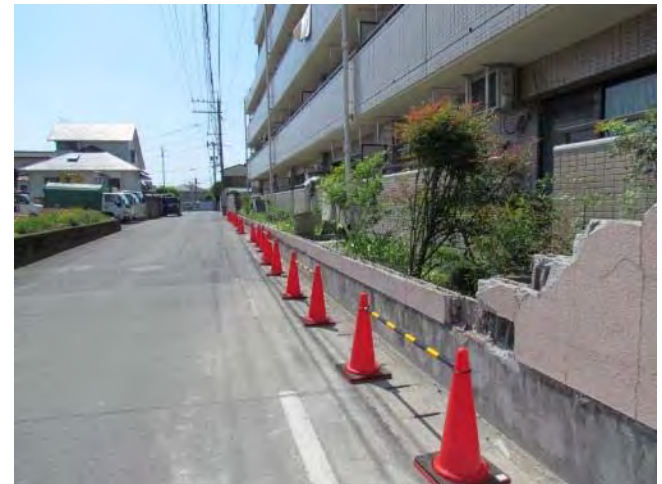
ブロック塀の一部被害（縦筋および横筋あり）
