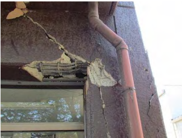
建物東側妻面の 1F 梁端部のせん断破壊。せん断補強筋 200mm ピッチ
