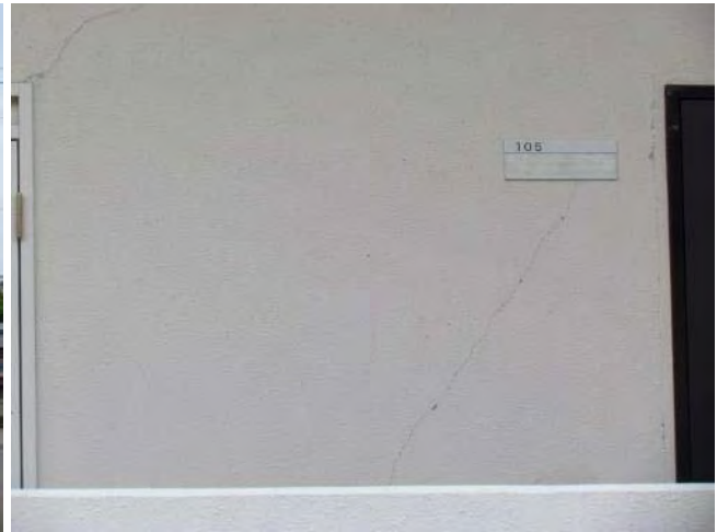
1F 桁行き方向(東西方向)方立壁せん断ひび割れ (損傷度 I or II)
