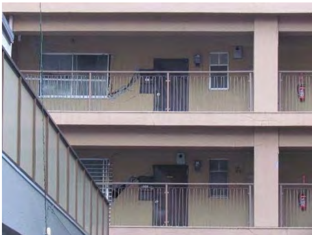
上層階の方立壁のせん断破壊
