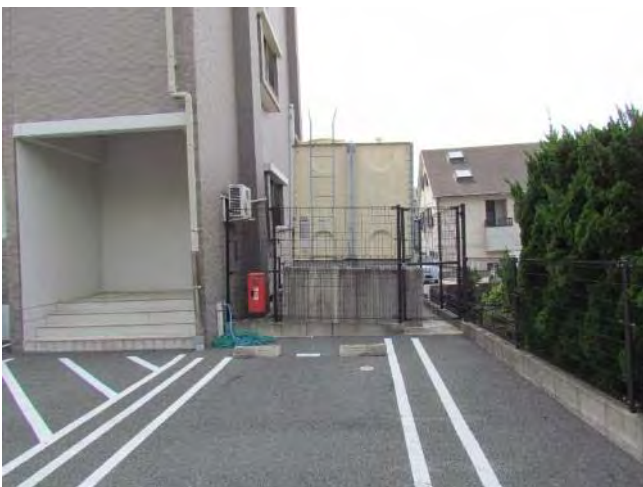
建物西側貯水槽が傾いている。周囲の地盤変状が 原因？
