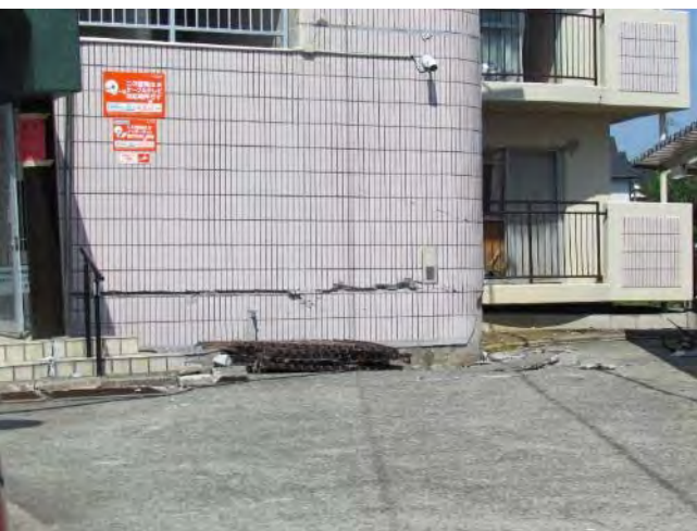
南側妻面の 1F 壁の横方向ひび割れ。
