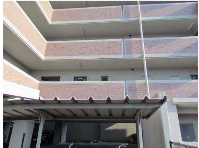
2F, 3F の桁行方向方立壁にせん断ひび割れ確認
