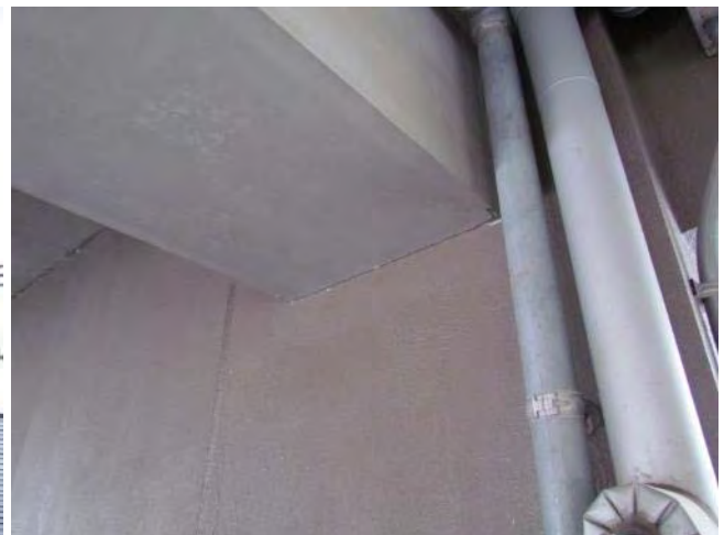
張間 2F 梁端部下の曲げひび割れ (損傷度 I or II)
