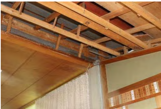
天井材の落下
