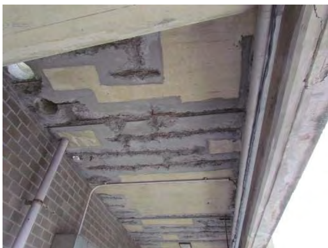
2F バルコニーの下の梁の下端筋のかぶりが十分でなく、露出している。(地震被害ではない)
