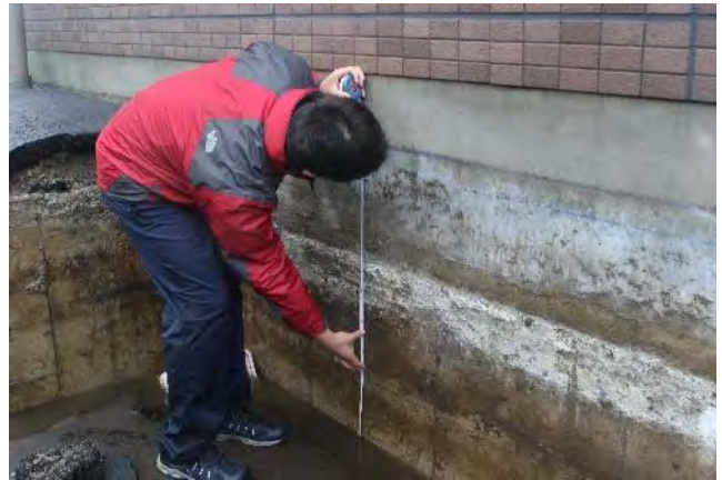
液状化による地盤沈下，最大 950mm
