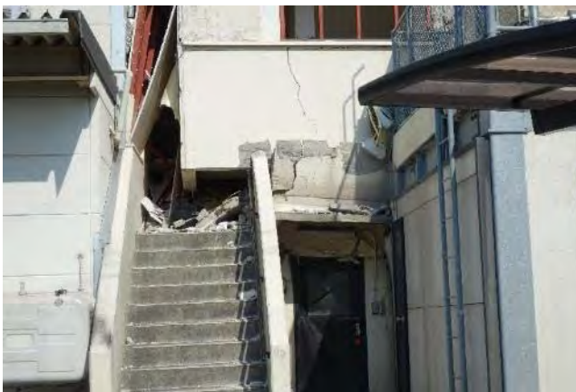
西側 1 構面のみ 2 F の層崩壊
