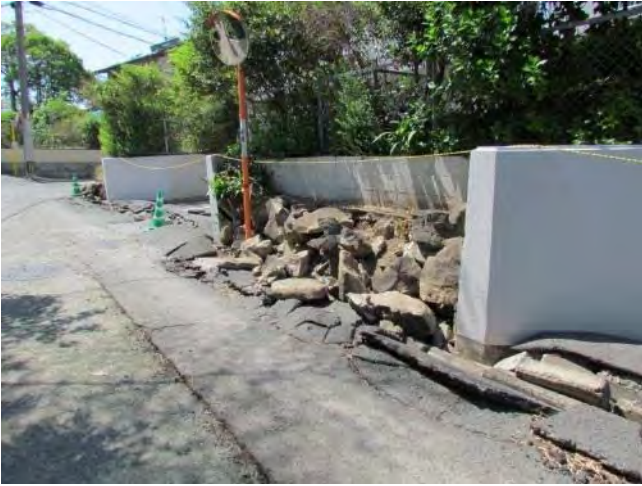
敷地周辺の石積み崩壊あり。
