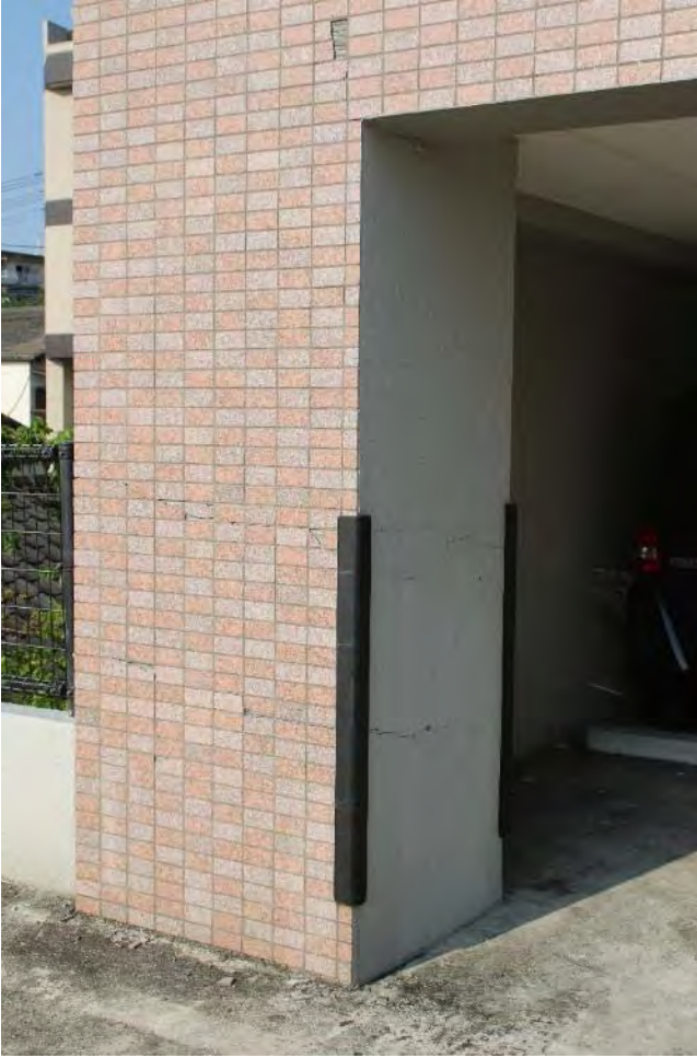
1F 南側隅柱曲げひび割れ。
