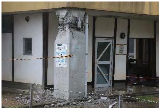
1Fピロティ柱の被害
