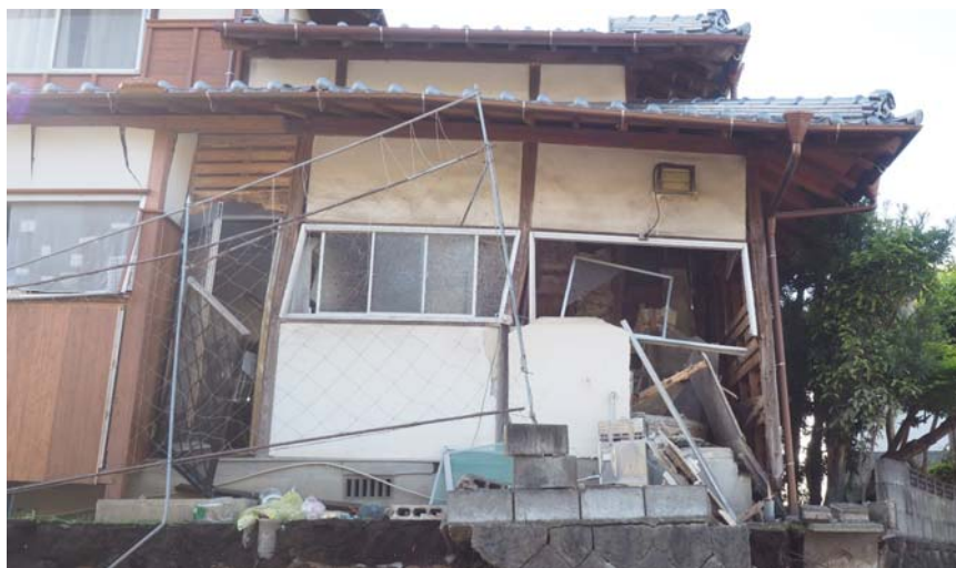
垂壁・腰壁周辺柱の折損
