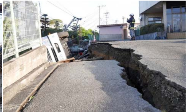
地盤崩壊により、高圧発電機車、電柱を巻き込みながらの落下(二次被害)
