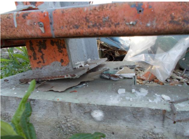
写真15 ⑨ 写真10の柱脚部 変形によるアンカーボルト破断 グラウトモルタル破壊
