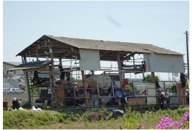
写真14 ⑨ 鉄骨造建屋 X・Y両方向に変形している ターンバックルのブレースは取り付けられているが効いていない ほぼラーメン状態で変形したと思われる
