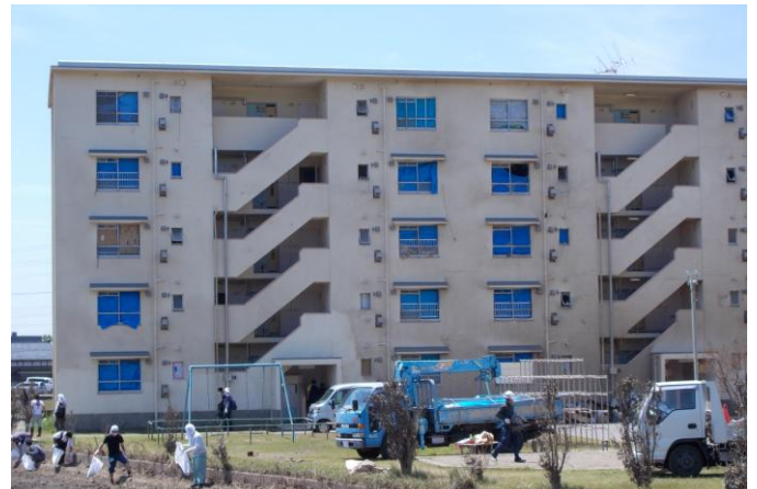
写真20 ⑩ RC造の共同住宅（北棟 南面） 窓ガラスが割れている箇所があるが 被害は少ない
