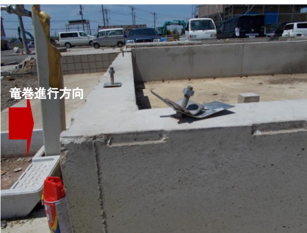
写真11 ⑦ 木造住宅の布基礎部分 アンカーボルトは、竜巻の進行方向に曲がっている
