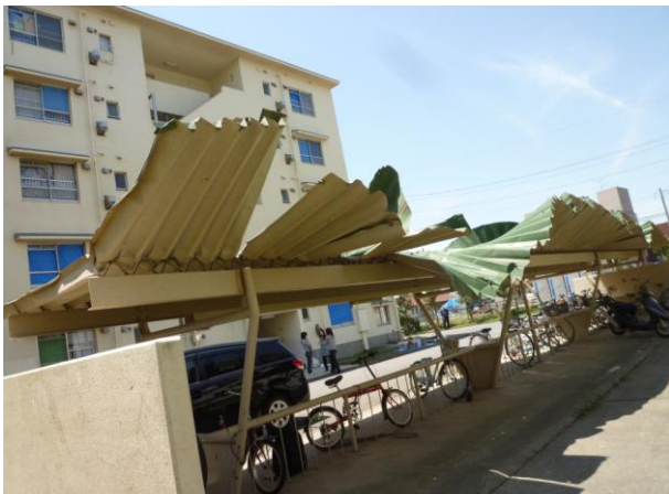
写真21 ⑩ 共同住宅の駐輪場 折板屋根の捲れあがり
