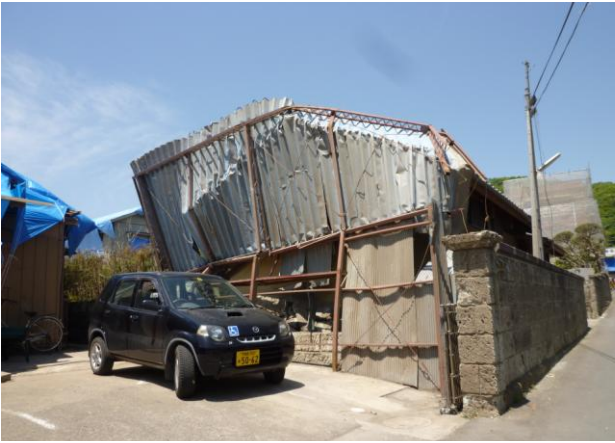
写真13 ⑧ 軽量鉄骨造の倉庫 外壁仕上材が捲れあがり建屋も大きく変形している ターンバックルのブレースは全く効いていない 外壁には無数の衝突痕が見られる
