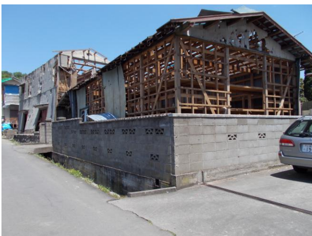
写真23 ⑪ 建屋の仕上材破損が甚大であるが ブロック塀は無被害 調査した全地域でこのような状 況が見られた
