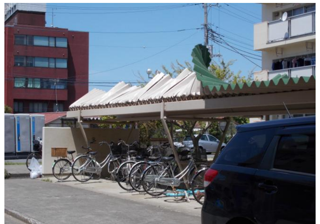
写真22 ⑩ 共同住宅の駐輪場 折板が完全に折れ曲がっている
