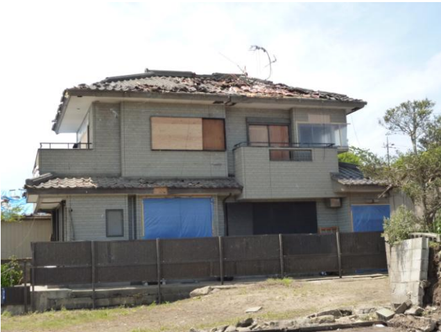
写真9 ⑤ 木造住宅の被害 屋根瓦は、2階部分が大きく崩落している
