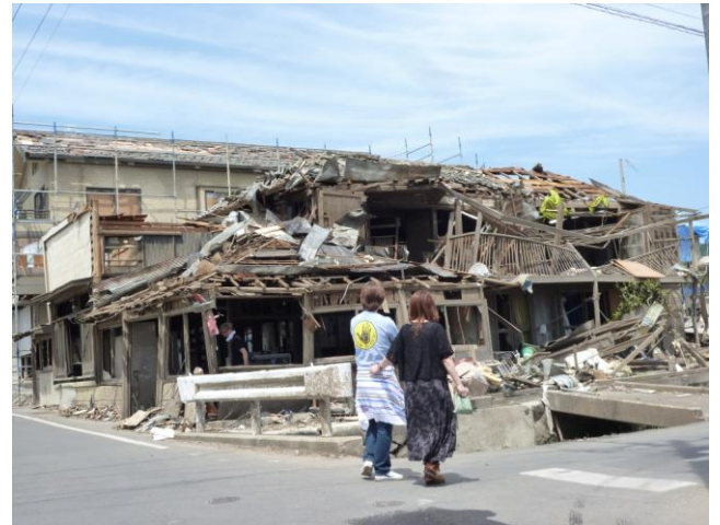
写真10 ⑥ 老朽化した木造の商店 構造体も損傷が激しく倒壊寸前である
