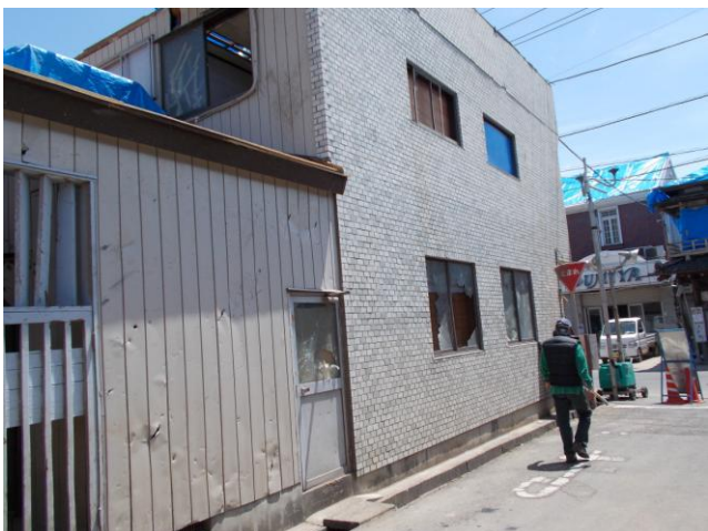
写真29 ⑯ タイル張の外壁は無被害
