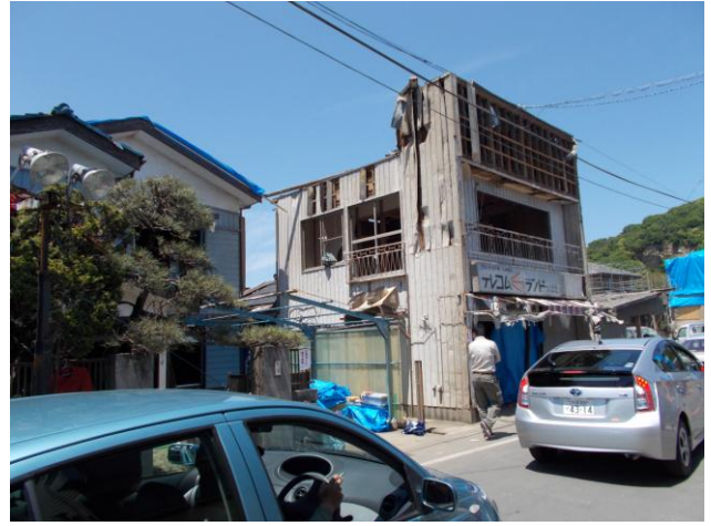
写真8 ④ 木造の店舗：開口部・上部の壁仕上げ材が全て吹き飛んでいる 建物の変形も大きい
