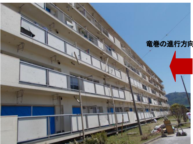
写真17 ⑩ RC造の共同住宅（南棟 南面） 竜巻の受風面 縦樋は全部破断，開口部も全消失だが RC構造体は、無被害
