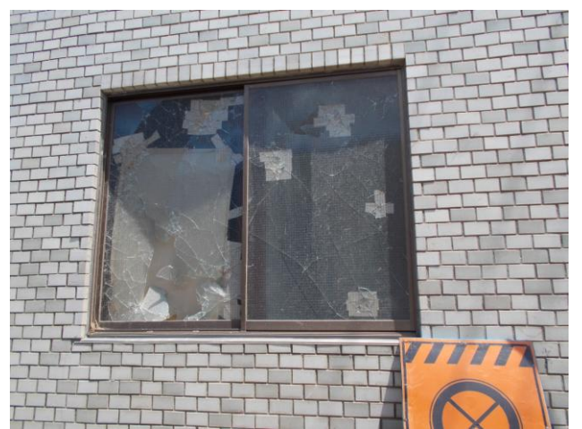
写真30 ⑯ 網入りガラスは，全破壊・破片の拡散を防止した模様だ
