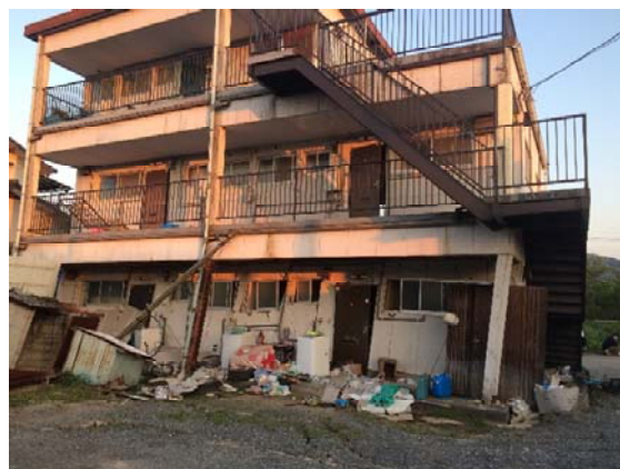
写真4 東西方向に傾いた鉄骨住宅
