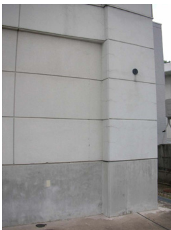
写真20 外壁のひび割れの様子。壁の右側(柱に近い部分)に縦ひび割れが生じている(柱のひび割れは今回の地震で生じたものではない模様)
