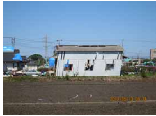
雇用促進住宅の南側にある倉庫？
