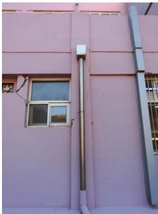
写真 12 柱の損傷（損傷度：II）
