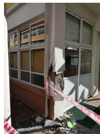
写真 3 損傷度 IV の柱
