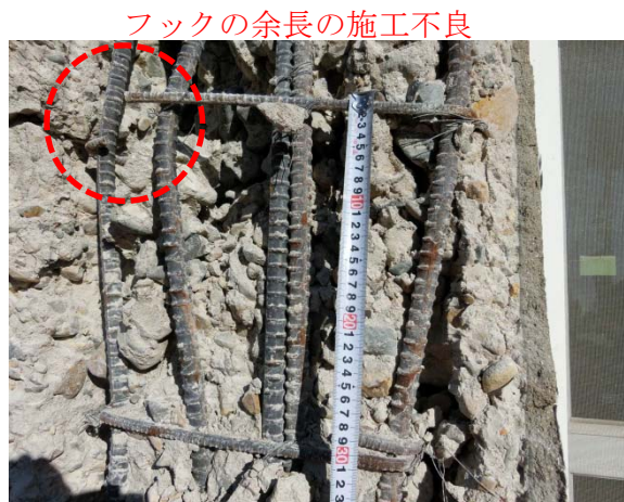
写真 5 補強筋間隔と 90°フックの施工不良
