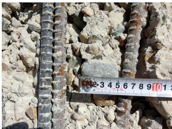
写真 4 50mm 以上の骨材が混入されている様子
