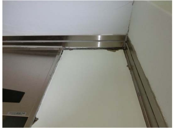
写真 20 エレベーター室と本館の間の損傷の様子
