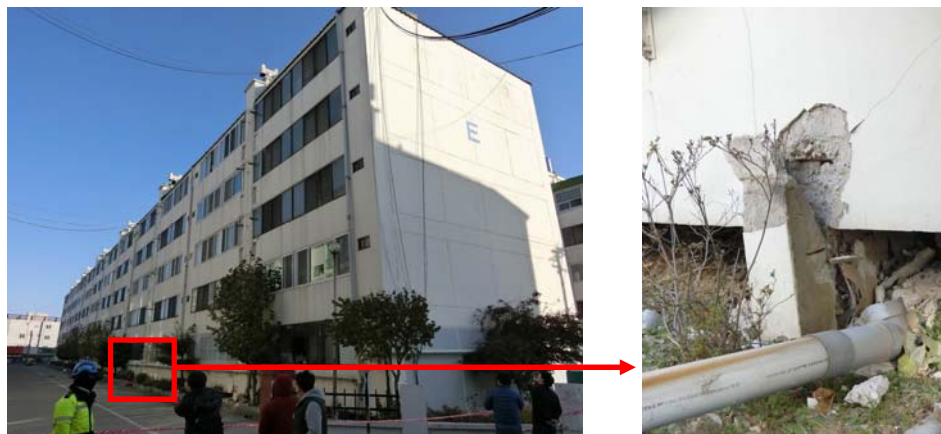
写真 38 D マンションの被害（建物の傾斜被害）
