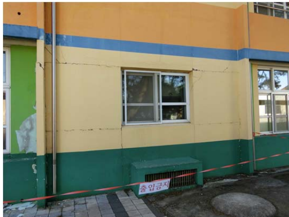
写真 29 組積造壁の損傷
