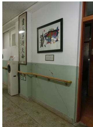
写真 13 組積造壁の損傷
