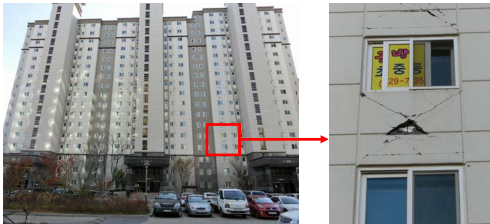
写真 37 T マンションの外壁の被害の様子
