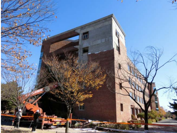
写真 24 組積造仕上げ材の被害
