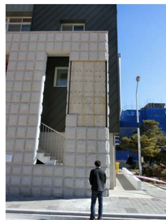
写真 23 屋内運動場の壁仕上げ材の剥落
