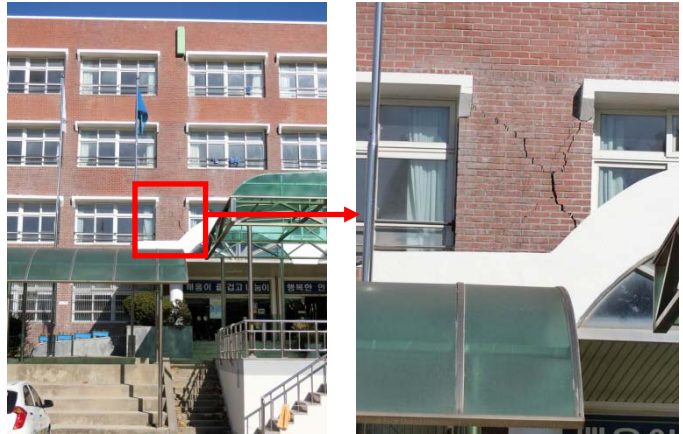
写真 11 学校建物の組積造仕上げ材の損傷
