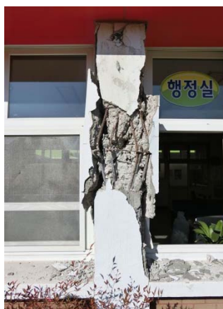
写真 2 損傷度 V の柱
