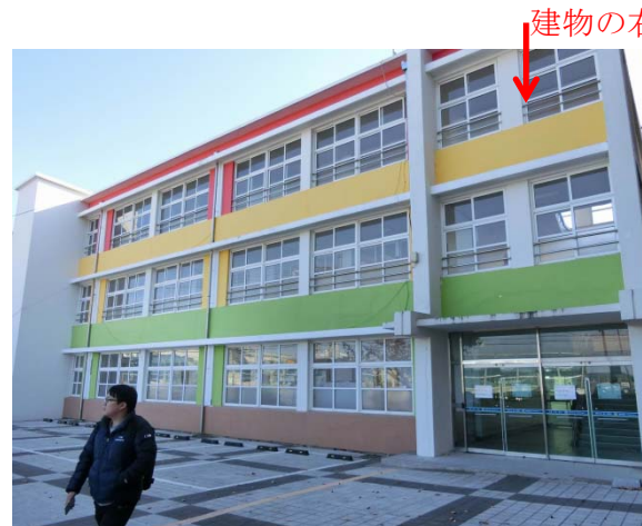
写真8 建物Bの損傷状況
