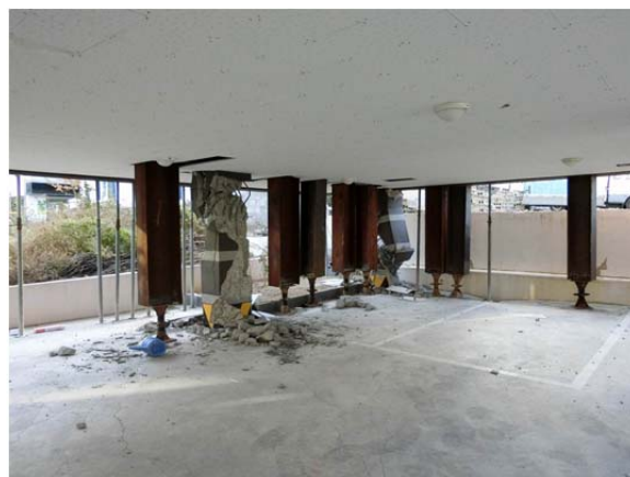
写真 33 1 階柱の損傷とサポートの設置様子
