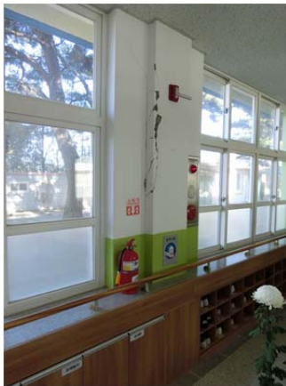
写真 28 柱の曲げひび割れ（損傷度：II）
