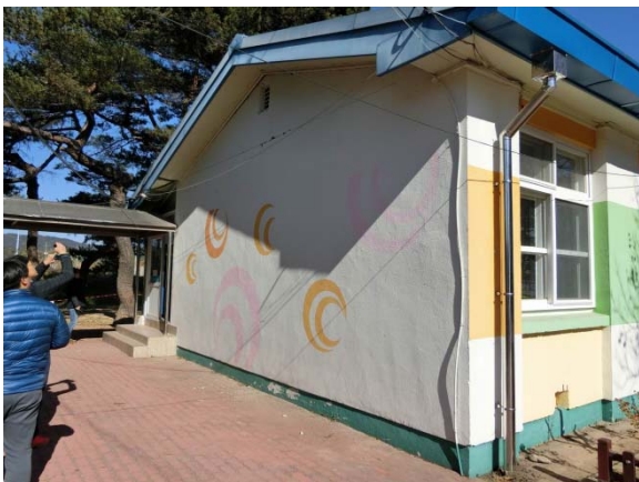
写真 30 給食棟の妻壁の損傷
