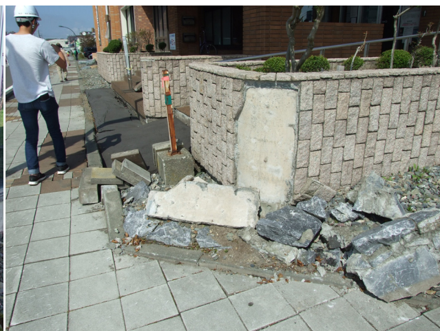
写真 4 外構部の損傷 ((2)庁舎 A)
