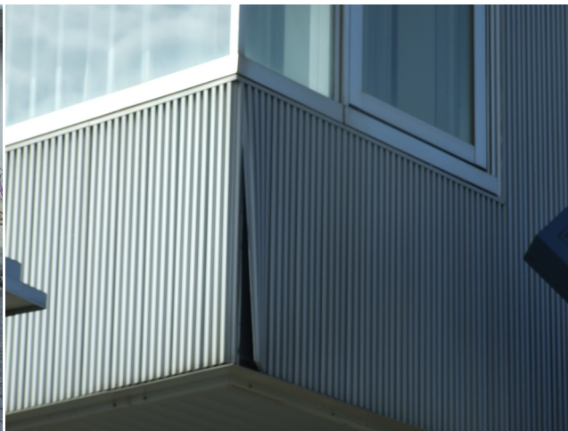
写真 2 外装材の変形 ((1)商業施設 A)
