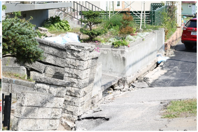
写真 45 液状化被害（地点 f）
