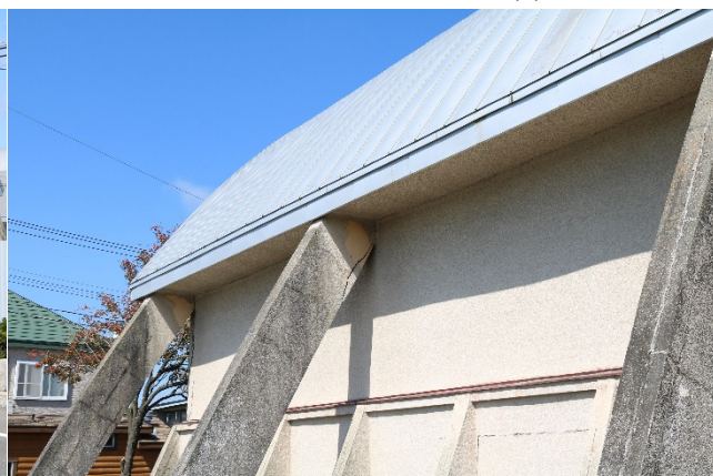
写真 14 バットレスのひび割れ ((6)建物 A)
