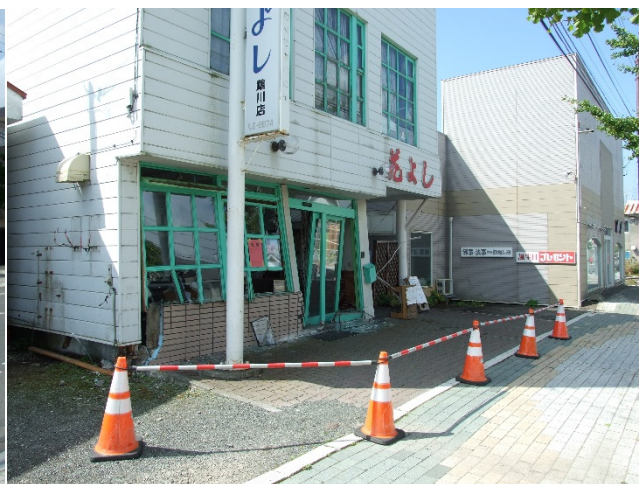
写真 8 木造店舗の 1 階部分の傾斜
