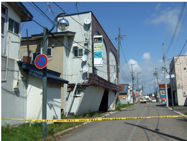
写真 9 木造店舗の1階の傾斜
