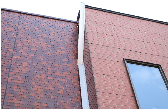
写真 33 渡り廊下の被害 (2) 庁舎 B)
