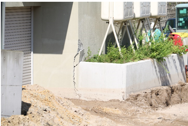
写真 40 液状化被害（地点 b）
