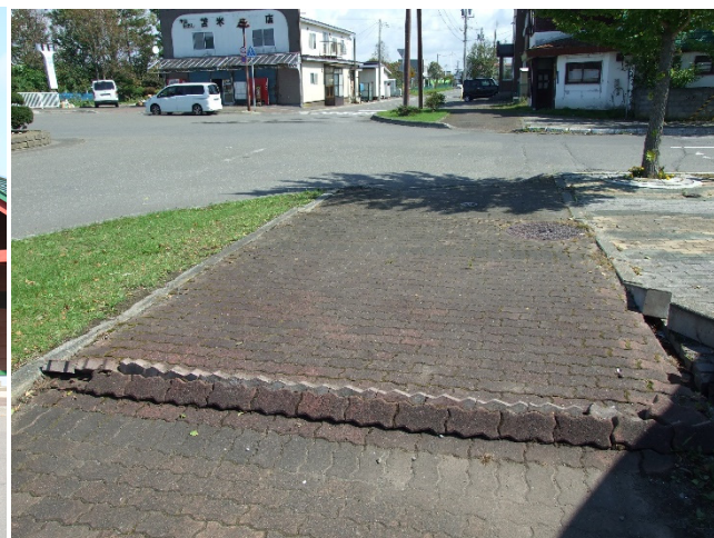
写真 12 駅前歩道の舗装の段差 ((5)鵜川駅前)
