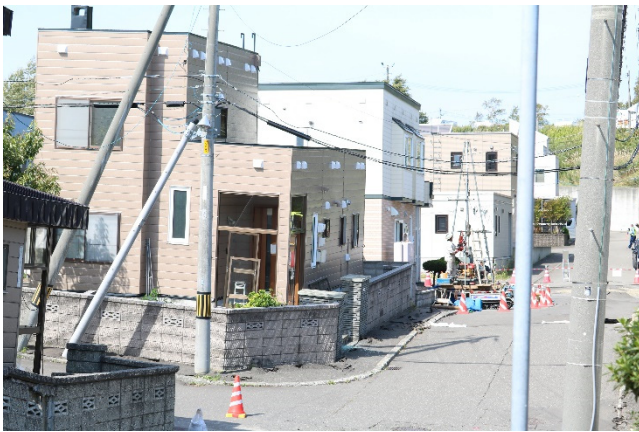
写真 46 液状化被害（地点 g）
