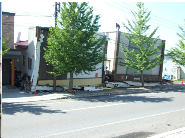
写真 10 木造店舗の倒壊
