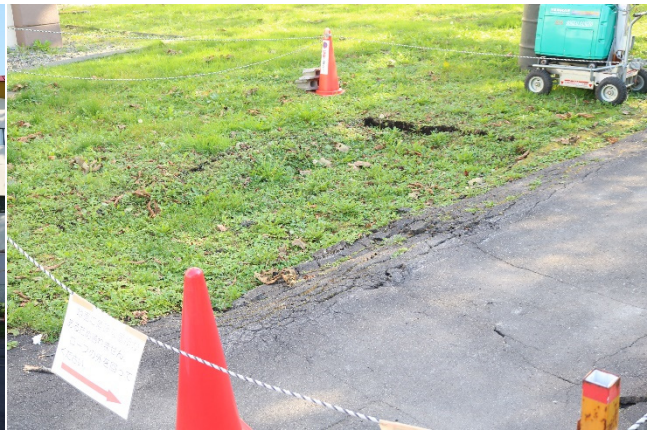
写真 35 地面の陥没(3) 小学校 B
