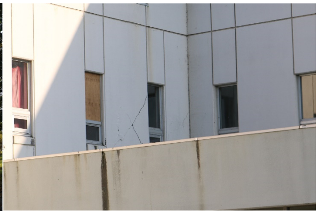
写真 37 2階壁のせん断ひび割れ ((4) 中学校 B)
