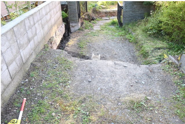
写真 60 地面にできた亀裂 (地点 b)
