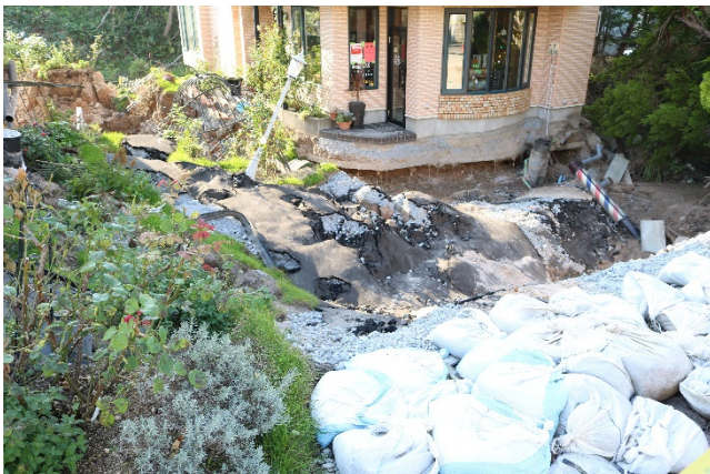
写真 62 地盤とともに滑り落ちた建物 (地点 c)
