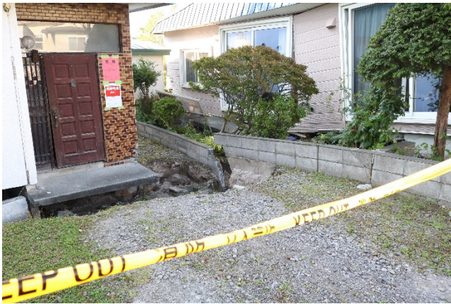
写真 58 地面にできた亀裂 (地点 a, 写真奥にずれたと見られる.)
