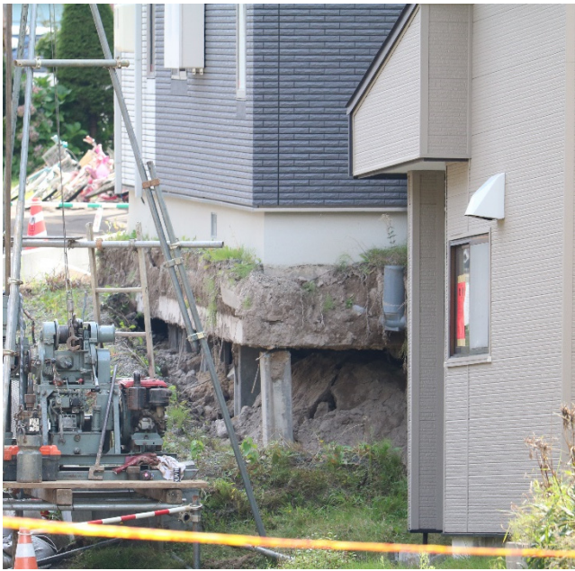
写真 50 液状化被害（地点 i）
