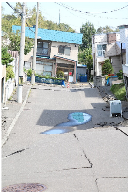
写真 48 液状化被害（地点 g）
