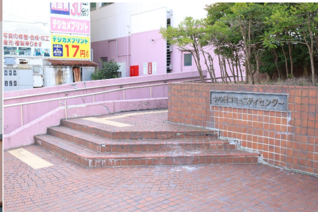
写真 54 外構の損傷 ((1)商業施設 B)
