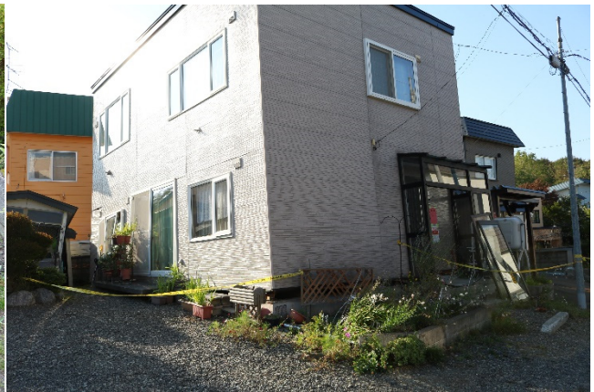
写真 61 奥に傾斜した建物 (地点 b)
