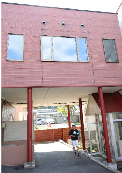
写真 31 渡り廊下の被害 (2)庁舎 B)
