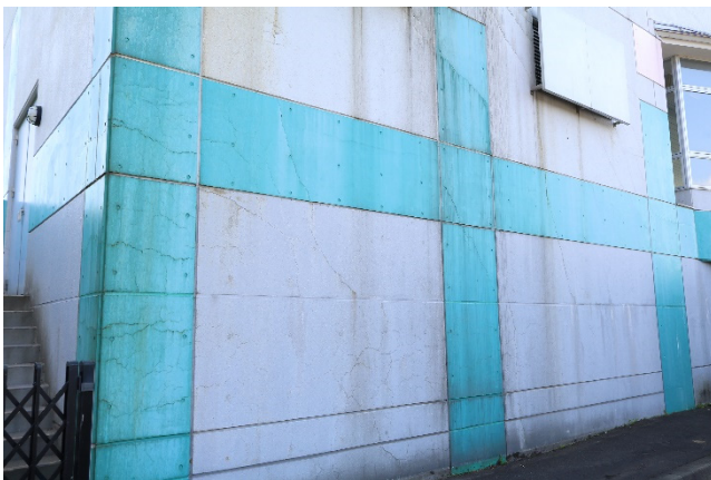
写真 19 壁のせん断ひび割れ (1) スポーツ施設)
