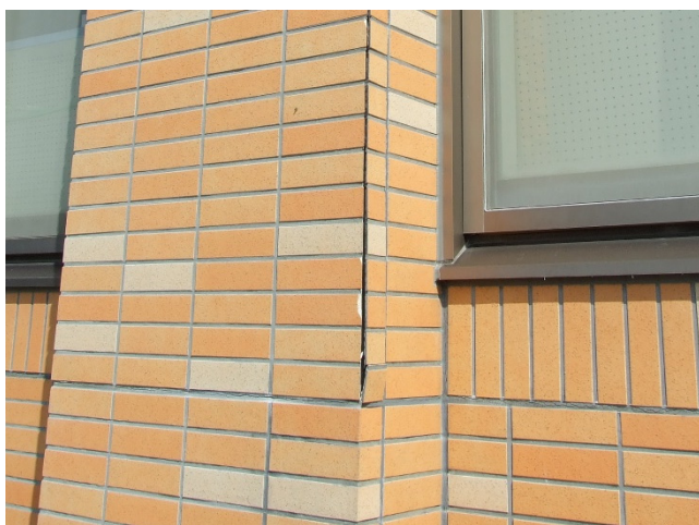
写真 5 外装材の亀裂 ((2)庁舎 A)
