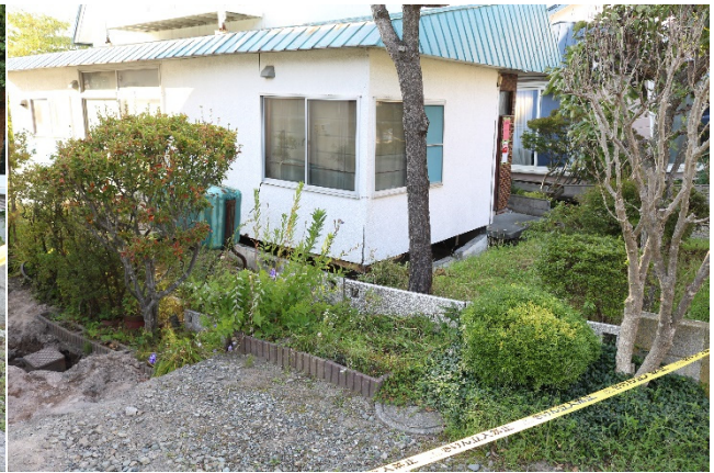
写真 59 一列に繋がった地面の亀裂 (地点 a)
