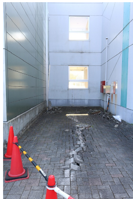
写真 22 外の地盤変状 ((1) スポーツ施設)
