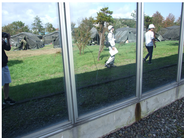
写真 3 ガラスの亀裂 ((1)商業施設 A)
