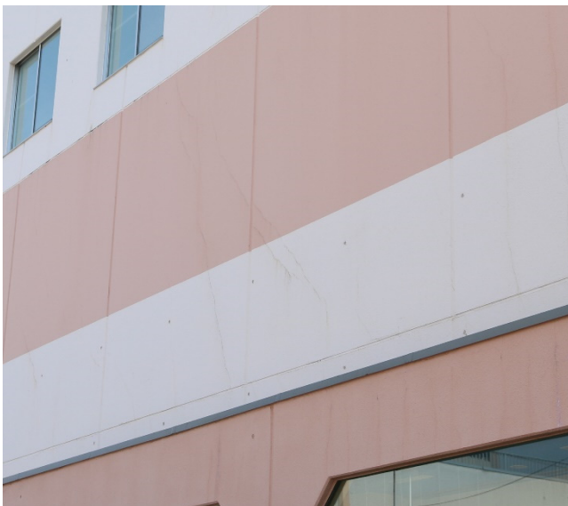
写真 53 壁のせん断ひび割れ ((1)商業施設 B)
