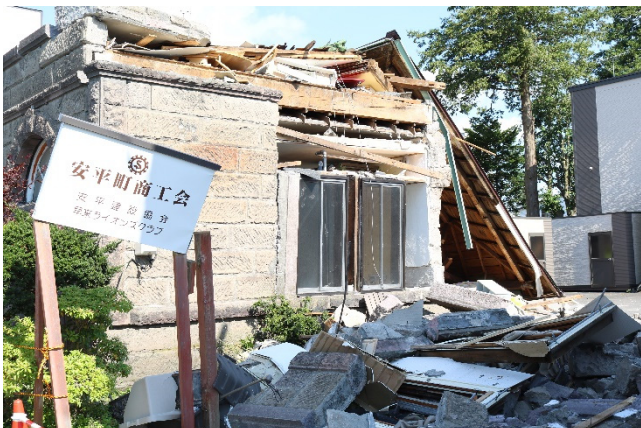
写真 25 組積造の被害
