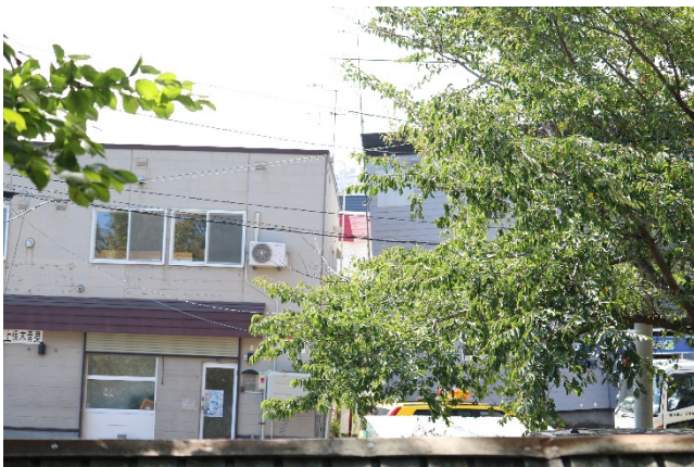
写真 42 液状化被害（地点 d）
