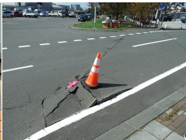
写真 6 周辺道路の亀裂 ((2)庁舎 A の前)
