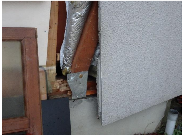
写真 26 筋違接合部の破壊
