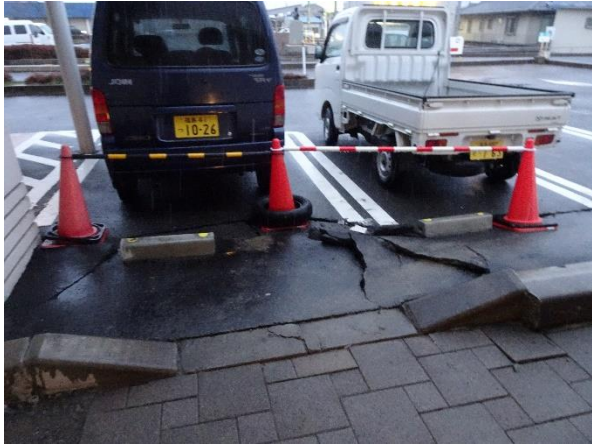
写真 16 旧棟前の地盤変状
