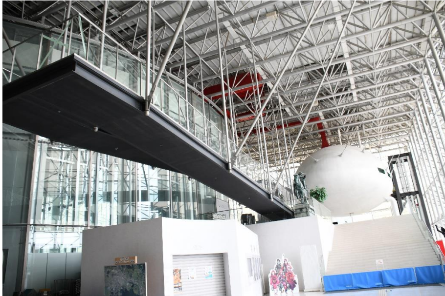
写真6 吊り廊下のガラスの損傷、吊り材の変形は東日本大震災の時に生じた。
