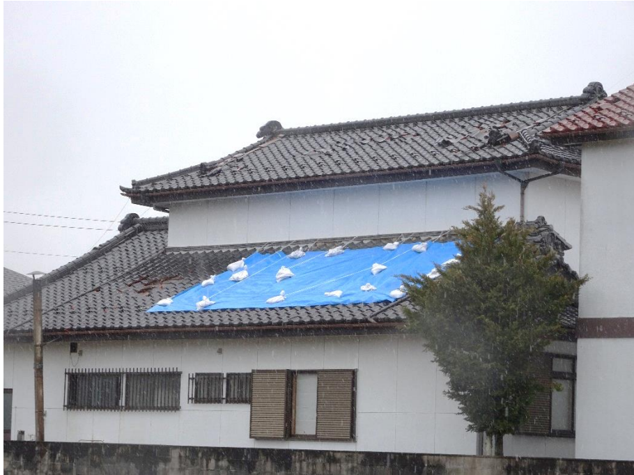
写真9 瓦屋根被害 それほど多くないがぽつぽつとみられる。
