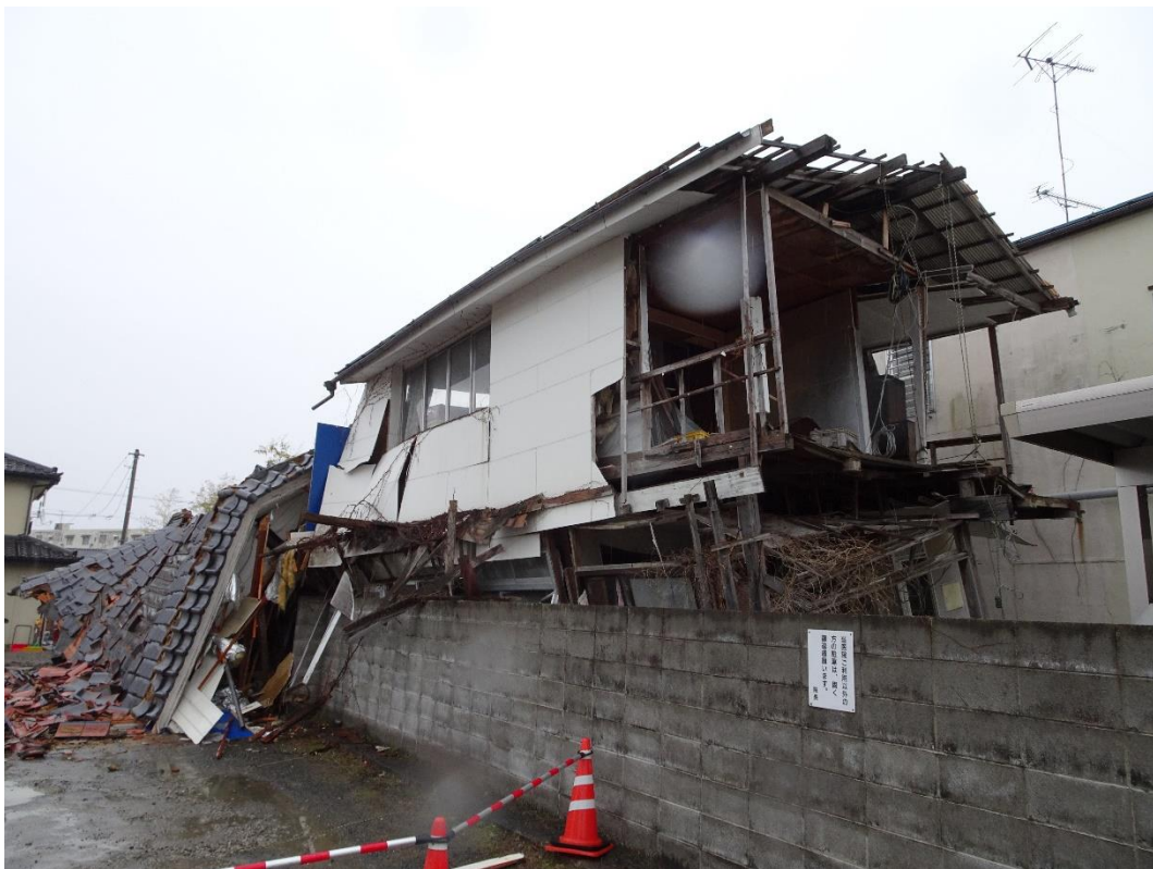
写真 18 倒壊して屋根が落ちた建物 手前の建物もほとんど廃墟となっている
