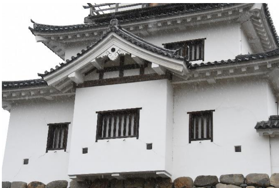
写真3 下層のクラックは今回初めて生じた
