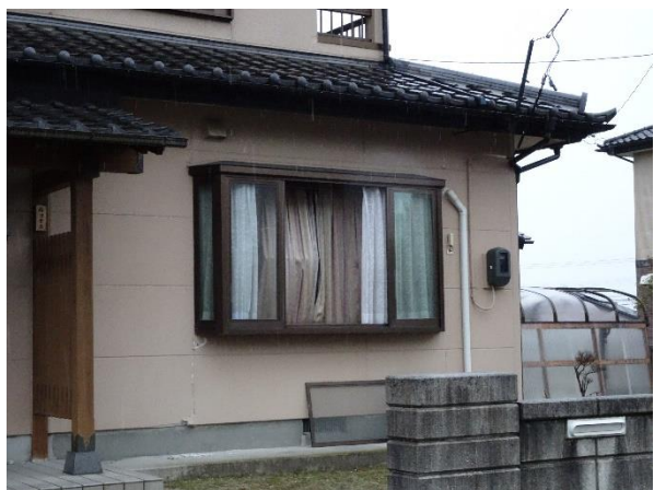
写真 23 壁面のクラック 窓の落下
