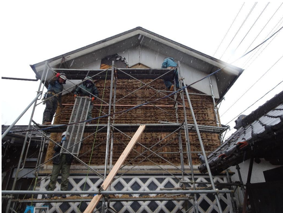
写真 8 土蔵外壁のクラック・剥落 今回の地震で生じた部分。一部には昨年の地震でクラックが入っていたところを応急的に補修していたところもあったそうだが、今回は大きく剥落したとのこと。
