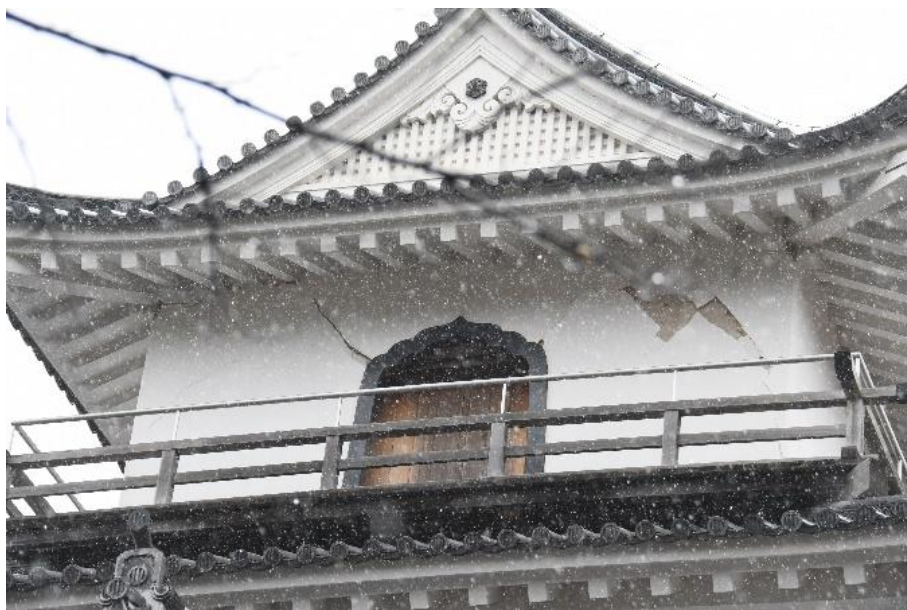
写真2 天守閣最上層 昨年の福島沖地震によるクラックが進展し、剥落が生じた
