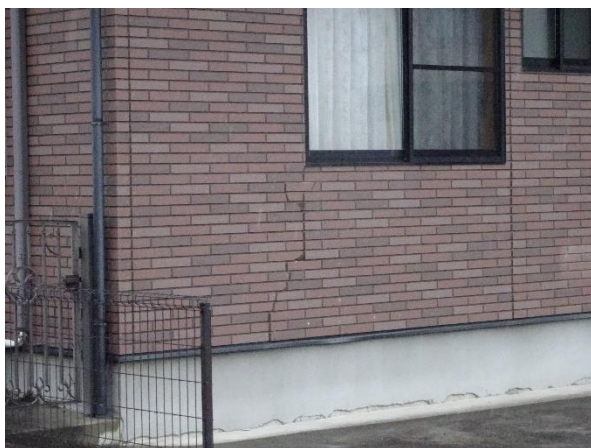
写真 22 比較的新しい家の壁面のクラック
