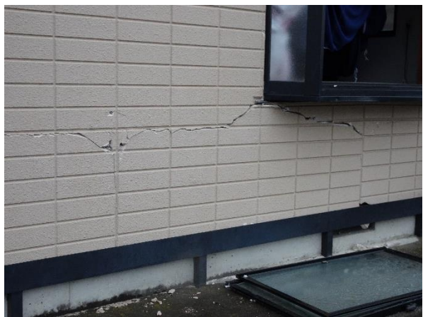
写真 21 大きく伸びるクラック
