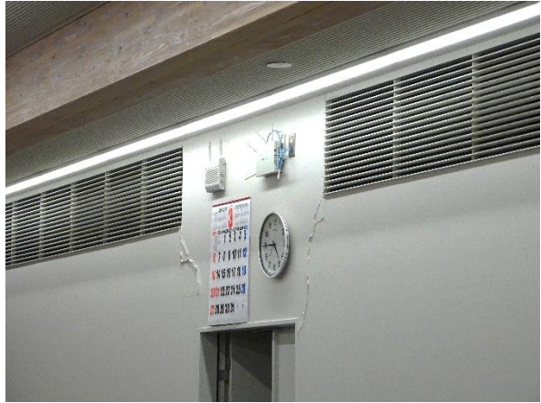
写真 14 壁のクラック
