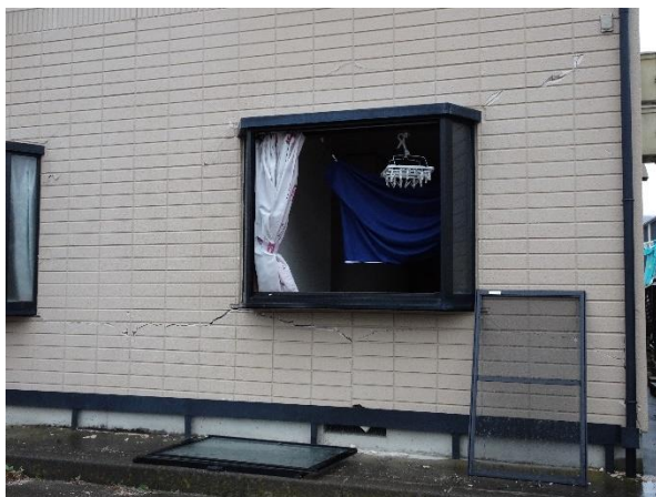
写真 20 壁面のクラック 窓も落ちている
