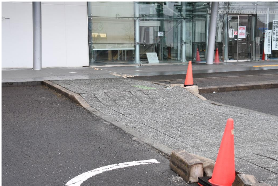
写真7 外回りの地盤変動。
