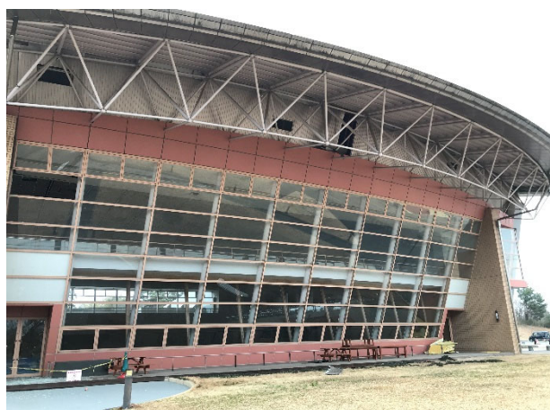
写真 6.3 S 造町営運動施設の壁とガラスの破損（新地町）
