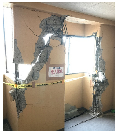
写真 4.4 ELV ホールの損傷状況（2 階）
