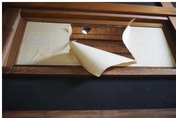
写真 3-8 室内の障子の剥がれ（角田市）
