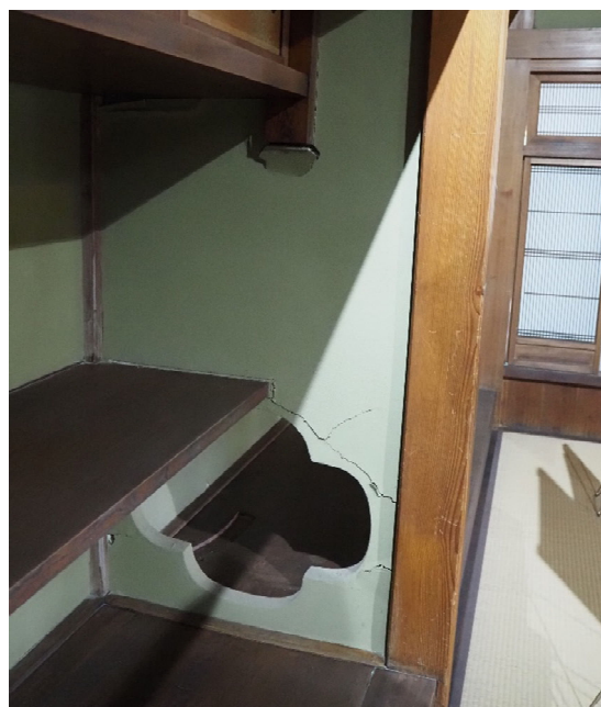
写真 3-10 床脇の天袋下げ束まわりの上塗り剥離や狝潜りでのヒビ割れ（角田市）
