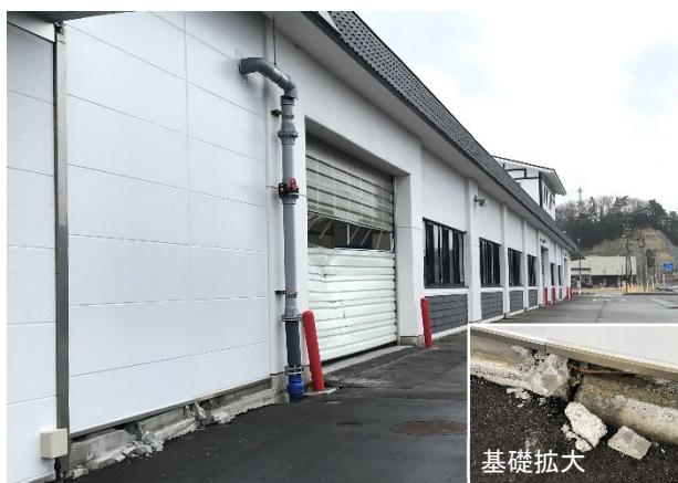
写真2.3 RC造卸売市場の基礎梁とシャッターの損傷
