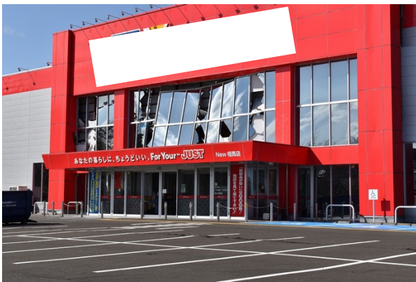
写真 2. 2. 10 嵌め殺しガラスの破損
