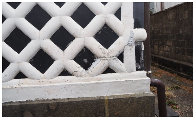
写真 3-5 応急的な海鼠壁ひび割れへの対応（登米市）
