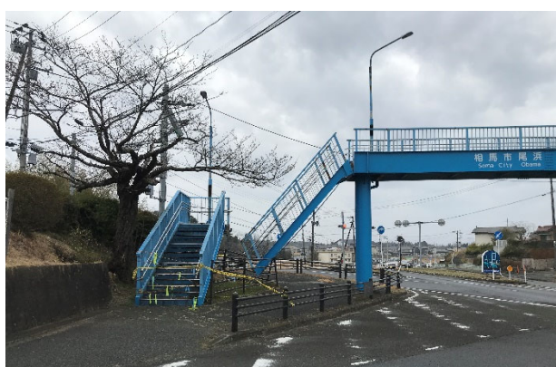
写真 2.9 歩道橋の崩壊
