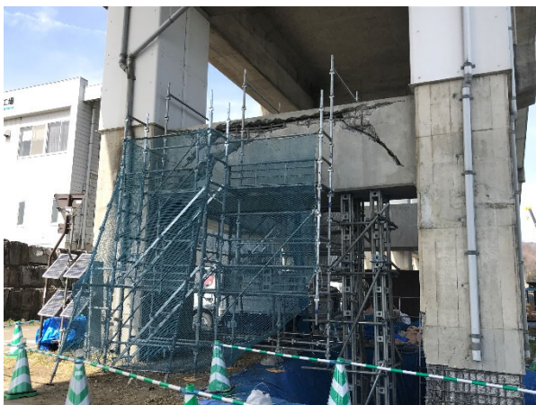
写真 3.1 高架橋梁の付着割裂破壊とせん断ひび割れ
