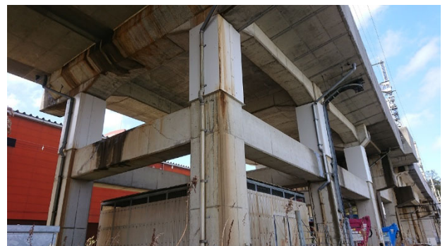
写真5 新幹線高架橋の被害
