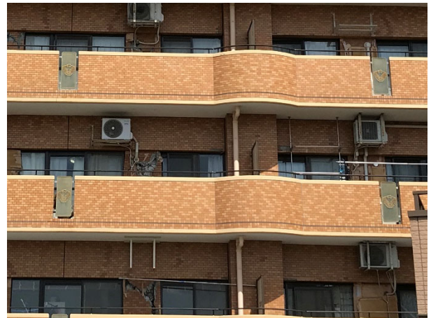
写真 4.2 バルコニー側の損傷状況（3～5 階）
