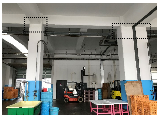
写真 2.7 RC 内柱柱頭の曲げひび割れ（図中点線枠）
