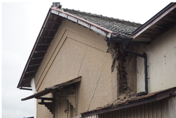
写真 3-3 土壁（中塗）の隅部の崩落（登米市）
