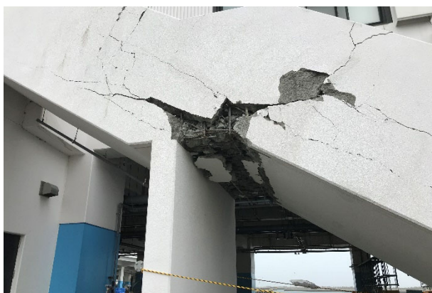
写真 2.4 RC 階段スラブの配筋が露出
