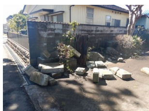
写真 30 石積みの塀の被害
