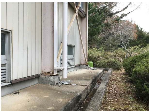
写真 6.1 S 造校舎の RC 基礎に生じた損傷（新地町）
