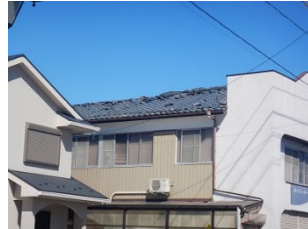
写真 24 瓦屋根の被害
