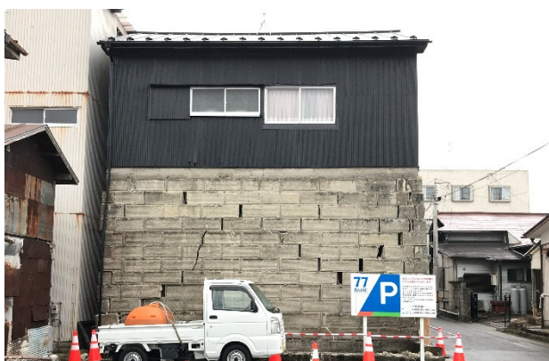
写真 2.8 組積造の損傷状況（市街地）
