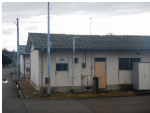
写真 41 瓦屋根の被害
