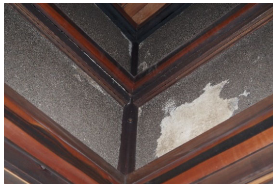
写真 4-2 旧安倍家住宅の室内土壁の剥落と長押の外れ
