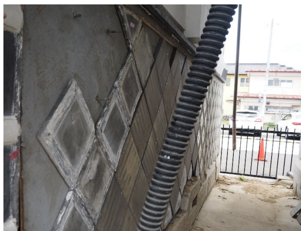
写真 3-2 2021 年地震から補修した海鼠壁の落下(角田市)
