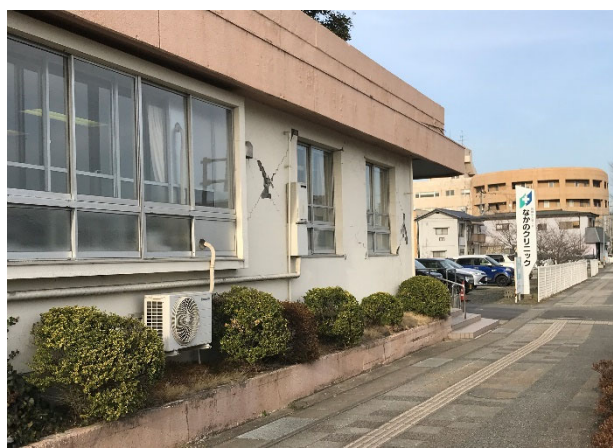
写真 5.2 雑壁のせん断ひび割れ（伊達市）
