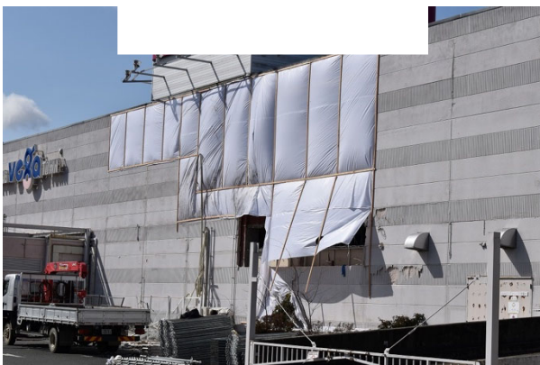
写真 2. 2. 11 外壁パネルの落下
