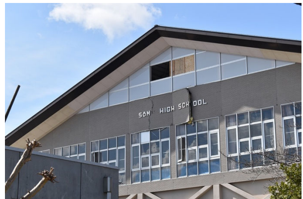
写真 2.2.9 外壁の面外振動
