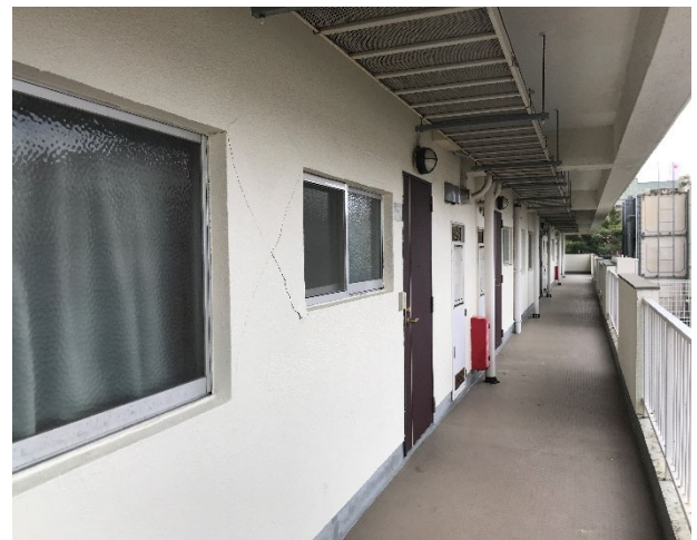
写真 7.2 復旧後に再び被災した集合住宅雑壁の損傷②
