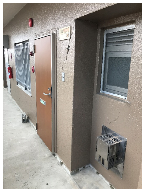
写真 7.3 復旧後に再び被災した集合住宅雑壁の損傷③ (玄関ドア・枠の改修後の雑壁損傷)
