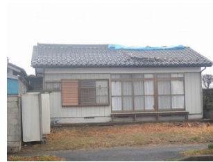
写真 35 瓦屋根の被害
