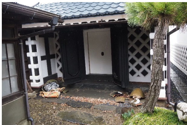
写真 3-4 戸前の観音扉による周辺物の破損（登米市）
