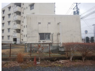
写真5 ポンプ室の傾斜
