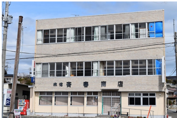
写真 2. 2. 12 引き違いサッシ窓の被害
