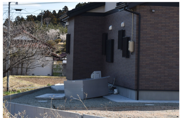
写真 2. 2. 16 エコキュートの転倒
