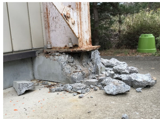
写真 6.2 RC 基礎の損傷（写真 6.1 右奥の基礎を拡大）
