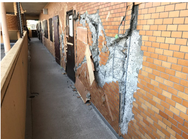
写真 4.3 玄関側の損傷状況（2 階）
