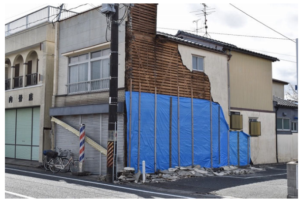
写真 2. 2. 15 ラスモルタルの剥落
