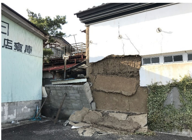
写真 5.1 土壁とブロック塀の倒壊（桑折町）
