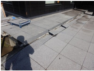
写真 21 相馬市役所外周の 舗装タイルの被害
