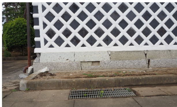
写真 3-6 化粧基礎の補修材割れと当初材とのズレ（角田市）
