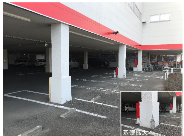
写真 4.5 S 造ピロティの RC 造基礎に生じた曲げ圧壊
