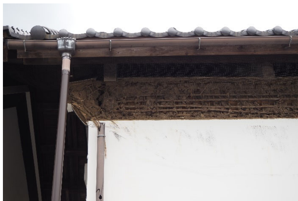
写真 3-9 土蔵鉢巻の補修部分の崩落（角田市）
