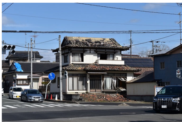
写真 2. 2. 13 瓦屋根の被害
