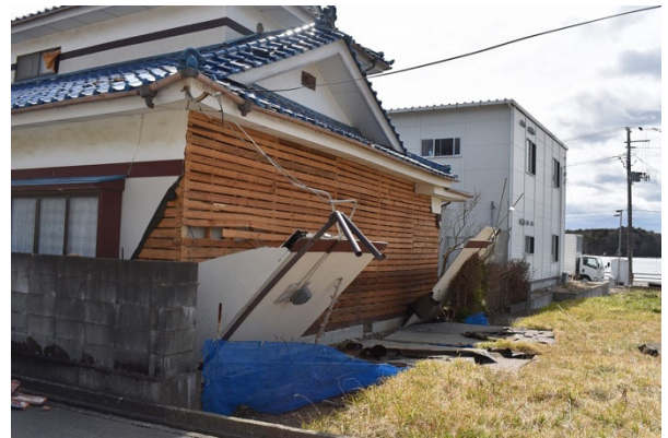
写真 2. 2. 14 ラスモルタルの剥落
