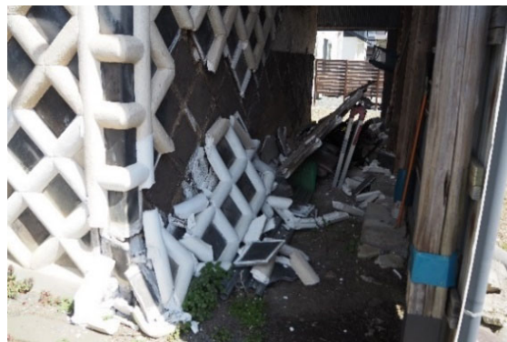
写真 4-1 旧安倍家住宅土蔵の海鼠壁の落下
