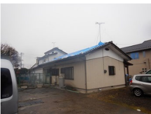
写真17 瓦屋根の被害
