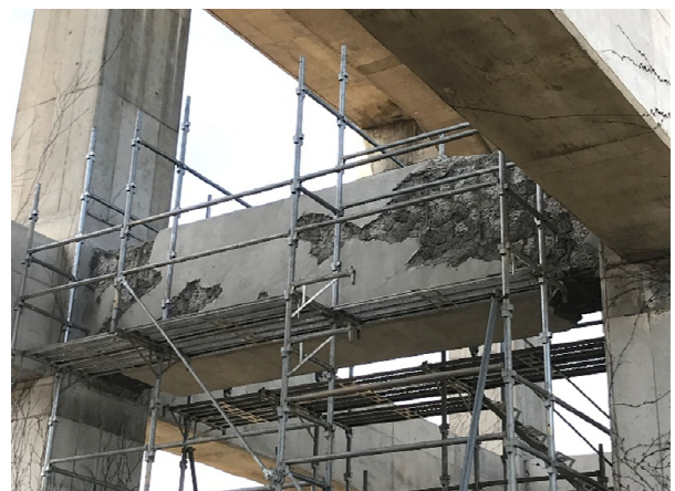
写真 3.2 高架橋の梁端ヒンジに生じた曲げ破壊
