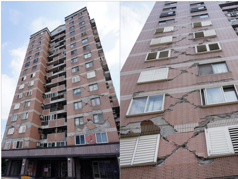
方立壁のせん断破壊(南棟の南西構面)
