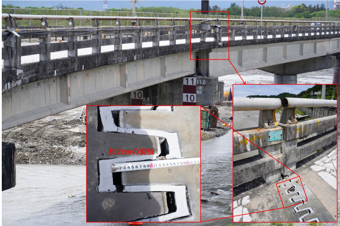
橋桁の変位(P13)
