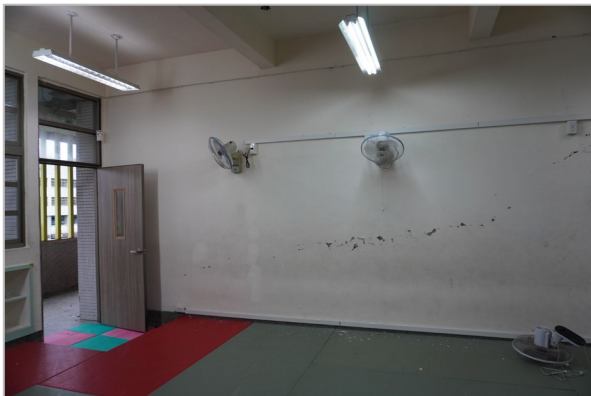
校舎 3:レンガ壁のせん断ひび割れ
