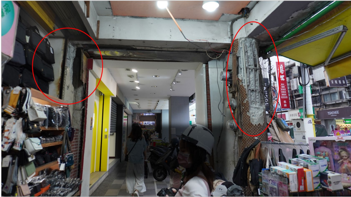
柱頭のせん断破壊(細径 PVC パイプの埋め込みあり)
