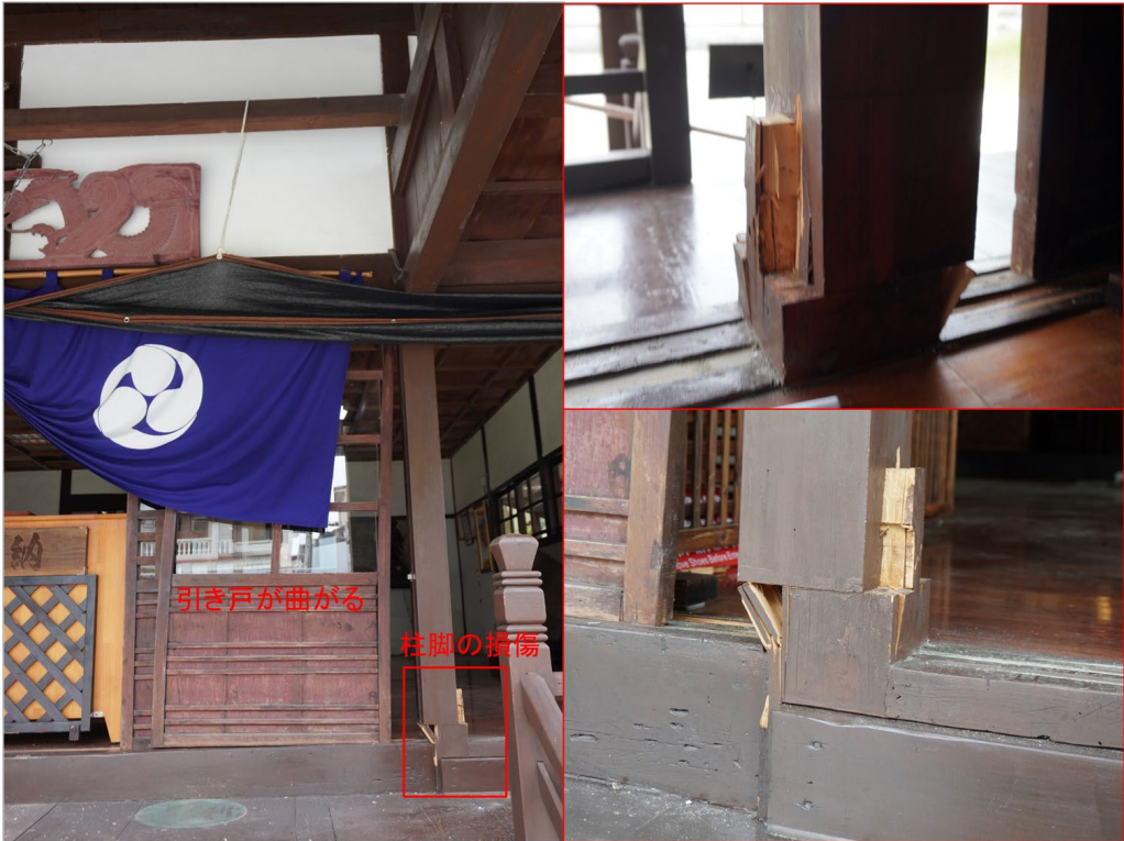
本殿柱の損傷
