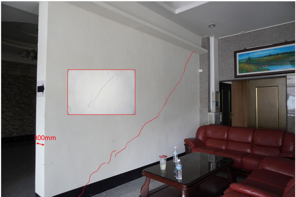
建物南側の棟内の増設壁のせん断ひび割れ
