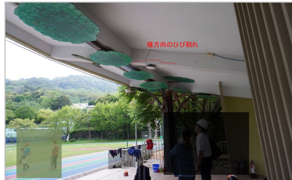
グラウンド前: 庇梁に横ひび割れ Figure 63 学校 TP3 の被害状況
