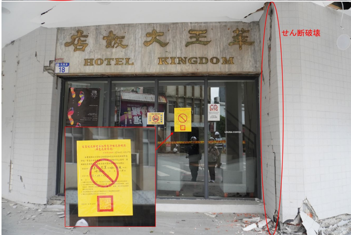
Figure 19 建物 H9 の被害状況
