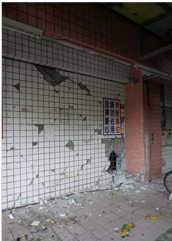
RC 雑壁の損傷
