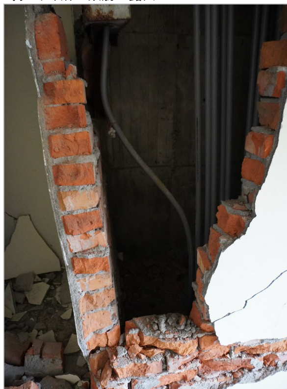
配管周りのレンガ雑壁の崩落
