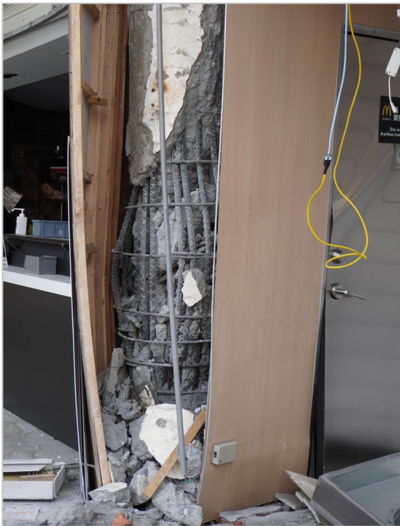
室内柱の損傷状況
