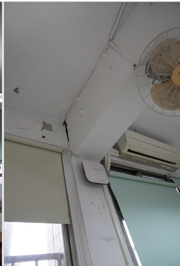
校舎 1: 梁 Steel cladding 境界部亀裂
