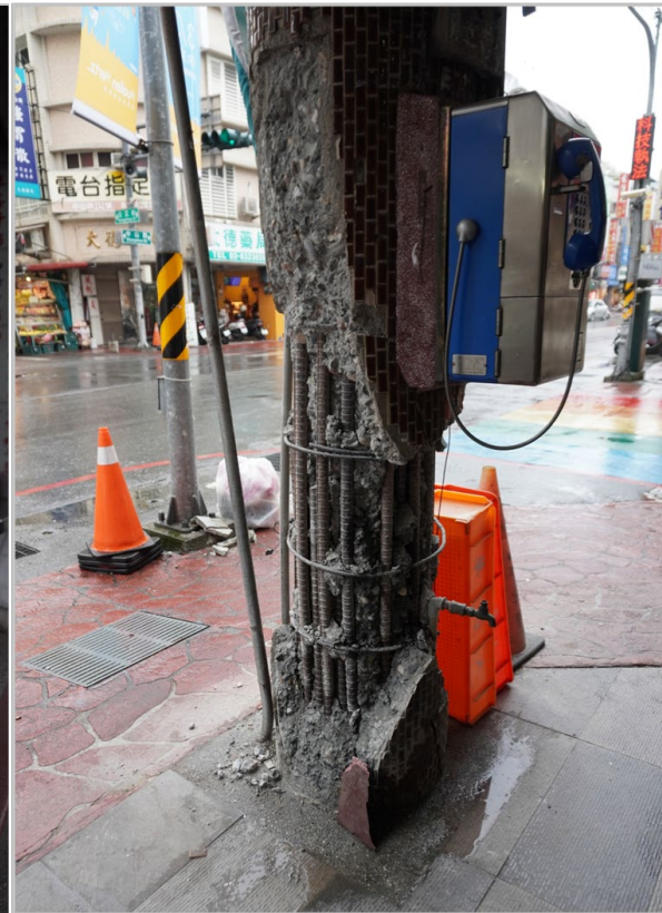
柱脚のせん断破壊
