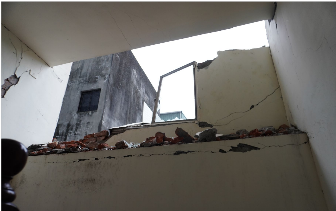
開口付階段室外壁(レンガ壁)の崩落
