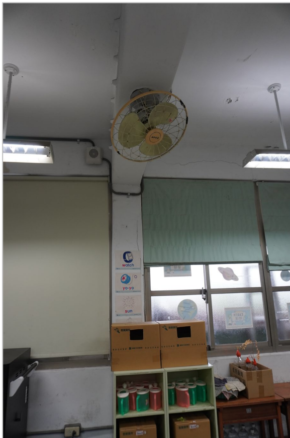
校舎 1 柱・梁に主筋に沿ったひび割れ
