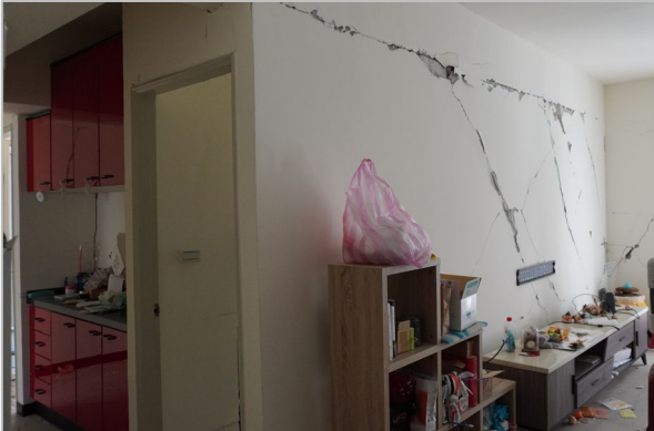
レンガ壁のせん断破壊
