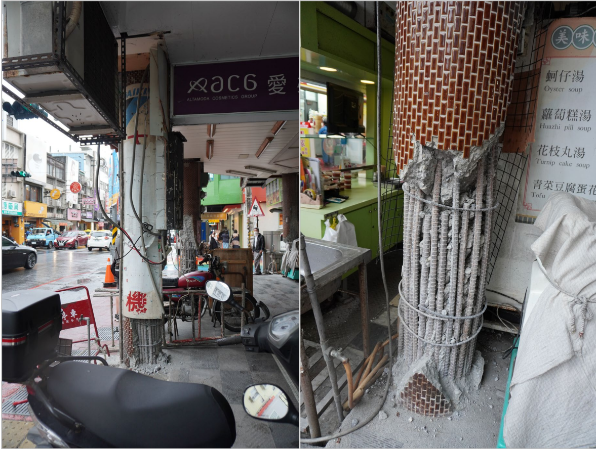
Figure 26 建物 H14 の被害状況
