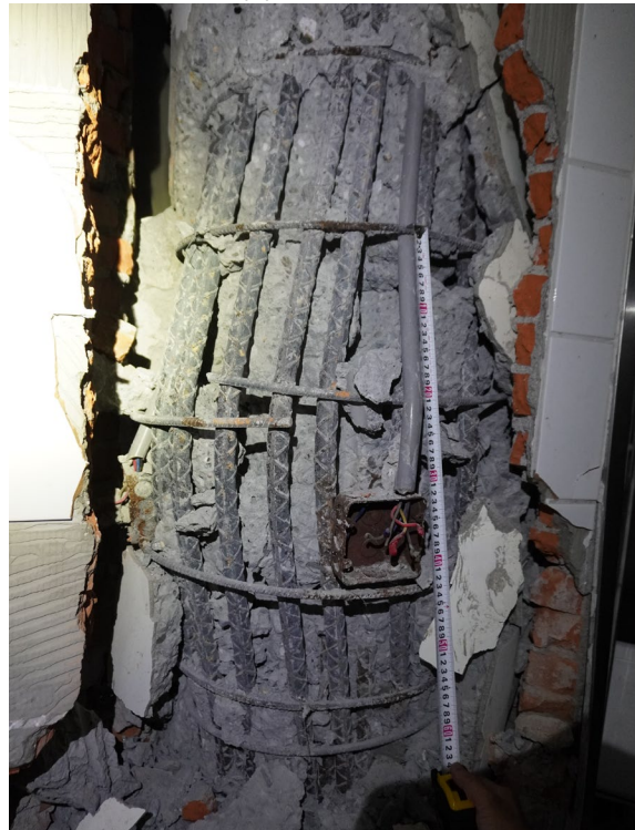
室内柱の損傷状況
