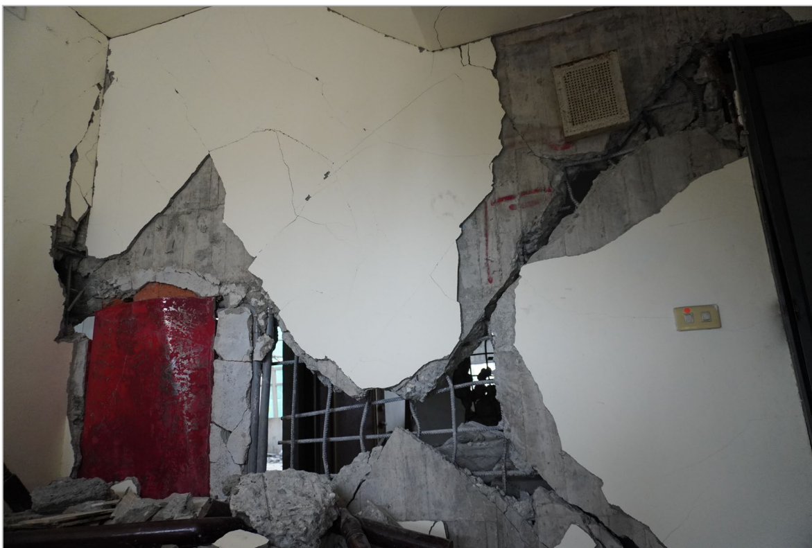
階段室周りのRC雑壁のせん断破壊
