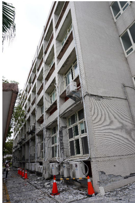
建物外観(北側から・同様に1階の損傷が大)
