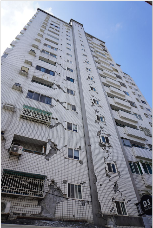
上階まで開口横のRC雑壁のせん断破壊
