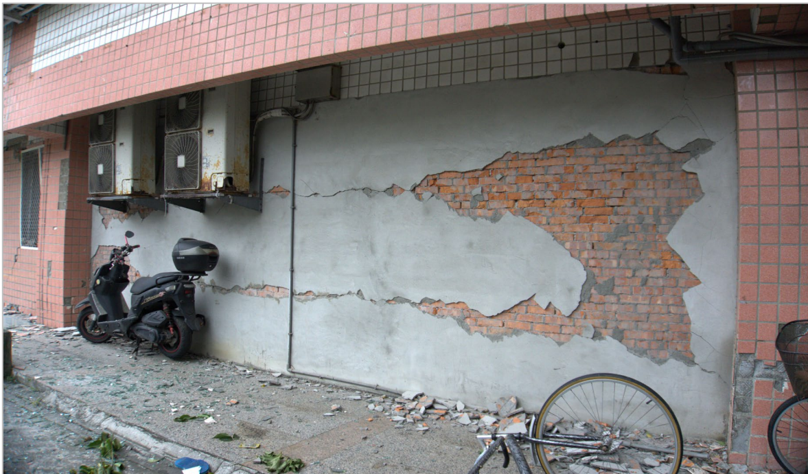
レンガ壁の損傷
