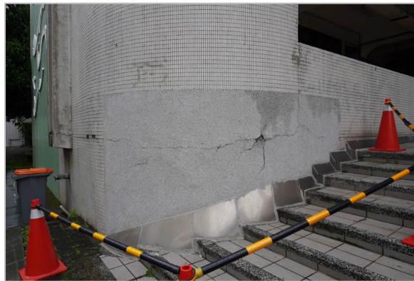
校舎1:RC 曲面外壁の損傷
