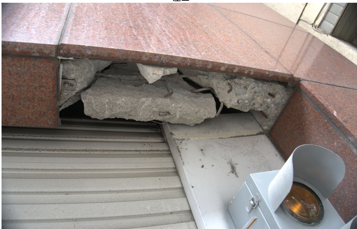
RC 垂壁の損傷
