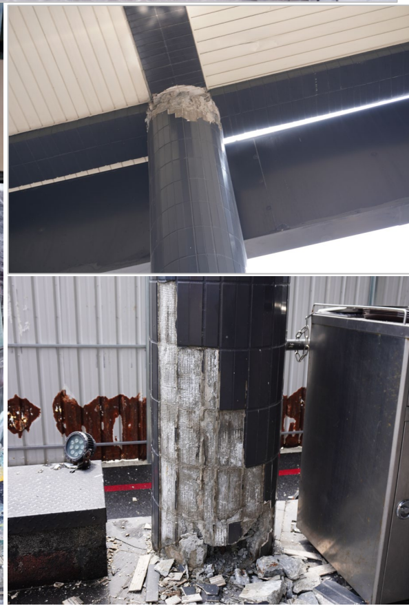
(b) 柱頭柱脚の曲げ破壊
