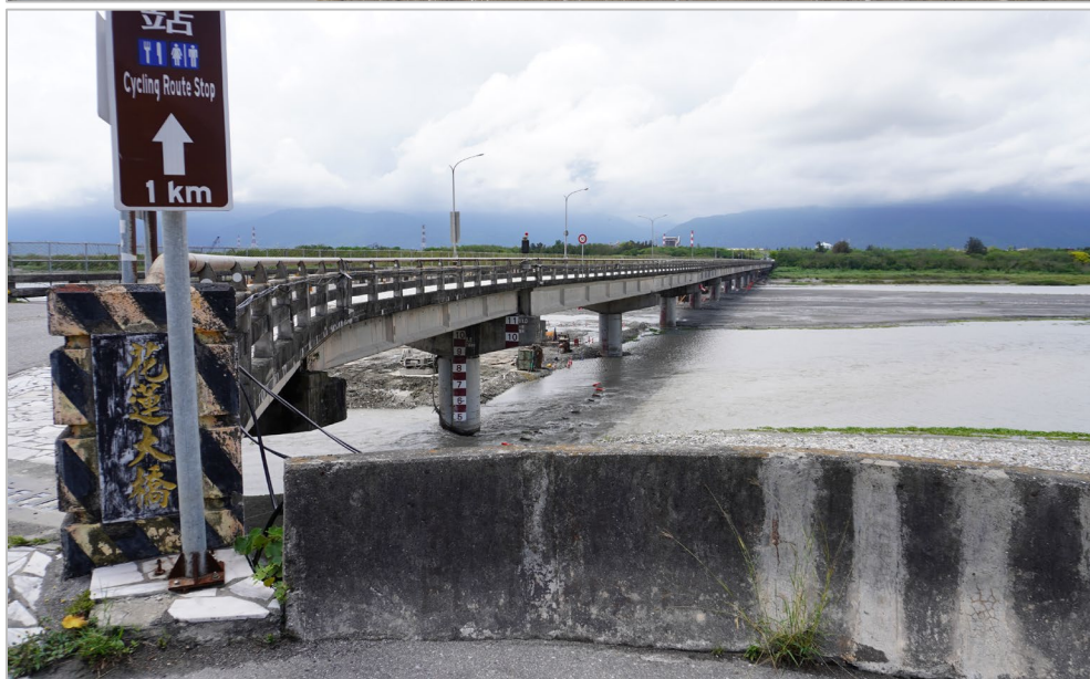
Figure 51 橋梁 J5 全景(上:南東より, 下:東より, 川に沿って断層が走る)
