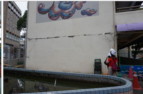
左写真の壁を外から
