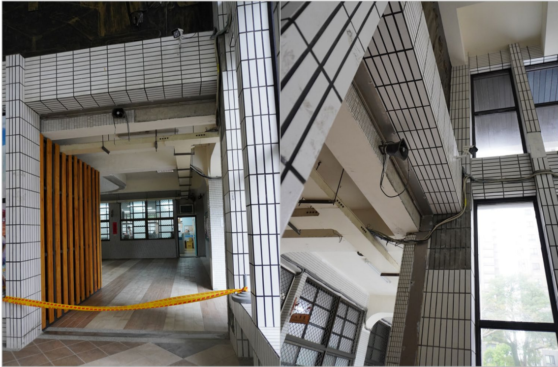
校舎 1: Exp.J 部の損傷(タイルが剥がれるなど)
