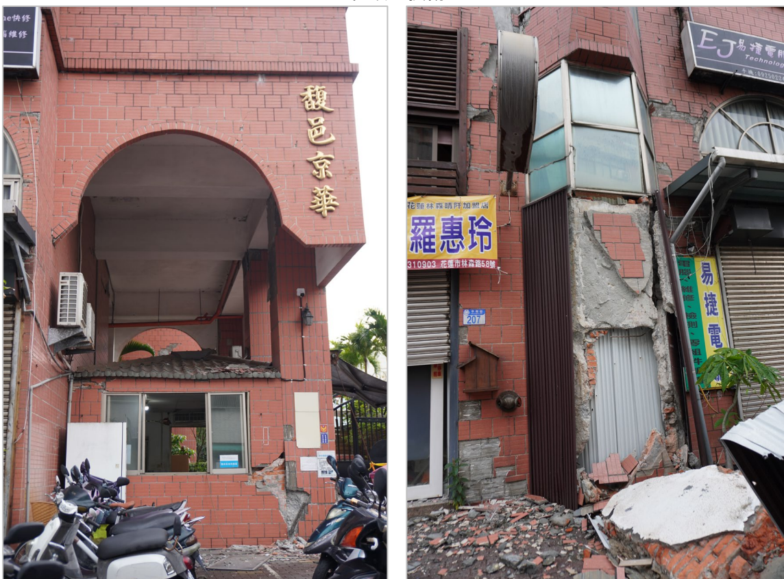
北東側の棟のレンガ壁損傷
