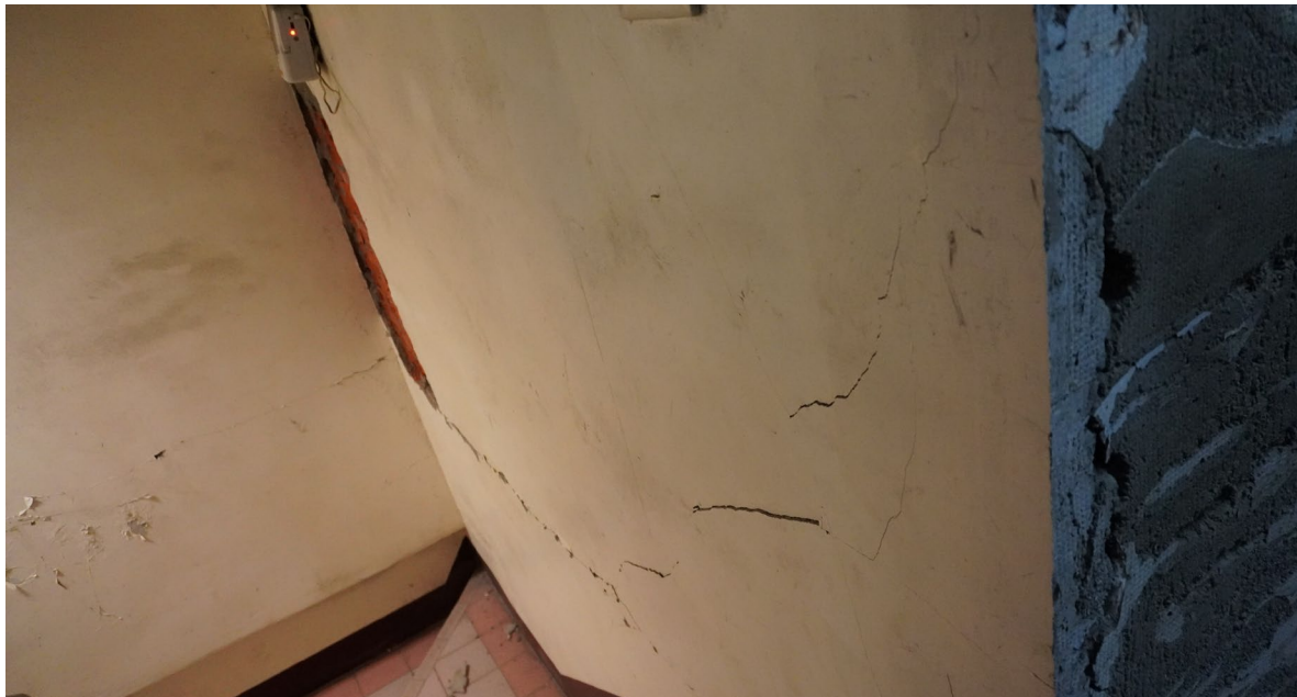
階段室まわりのレンガ壁のせん断破壊(例:1階→B1階の壁)
