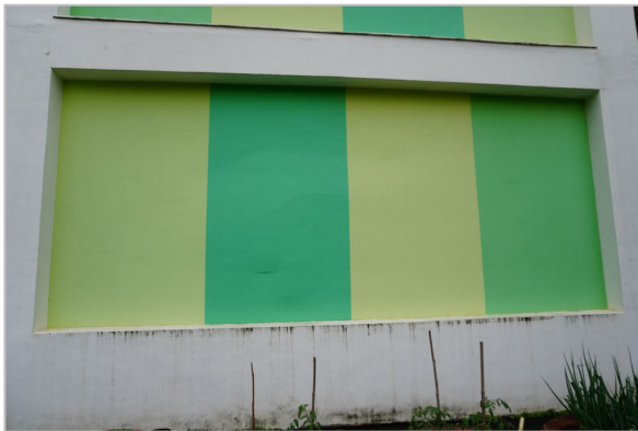
校舎1:壁のせん断ひび割れ(東構面)
