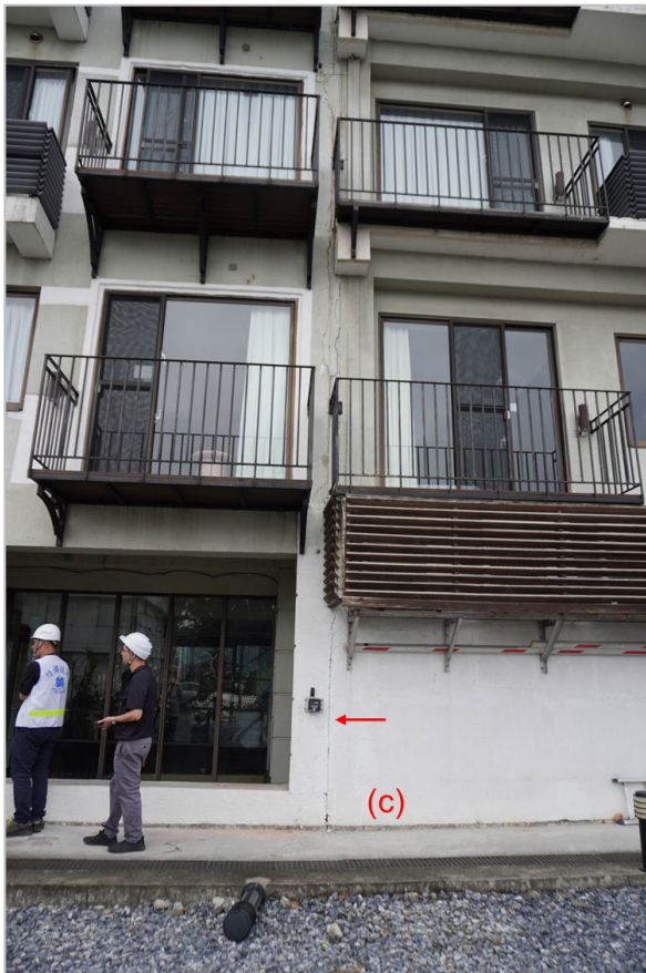
(c) 棟境界のひび割れ
