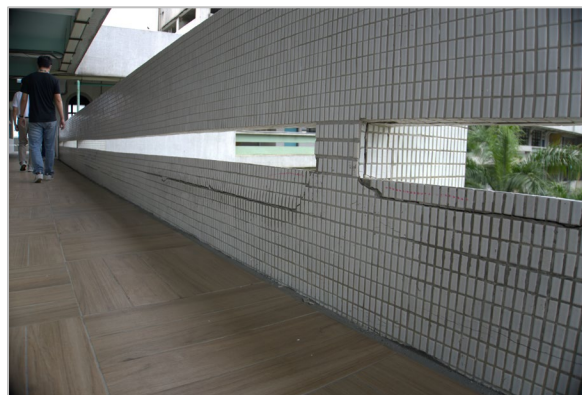
校舎3:外廊下腰壁の横方向の亀裂
