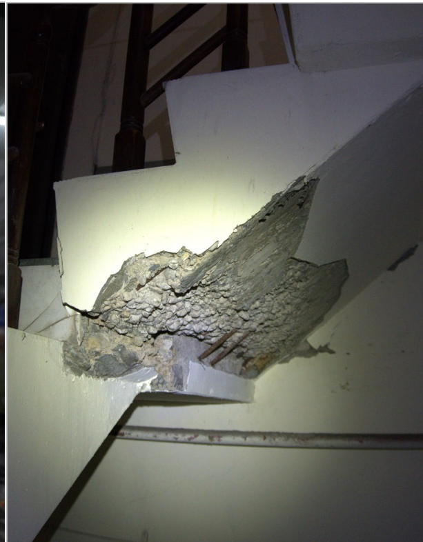
階段スラブの損傷
