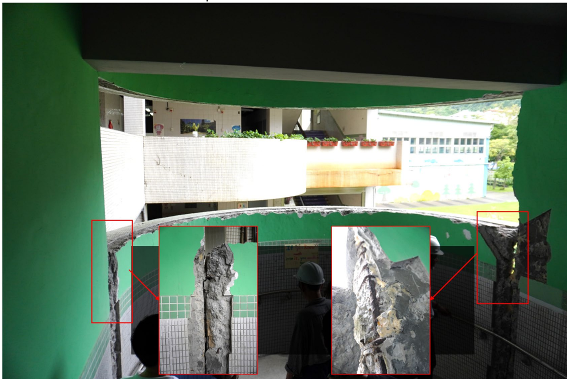
校舎 1: 東側中央階段室の腰壁とRC 柱境界の損傷(2018 年に損傷→修復→同じ被害)
