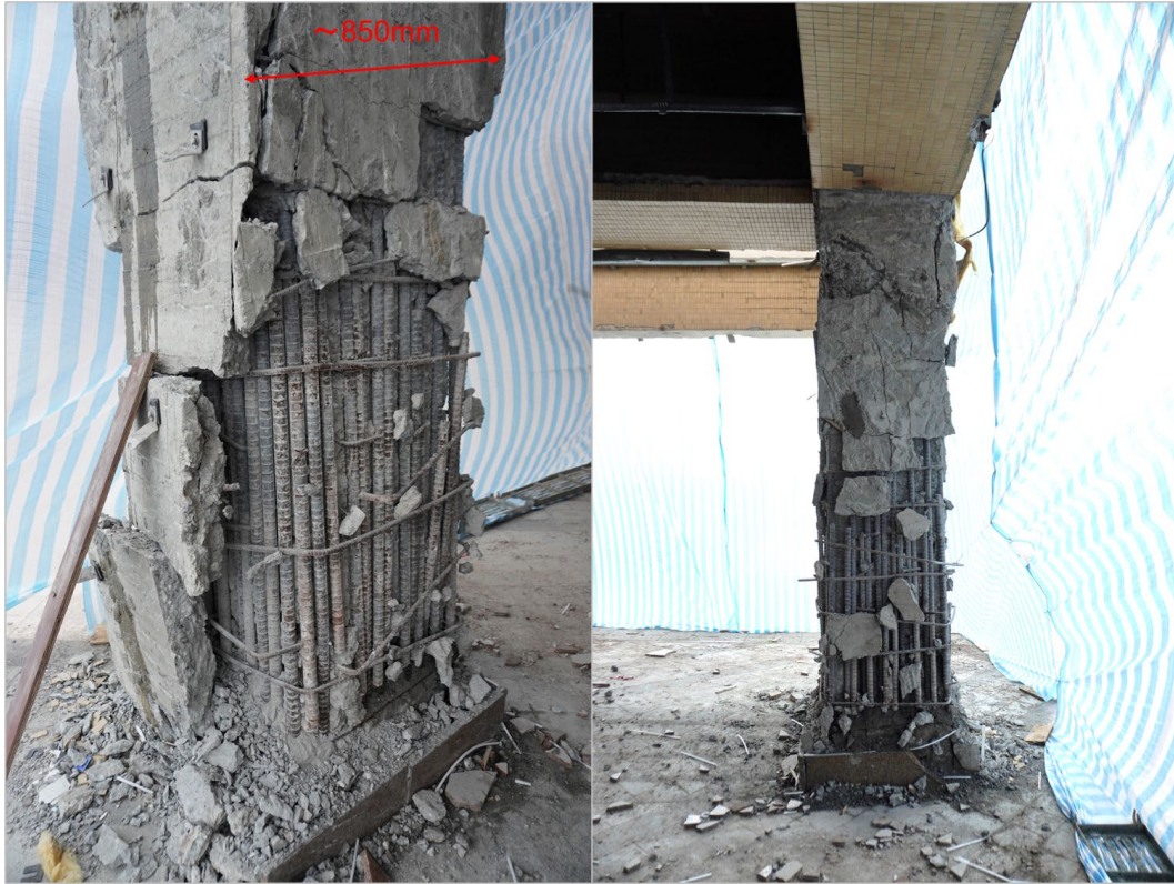
RCコーナー柱のせん断破壊
