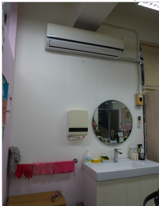
校舎 2: 増設袖壁と柱の境界の縦ひび割れ
