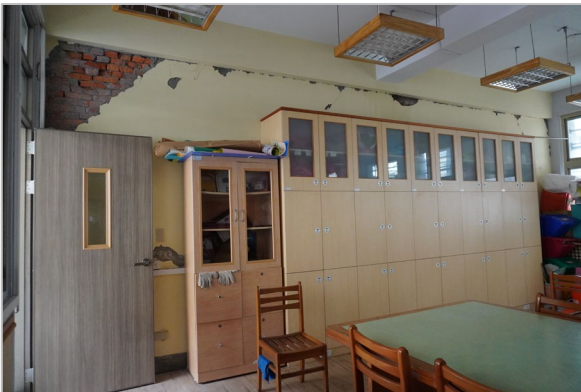
校舎 1: レンガ壁と梁境界のスリップ
