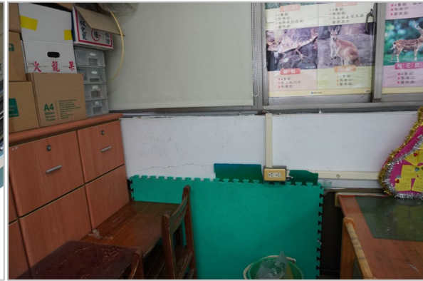
校舎 1: 腰壁に横方向のひび割れ
