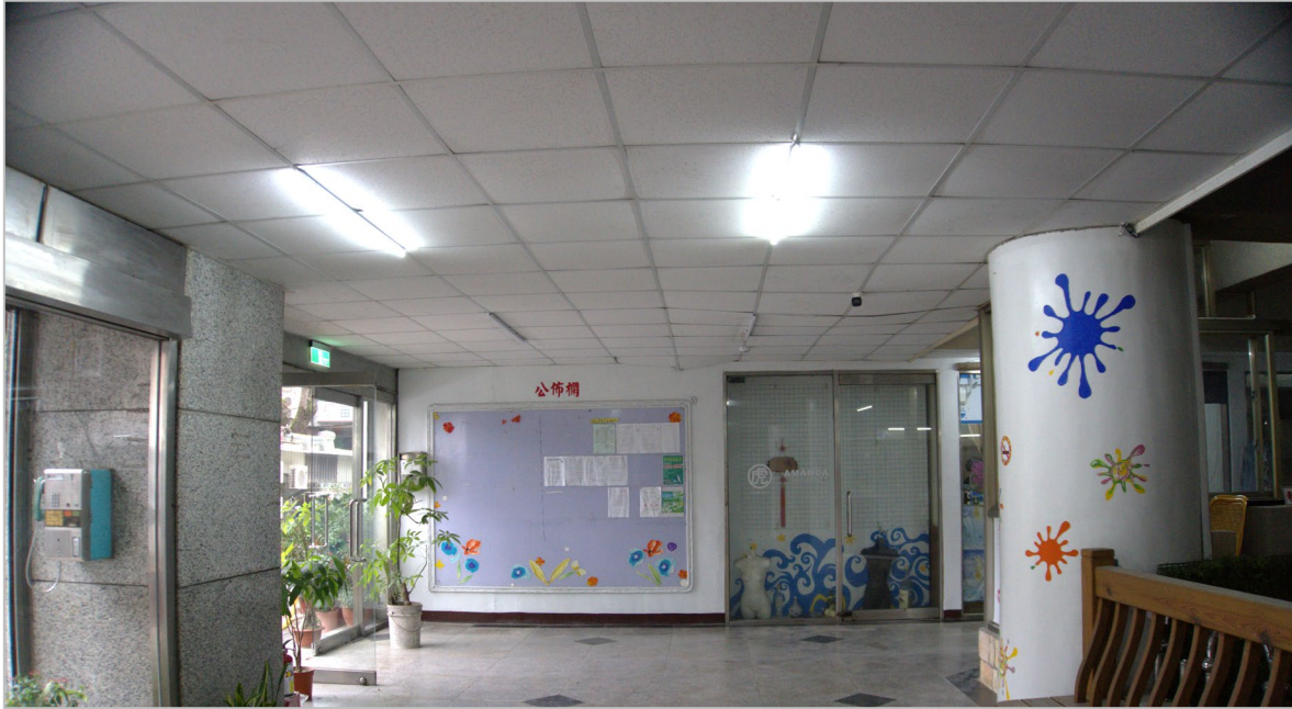
天井板の歪み
