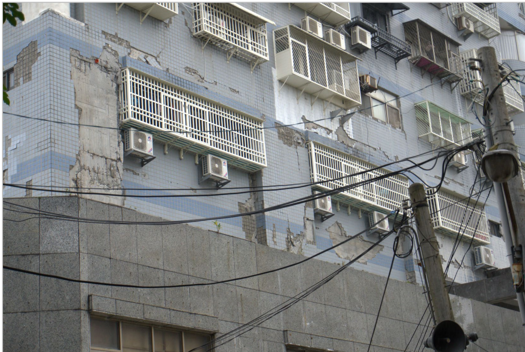
外壁の損傷: 外壁タイルが剥がれ、所々鉄筋が露出
