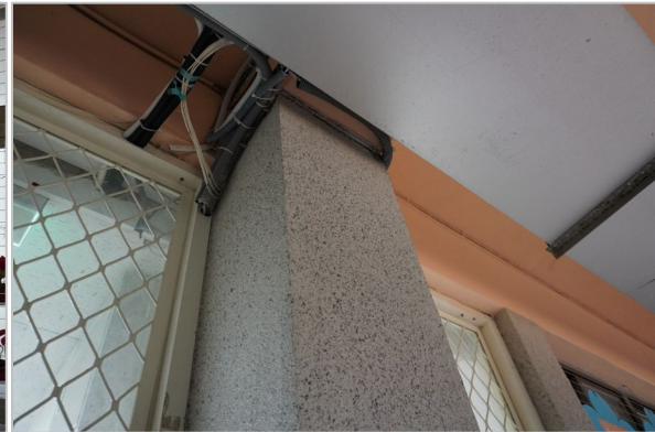
校舎 2: 袖壁増設が無い柱の曲げひび割れ
