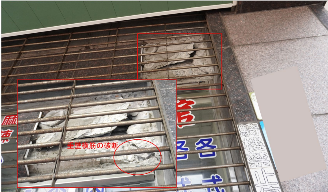
垂壁横筋の破断
