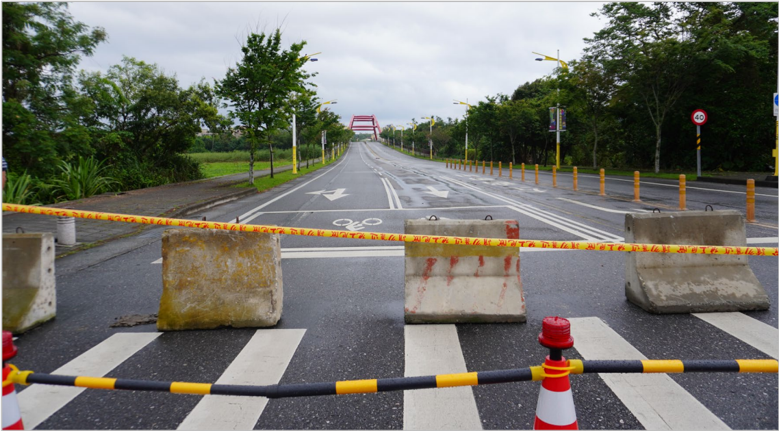
橋への進入道路は通行止め Figure 30 橋梁 H17 の被害状況
