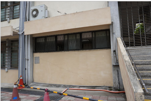
校舎 1 腰壁のせん断ひび割れ
