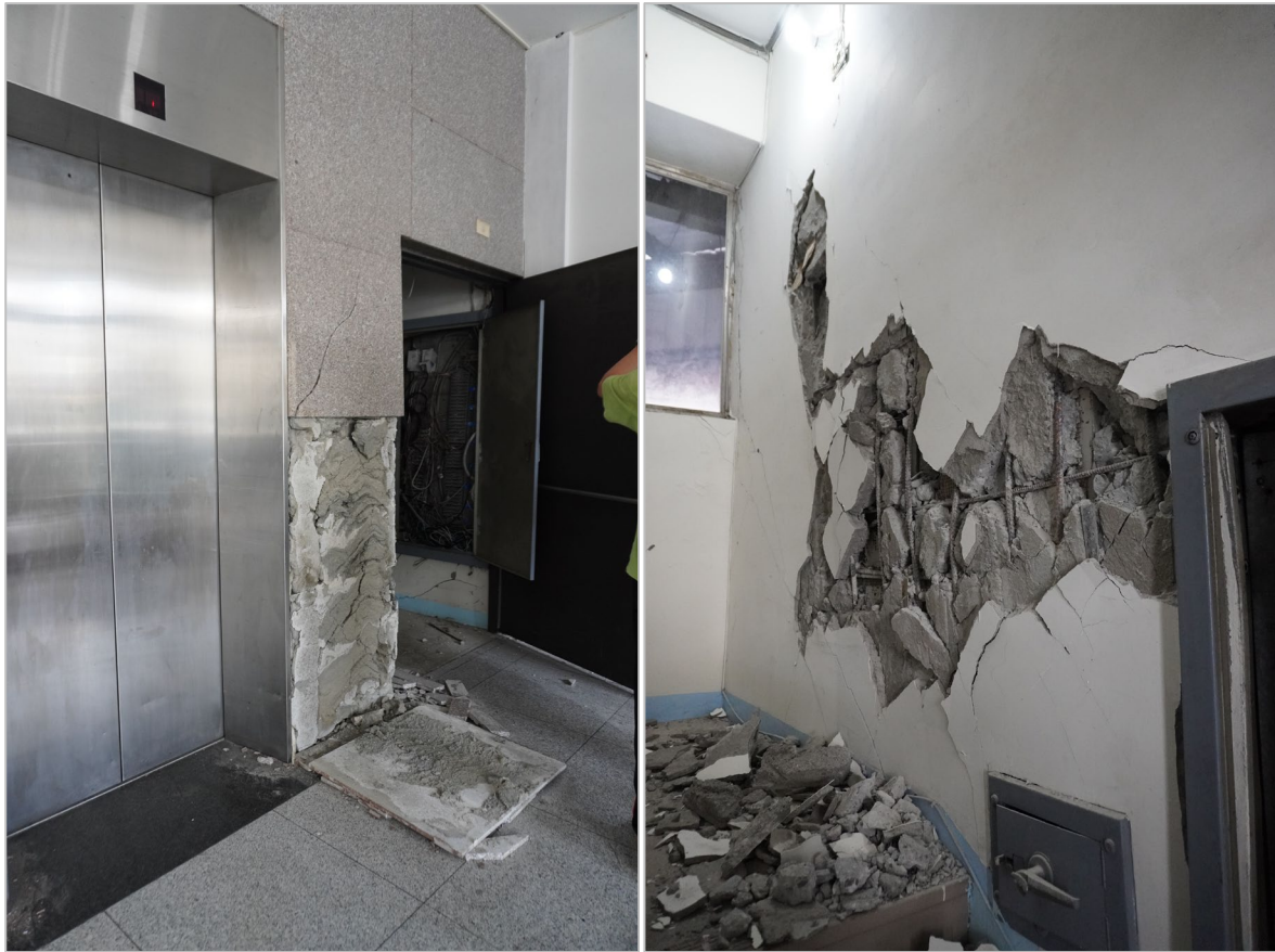
建物南側の棟内の被害 Figure 43 建物 J2 の被害状況
