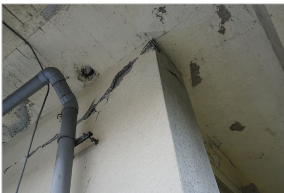
校舎 3:接合部せん断ひび割れ (この柱は袖壁補強が無い)
