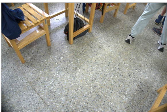
校舎2:床のひび割れ
