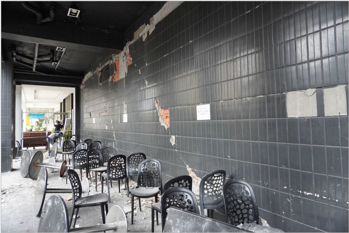
レンガ壁のせん断破壊
