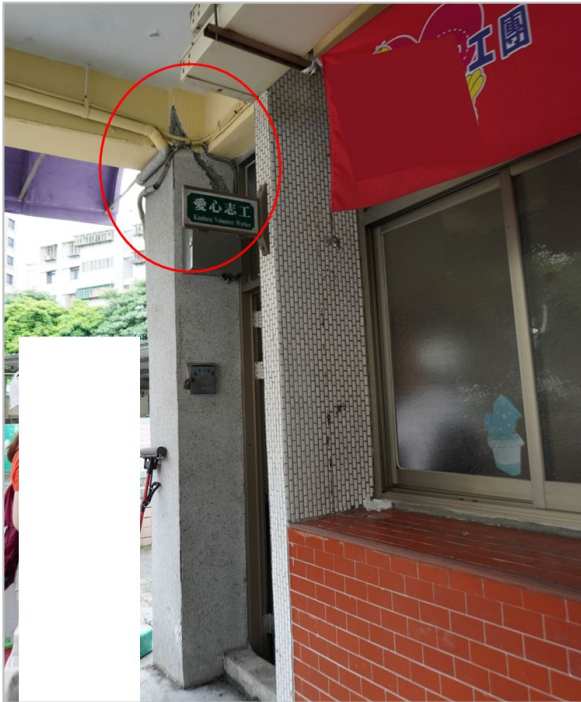
校舎 1: 柱頭せん断破壊
