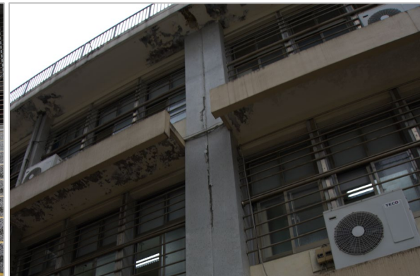
校舎 1: 棟境界の亀裂(隙間がほとんどない)
