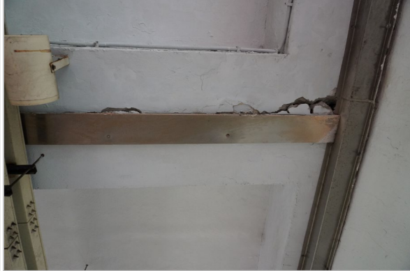
校舎 3: Exp.J の損傷
