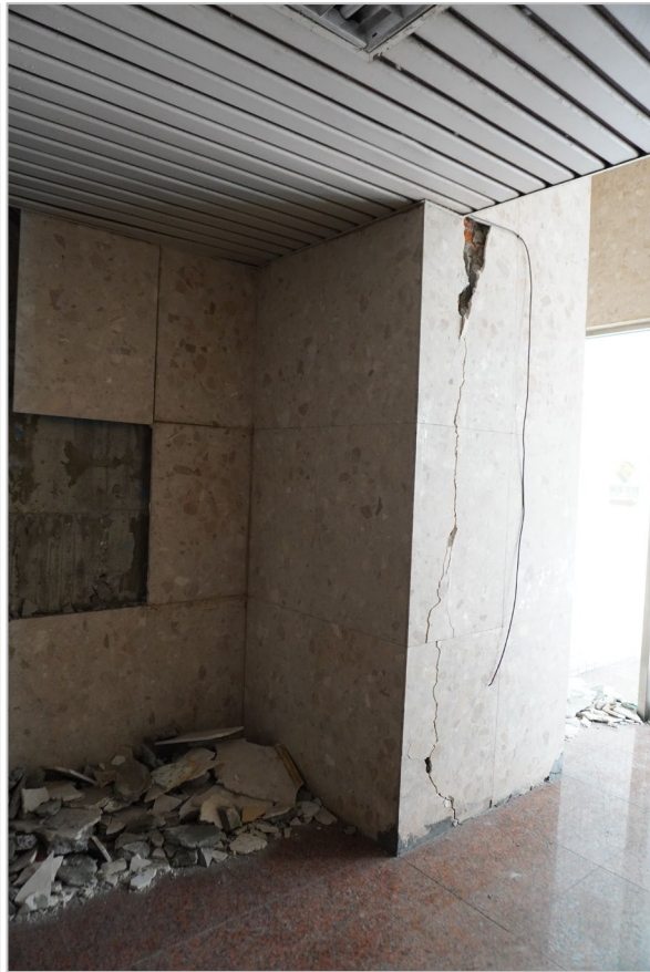
南棟エントランスの被害
