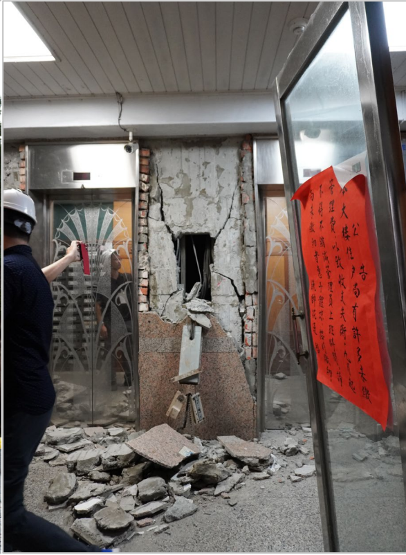
エレベーター間の雑壁の損傷
