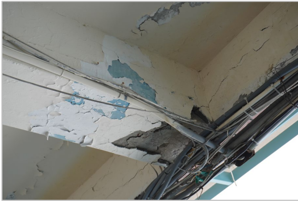
校舎 1: 片持ち梁端部の損傷
