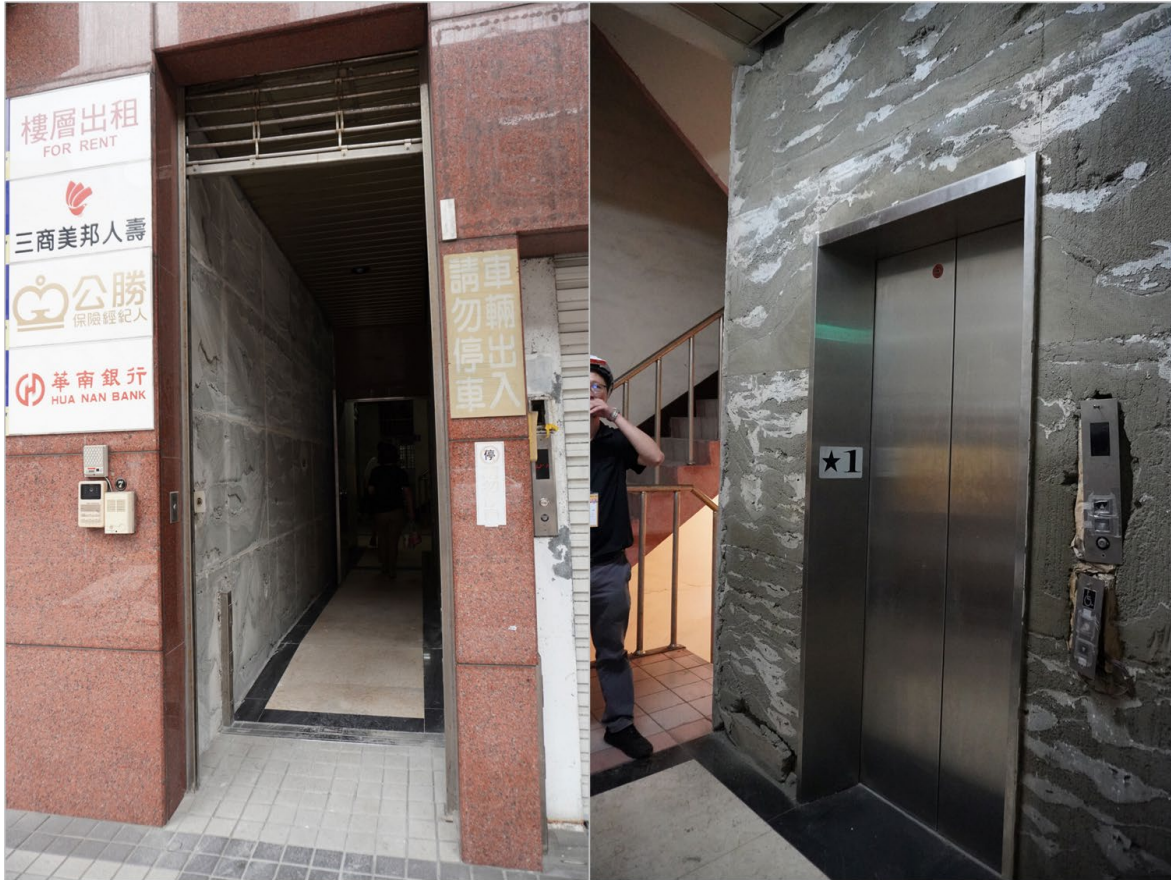
内装パネルが撤去された跡
