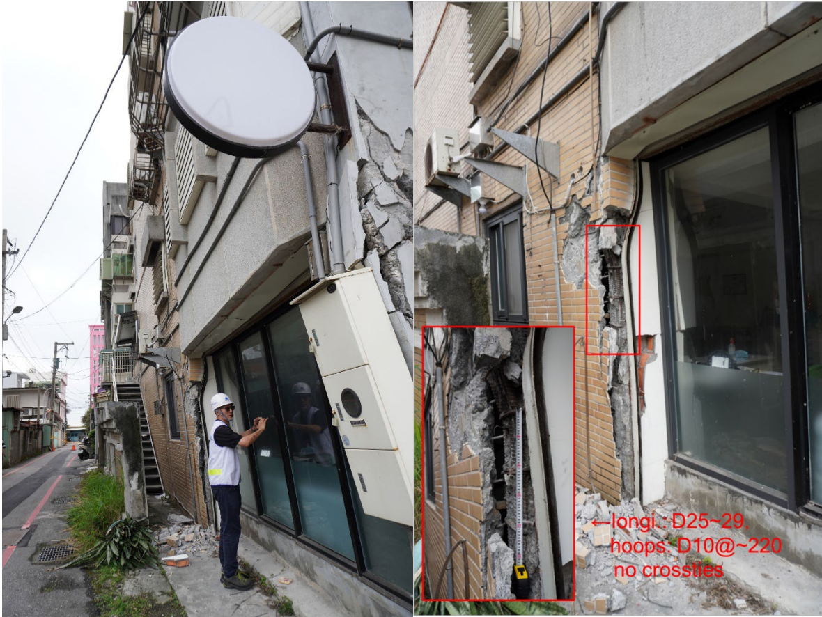
(d) 1階の大きな残留変形
