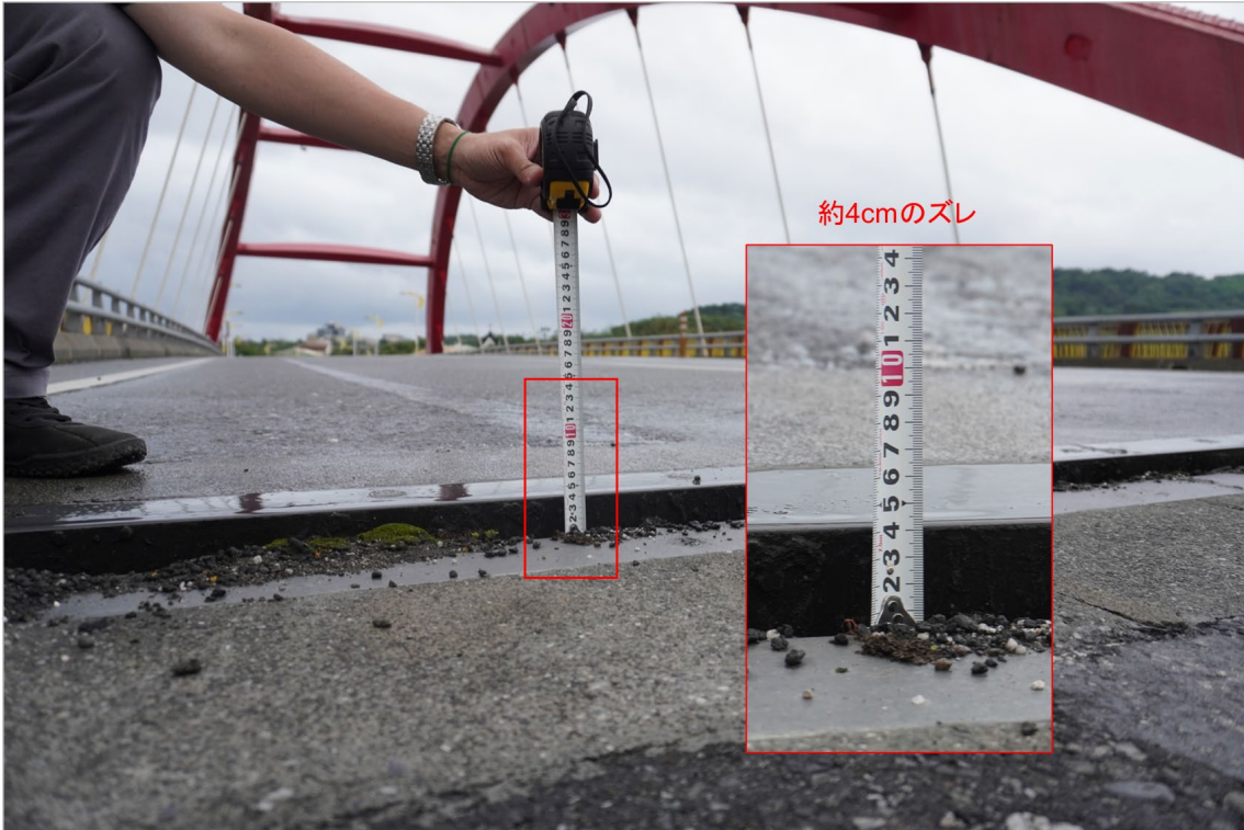
橋桁境界の段差
