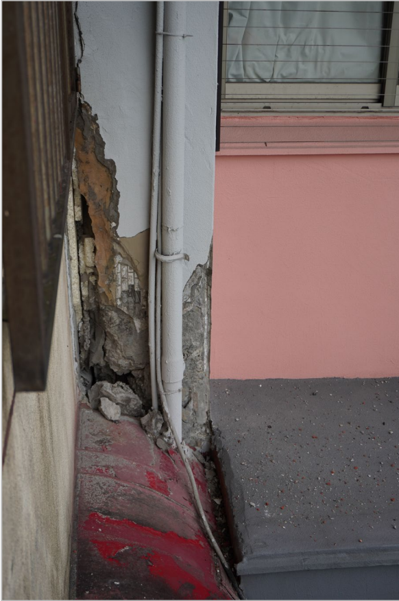
Exp.J 横の柱の損傷(左:校舎 3, 右校舎 2)
