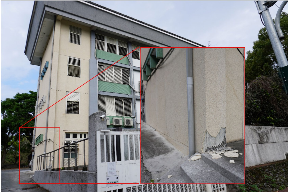
Figure 35 建物 H20 の損傷状況 (校舎北西コーナー)
