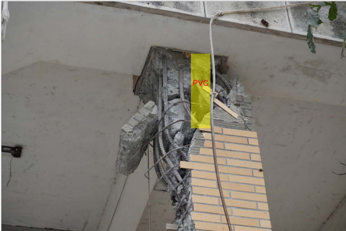
(a)柱頭の破壊, 柱コア内に PVC パイプが埋め込まれている
