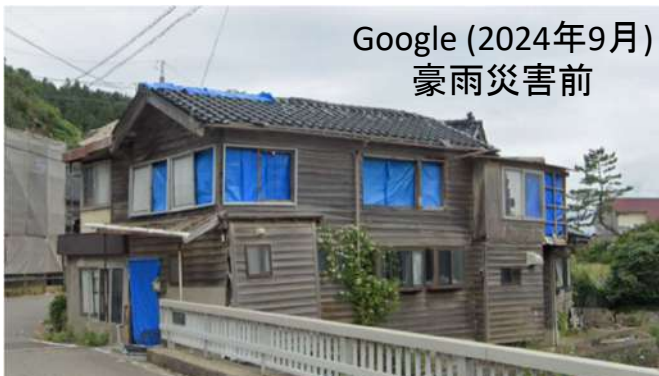
豪雨災害前の非常に古い木造住宅。 地震により被災(南志見川沿い)
