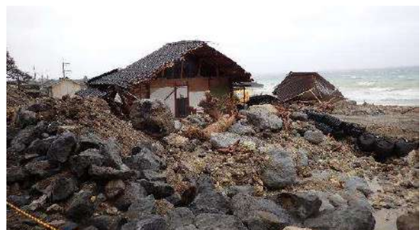
土石流による巨大な岩塊と土砂で分断され、流失した古い木造建物。2階建てだが、1階は土砂に埋没
