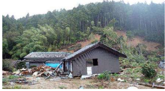
能登半島地震で崩落した斜面が、豪雨でさらに崩壊し、建物を倒壊させた
