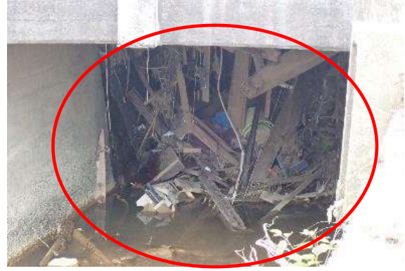
左写真の橋に流木と瓦礫が堆積し、河道が閉塞した様子
