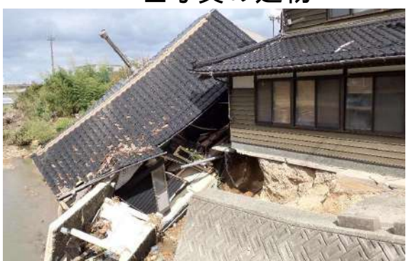
河川浸食により落下した左写真 の建物
