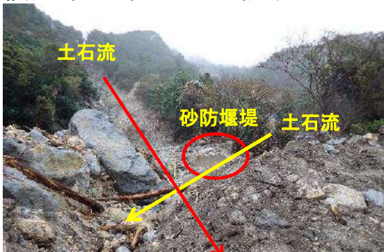
事前に崖崩れの想定は無かったが、地震で一部崩落していた。土石流対策の砂防堰堤があったが、防げなかったと推定
