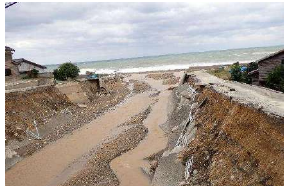
大谷川橋の下流側の大規模な河川浸食 地震による堤防の緩みの影響あり？ 16
