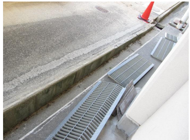
側溝の被害状況
