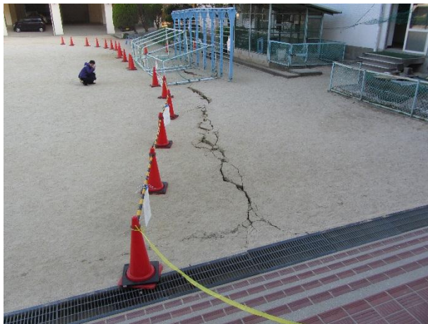
グラウンド東側の地割れ拡大
