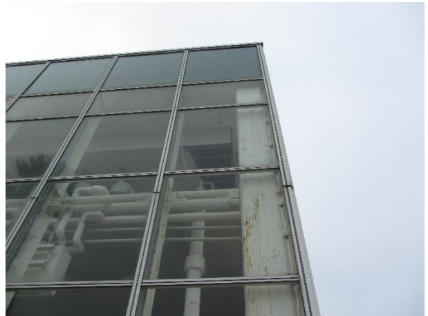
津名温水プール，天井の一部崩落
